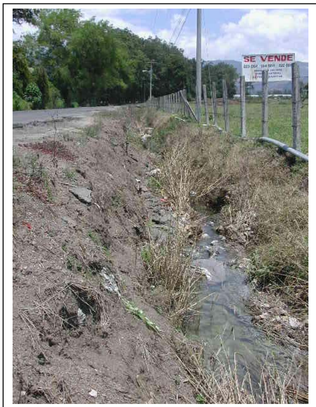
Fotografía tomada en visita del lunes 5 de mayo de 2003 al proyecto de conservación vial de Cartago y Turrialba (I.PCO-15-01)
