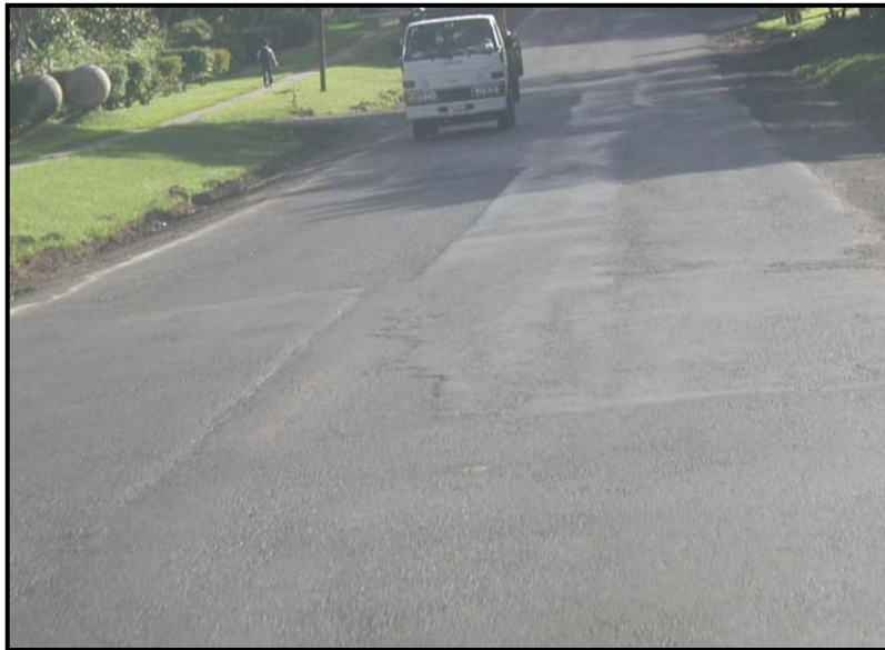
Fotografía 2 Demarcación horizontal inexistente (cubierta por recarpeteo) Tramo: Manolo's – La Garita
