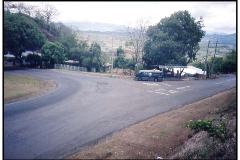
Fotografía 28 Intersección Río Grande Demarcación horizontal deficiente
