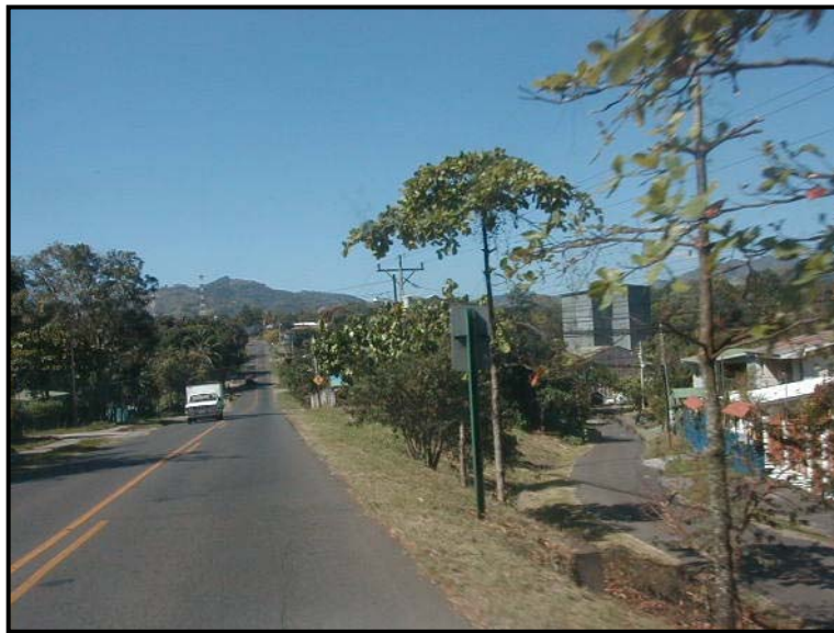
Fotografía 1 Espaldón y línea de borde inexistentes
