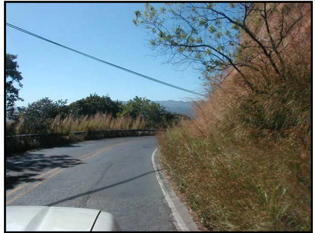
Fotografía 14 Falta de visibilidad debido a la maleza existente al lado de la vía
