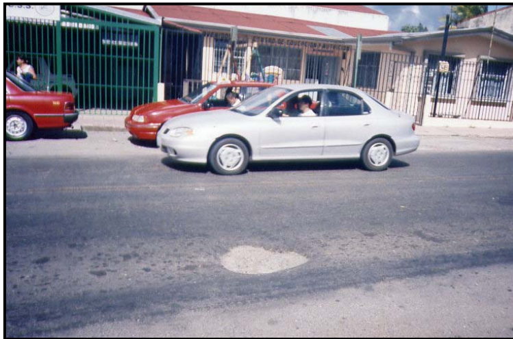
Fotografía 20 Intersección Barrio San José, vía principal Daño en el pavimento
