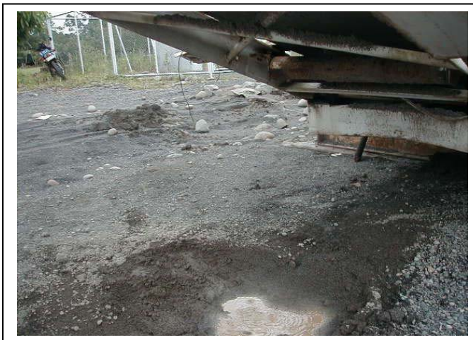
Fotografía No.9 : Escurrimiento excesivo de agua en las tolvas de alimentación de agregados
