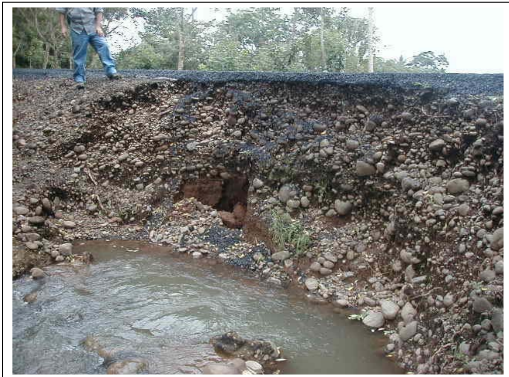
Fotografía No. 1: Estructura para canalización de una quebrada colapsada junto a la carpeta recién colocada.
