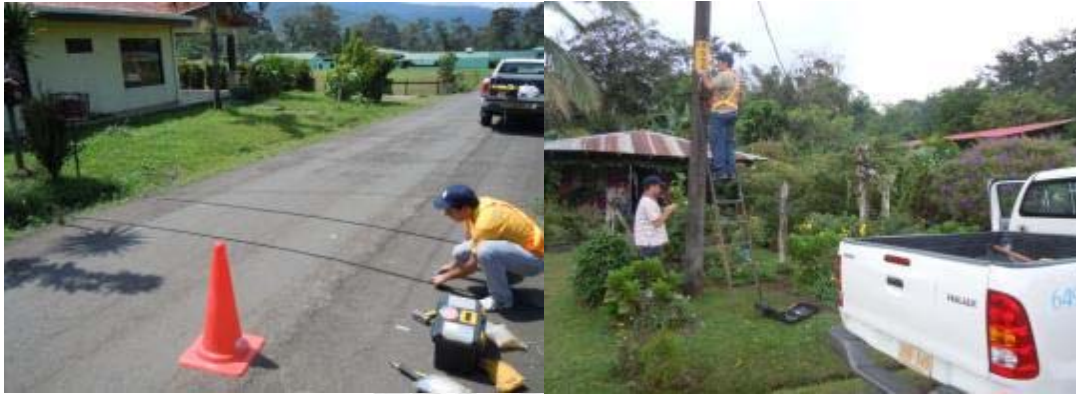
Figura 5. Instalación de contadores de tipo neumático y radar utilizados en Bijagua.
