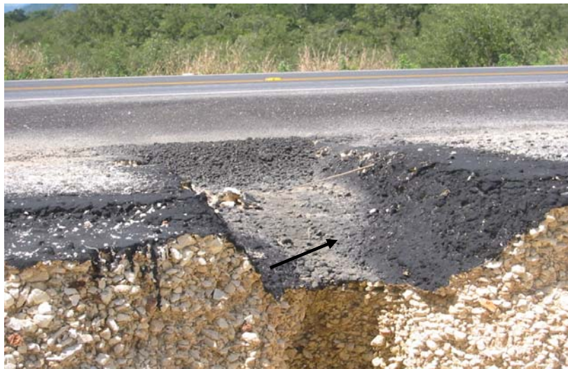
Fotografía No.3 : Daños hechos por el agua.
