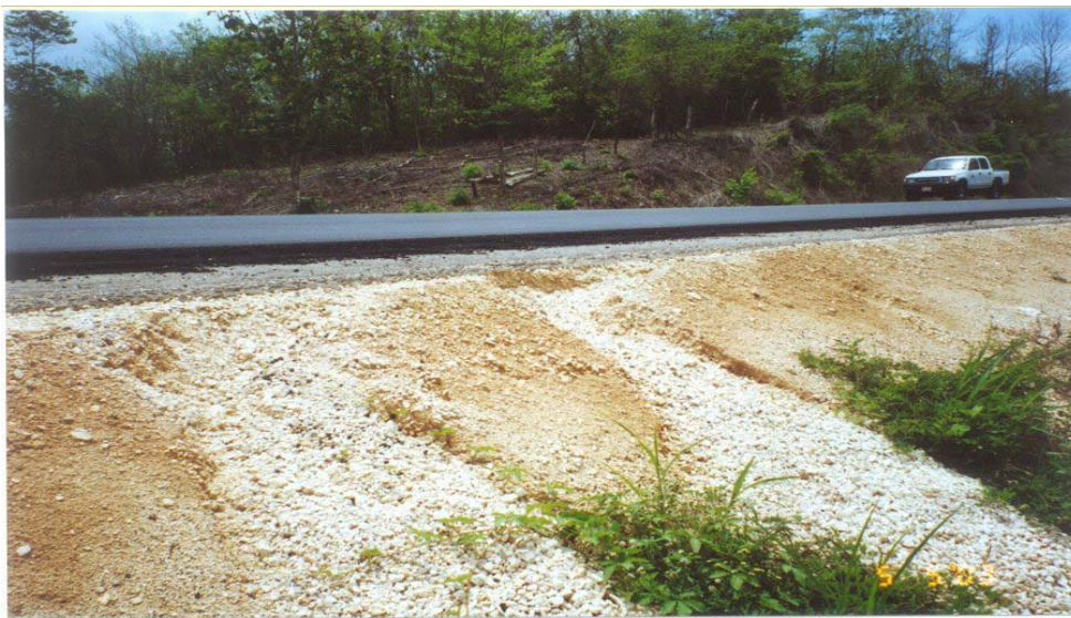
Fotografía No.4: Erosión de taludes.
