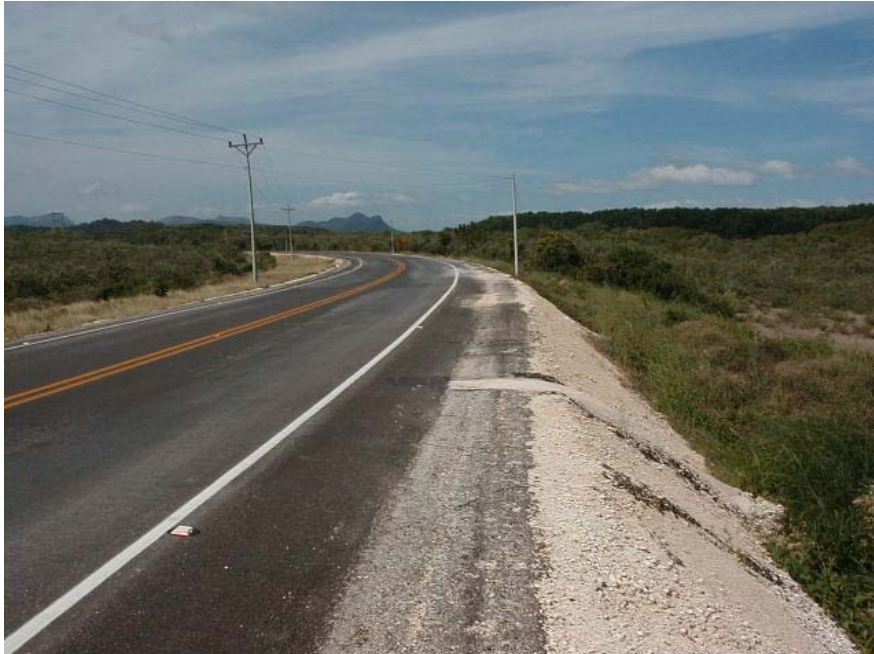
Fotografía No.5: Curva peligrosa sin barrera de contención de vehículos.
