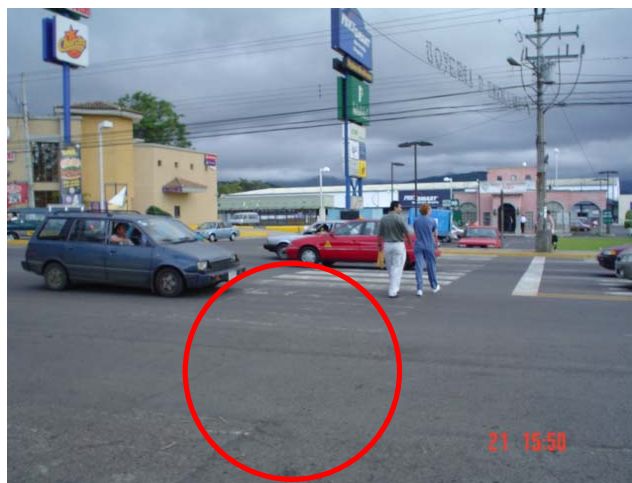
Fotografía 13: El paso peatonal frente al supermercado Price Smart se ha des pintado en gran parte de la vía.
