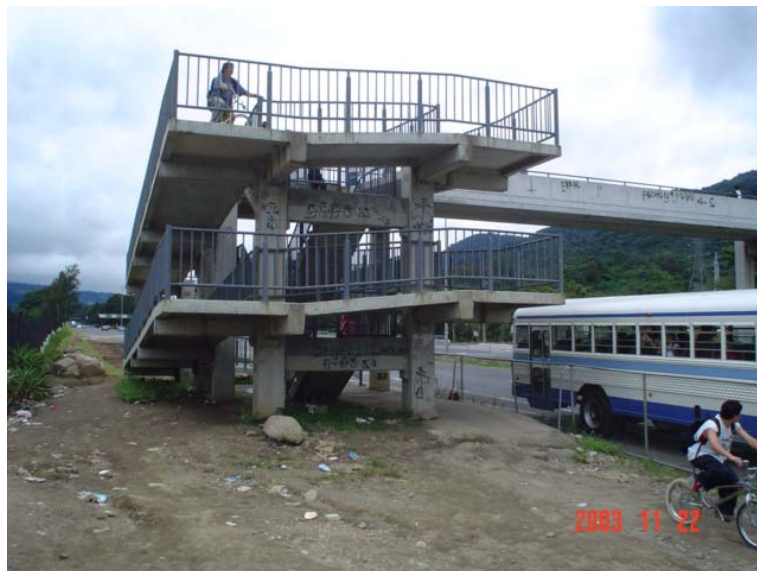
Fotografía 4: El puente peatonal carece de acera y de otras facilidades para el peatón.
