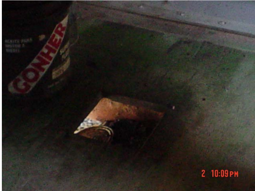
Fotografía 3: Agujero del piso del laboratorio
