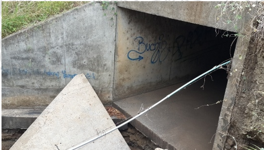
Figura No.4 Aletón de concreto obstruyendo la salida aguas abajo de alcantarilla en Quebrada Mango.
