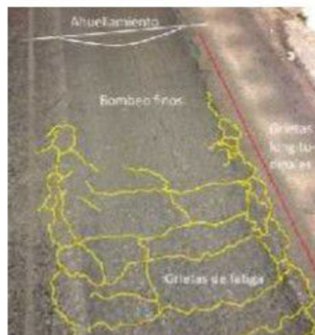
Figura 4. Deterioros en la sección AC2-Húmeda al momento de la falla.
