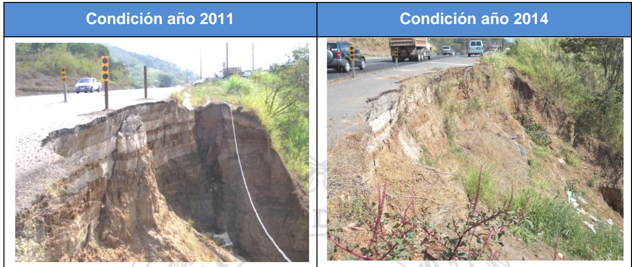
Figura N°4. Avance del deterioro en el costado este del deslizamiento entre los años 2011 y 2014.
