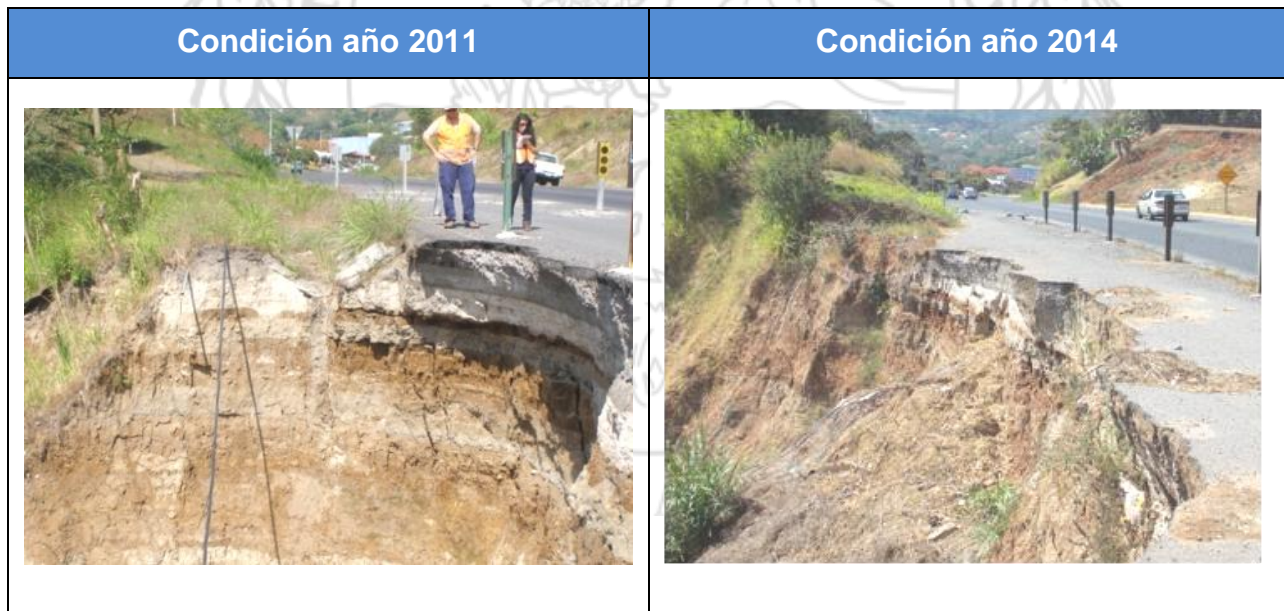
Figura N°5. Avance del deterioro en el costado oeste del deslizamiento entre los años 2011 y 2014.
