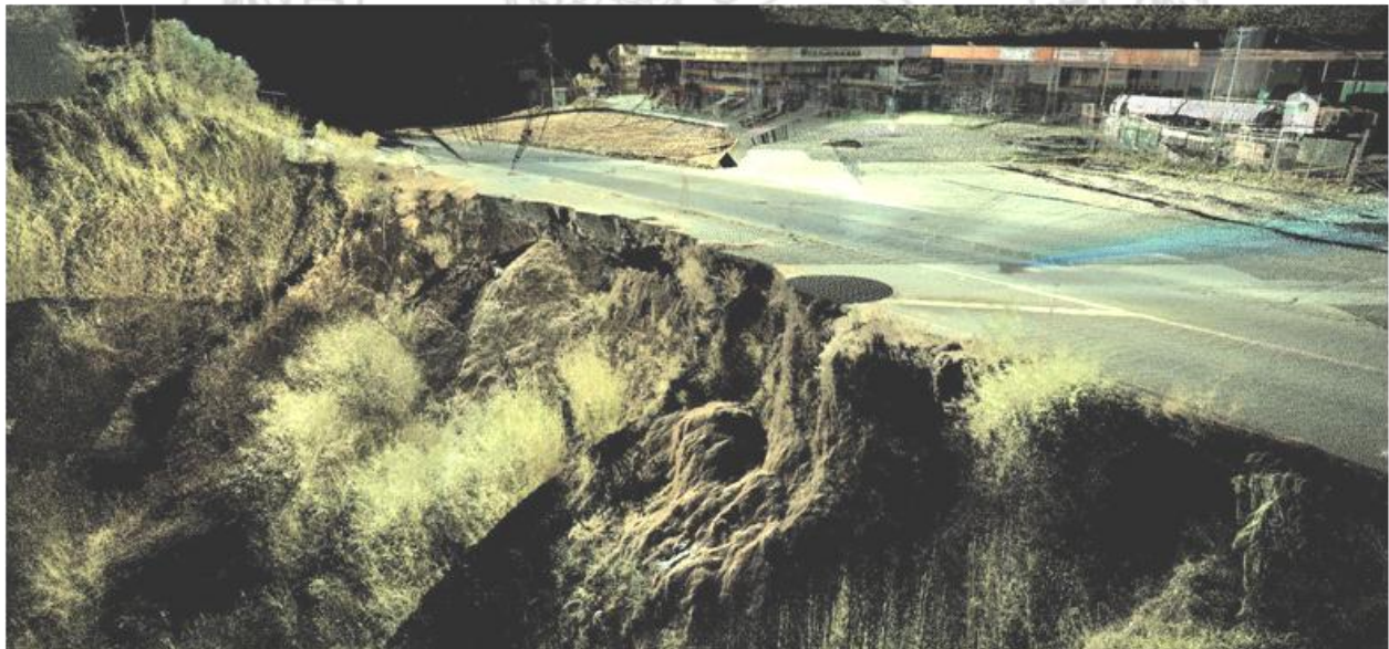
Figura N°6. Vista del costado oeste del deslizamiento en el PK 44+400, resultado del escaneo digital realizado. Se observa al fondo la Estación de Servicio Panamericana.
