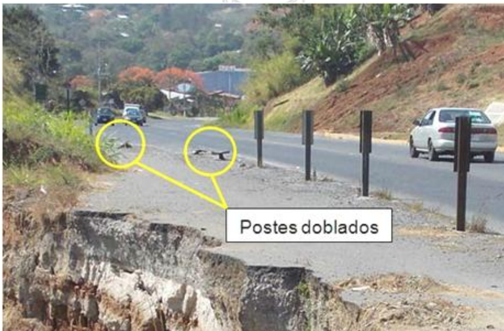
Figura N°11. Deterioro de las señales de prevención en el sitio del deslizamiento.
