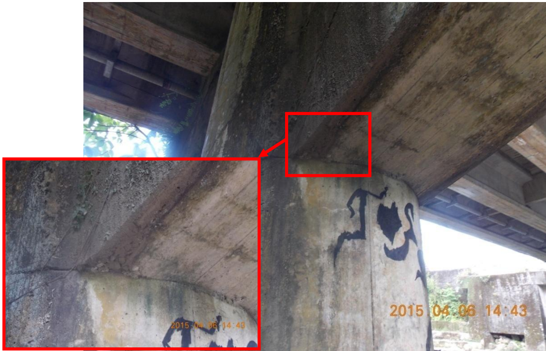
Figura 17. Nido de piedra en intersección entre la viga cabezal y la columna de la pila.
