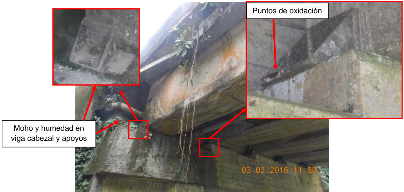
Figura 11. Oxidación puntual y moho en elementos metálicos de los apoyos sobre el bastión 1.
