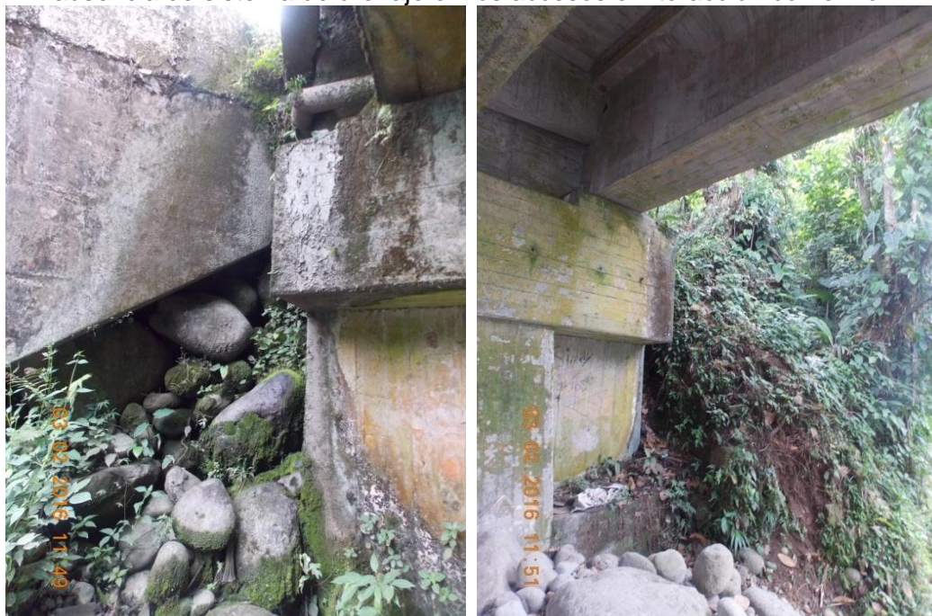
Figura 16. Evidencia de erosión del relleno de aproximación del acceso 1.
