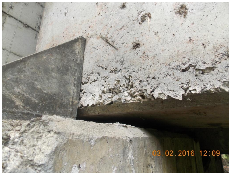
Figura 10. Nidos de piedra en la cara inferior de una de las vigas principales de concreto de la superestructura 2.
