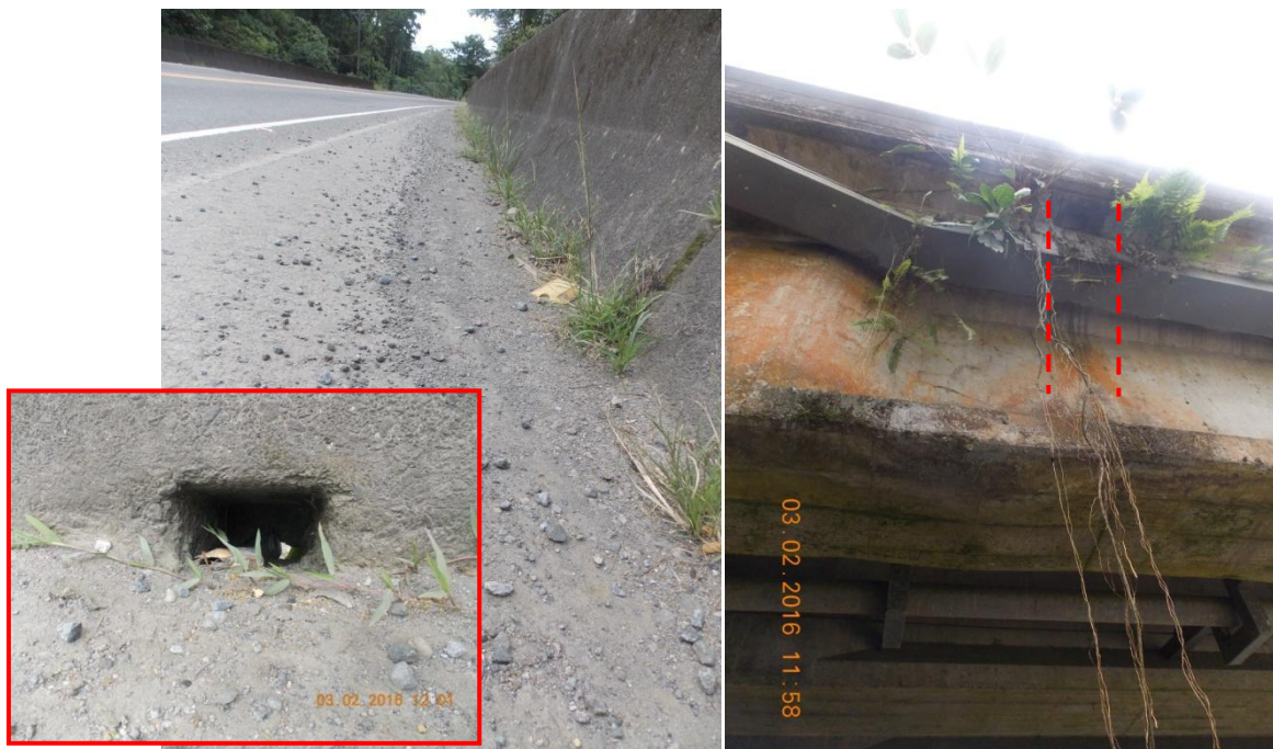
Figura 6. Sedimentos, basura y maleza en intersección entre barrera y losa. Ausencia de tubos de extensión en salidas del sistema de drenaje.
