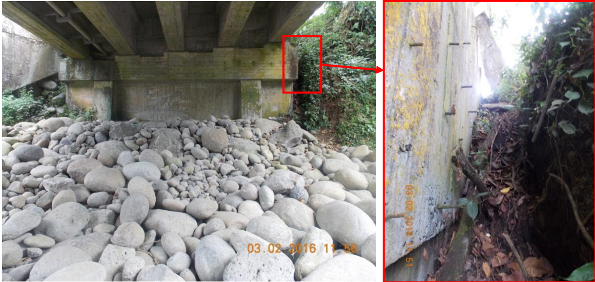
Figura 15. Bastión 1 con protección de rocas sueltas y erosión en extremos debido a la ausencia de sistema de drenaje en los accesos e interacción con el río.
