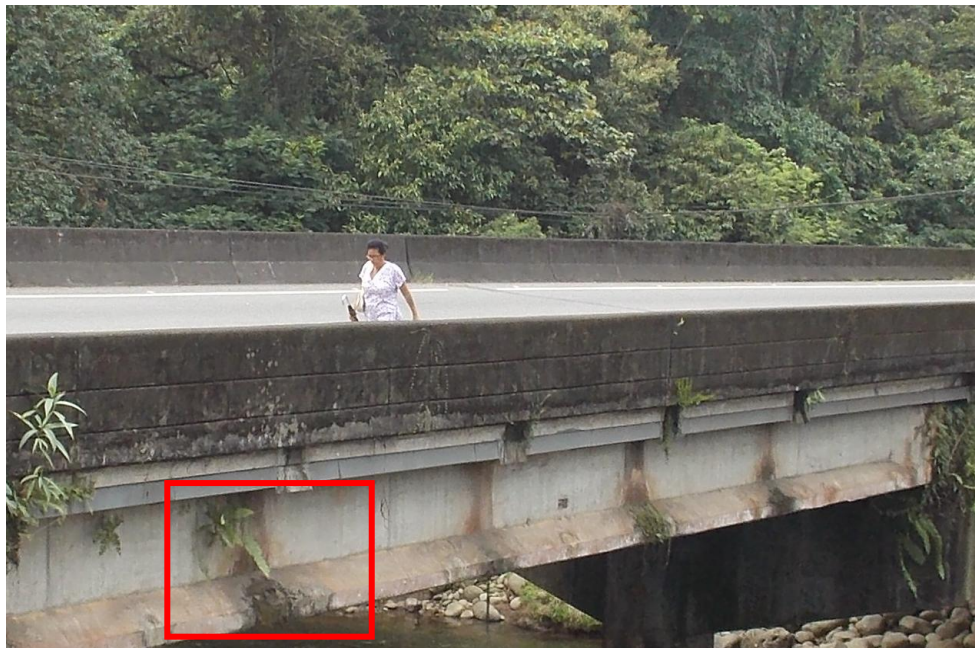
Figura 2. Peatón transitando por el puente y manchas de humedad producto de la ausencia de tubos de extensión en las salidas del sistema de drenaje
