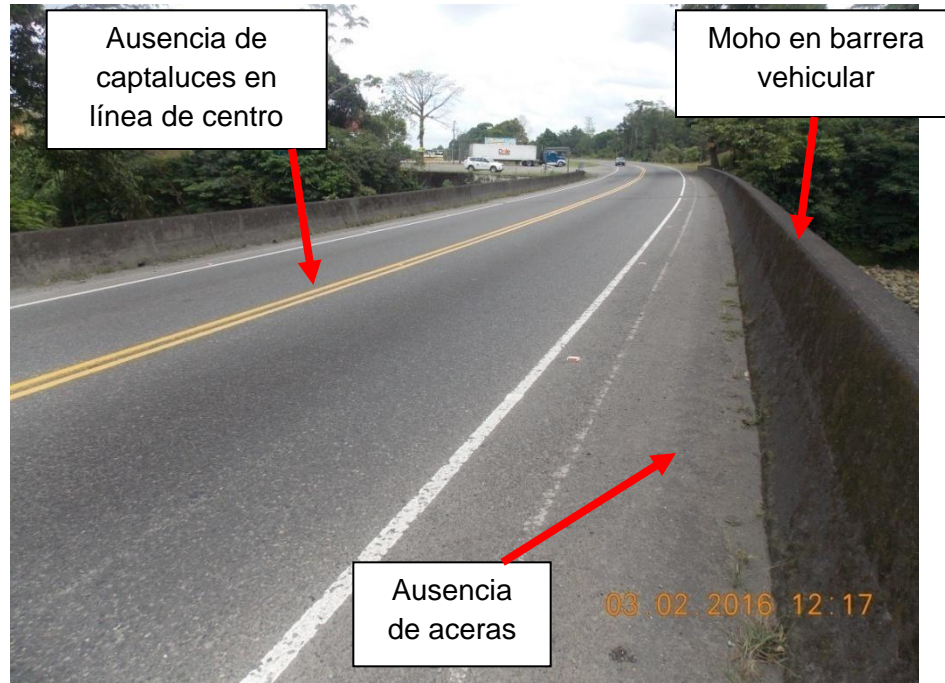
Figura 1. Presencia de moho en la superficie de la barrera, ausencia de captaluces y de aceras
