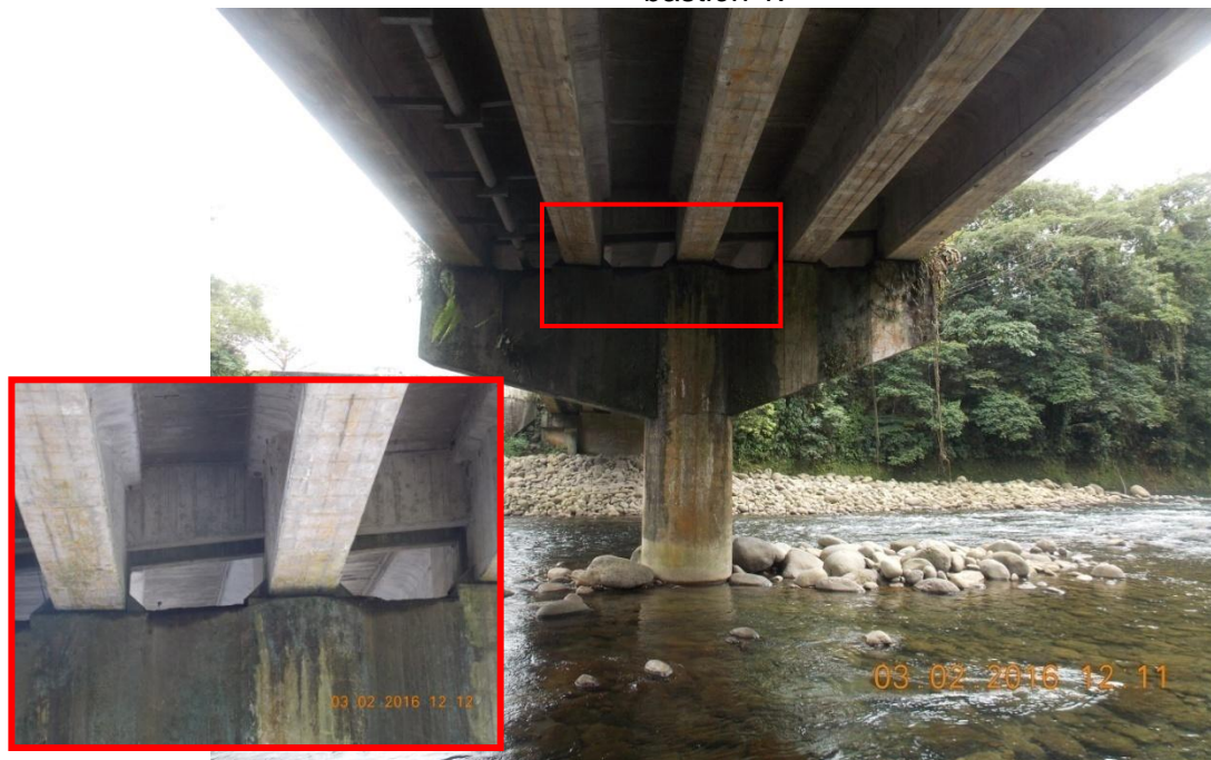
Figura 12. Vista de la pila del puente y humedad en zona de apoyos que ha propiciado el crecimiento de plantas.
