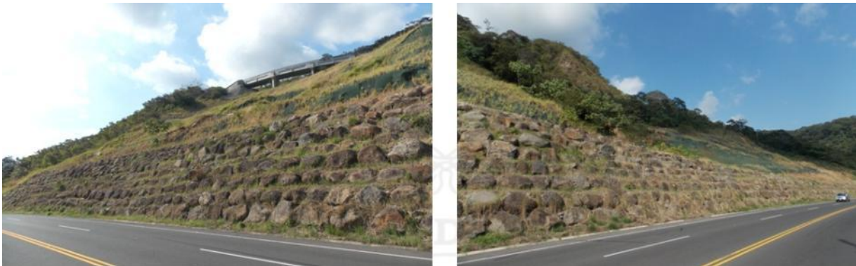
Figura 52 Vistas del talud derecho estacionamiento 47+300. Se aprecia el enrocado, los mantos para control de erosión y el viaducto del tren en la parte superior.
