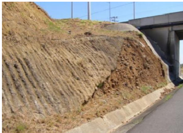
Figura 31 Talud lado derecho, luego de la intersección a Siquiares (sentido San José – Caldera).
