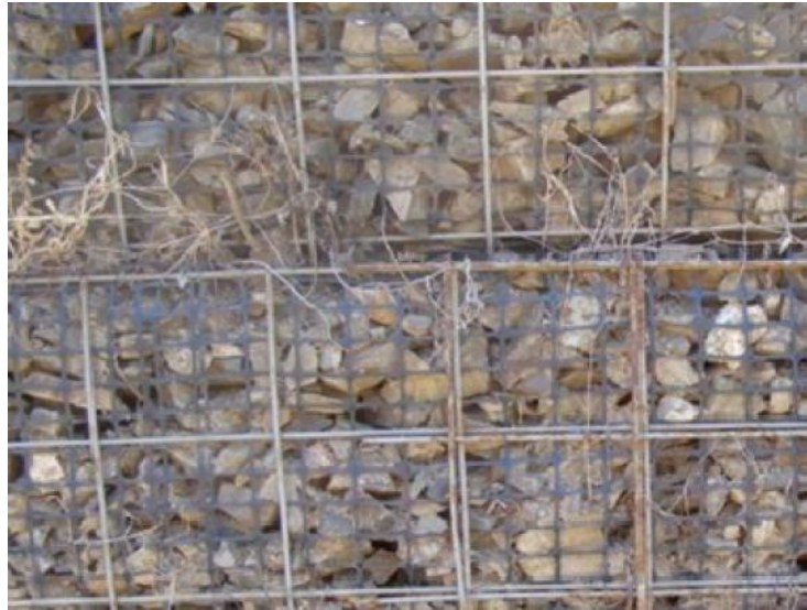
Figura 36 Detalle de la fachada del muro, se observa pérdida de materiales finos.
