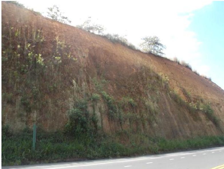
Figura 34 Talud en 30+000 con deterioro en la zona intermedia.
