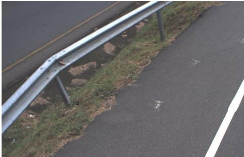
Figura 16 Daños a la barrera, estacionamiento 11+110, sentido San José - Caldera
