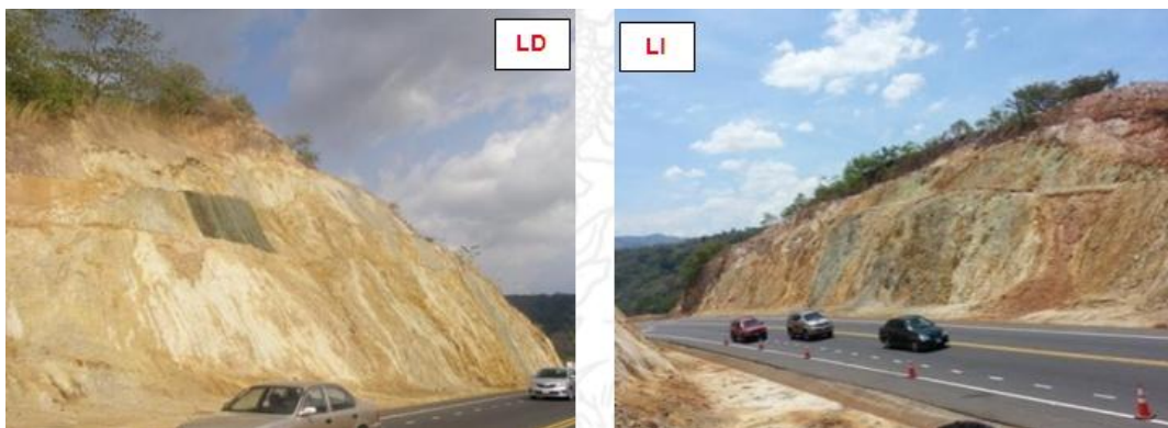
Figura 55 Alteración hidrotermal en los taludes de corte derecho e izquierdo del estacionamiento 48+000
