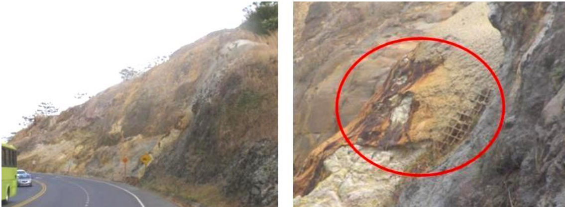
Figura 49 Talud de corte lado izquierdo. En la figura de la derecha se aprecia el deterioro que ha sufrido en varios puntos el concreto y el acero colocados en este talud.
