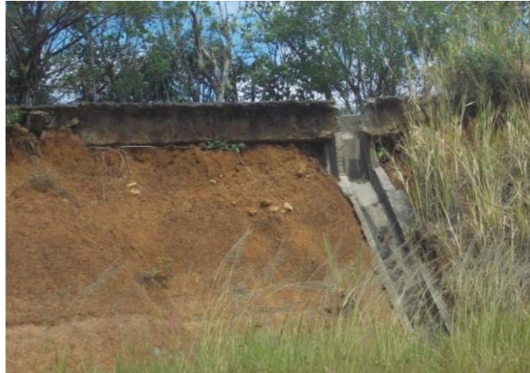
Figura 29 Deterioro en el soporte del sistema de drenaje.
