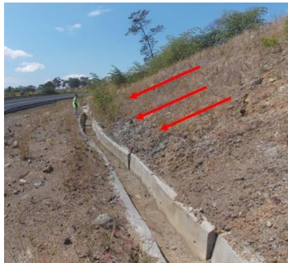
Figura 38 Detalle del desplazamiento de la cuneta producto del movimiento del talud.
