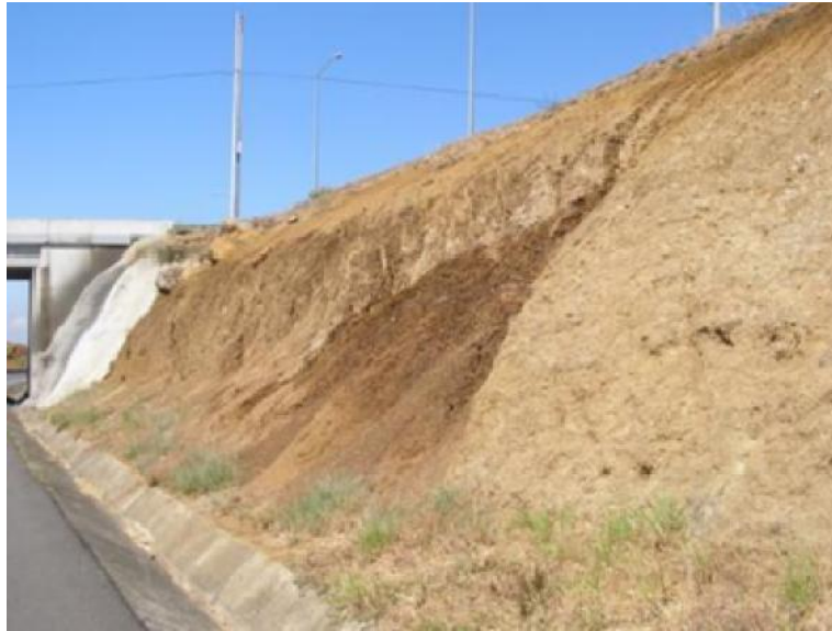
Figura 30 Talud lado derecho, antes de la intersección a Siquiares (sentido San José – Caldera).
