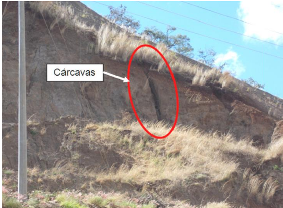
Figura 61 Cárcavas y deterioro superficial presente en el talud de corte lado izquierdo, Radial Atenas.
