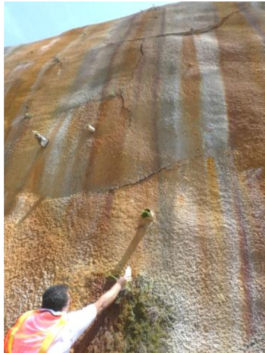
Figura 43 Toma de muestra de agua de drenaje de talud alterado y detalle de grietas en el talud.
