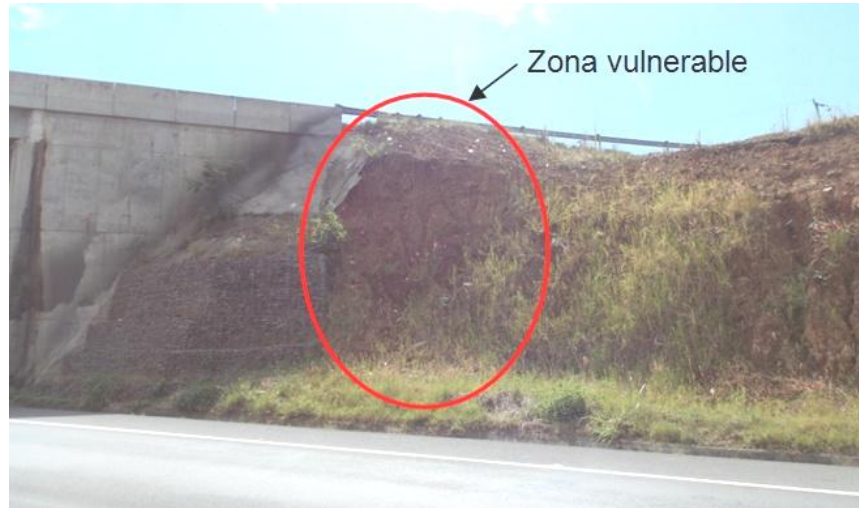
Figura 27 Zona vulnerable en el talud del kilómetro 21+400.
