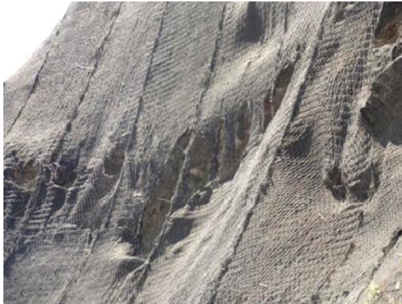
Figura 40 Detalle del deterioro en la cubierta de protección, zona media del talud.
