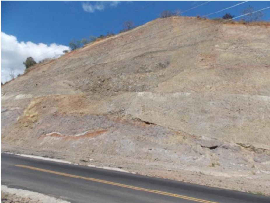
Figura 60 Talud de corte lado derecho en la Radial Atenas.
