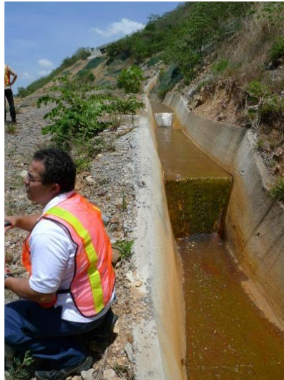
Figura 53 Sitio donde se tomó una muestra de agua en uno de los drenajes para análisis en el laboratorio de contenido de pH. El resultado de esta muestra fue de 3.36 UpH
