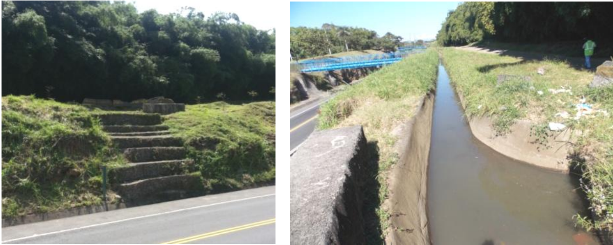
Figura 25 Izquierda: Muro de gaviones sobre el cual se desborda el agua. Derecha: Canal donde se origina el problema
