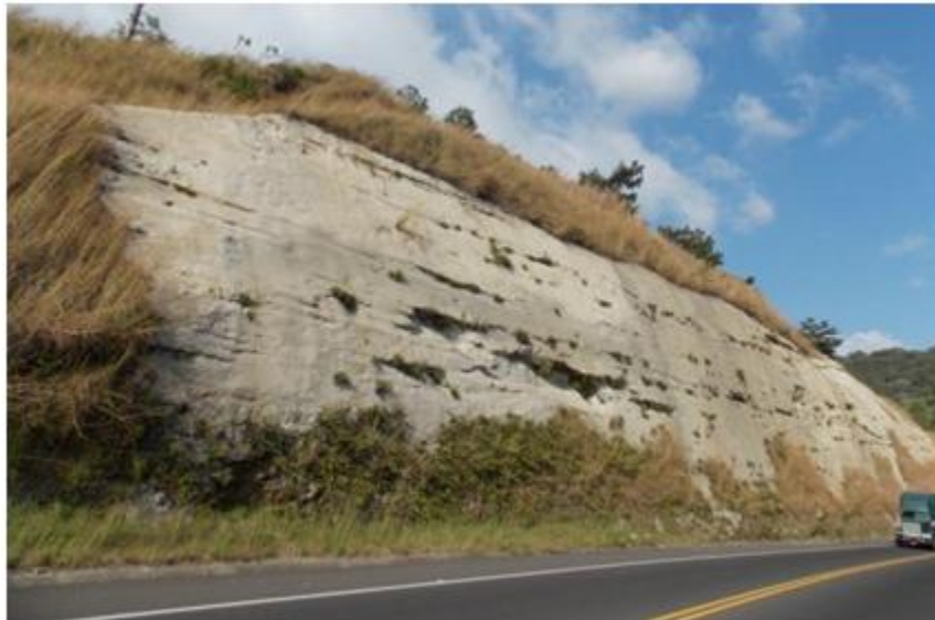
Figura 46 Estratos erosionados en el talud del punto N°6
