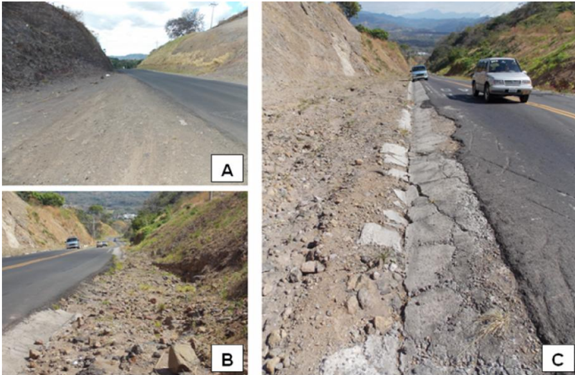
Figura 62 A) y B) Ausencia de cuneta en el costado izquierdo de este tramo de la Radial, sentido Ruta 27 – Atenas. C) Cuneta lateral, señalización horizontal y pavimento deteriorados por el paso de maquinaria pesada en el costado derecho de la Radial Atenas.
