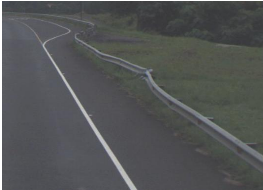
Figura 18 Daños a la barrera, estacionamiento 34+475, sentido Caldera – San José
