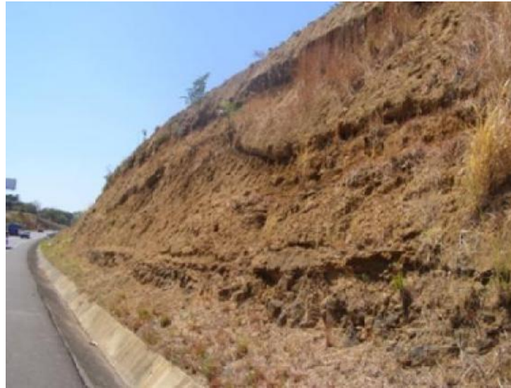
Figura 33 Estratos erosionados en el talud del punto N°6
