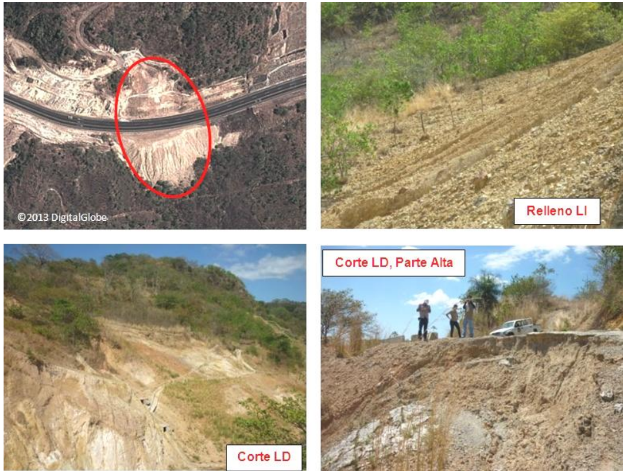
Figura 54 Vistas de los taludes de corte y relleno afectados por la alteración hidrotermal en el estacionamiento 47+800.
