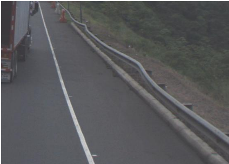
Figura 17 Daños a la barrera, estacionamiento 38+865, sentido Caldera – San José
