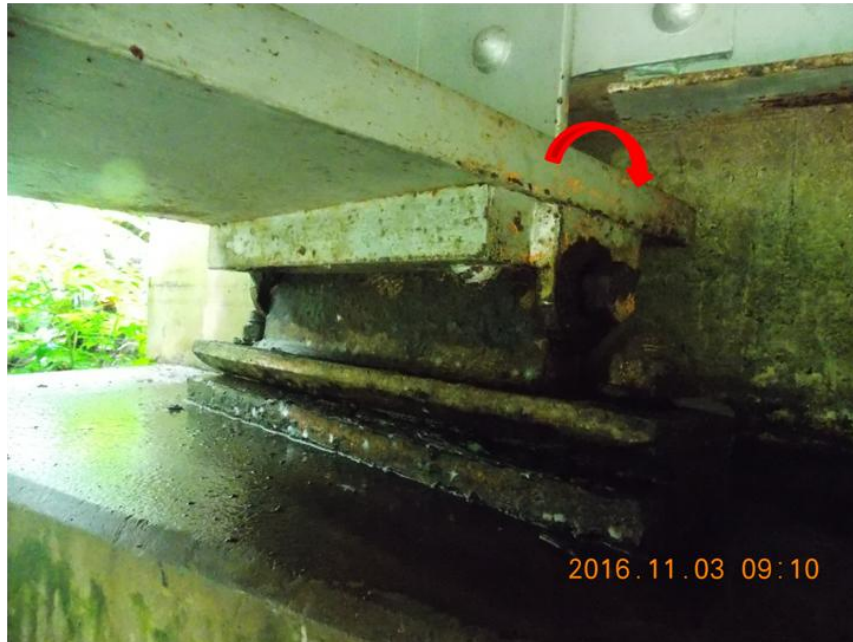
Figura 14. Leve inclinación de los apoyos fuera del eje vertical.
