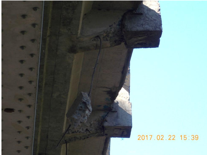
Figura 2. Desprendimientos de concreto en la superficie inferior de la barrera vehicular.
