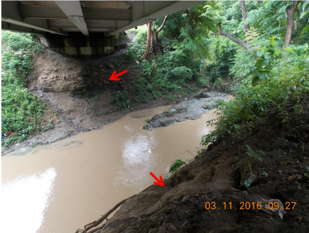
Figura 16. Erosión de los taludes frente a los bastiones.
