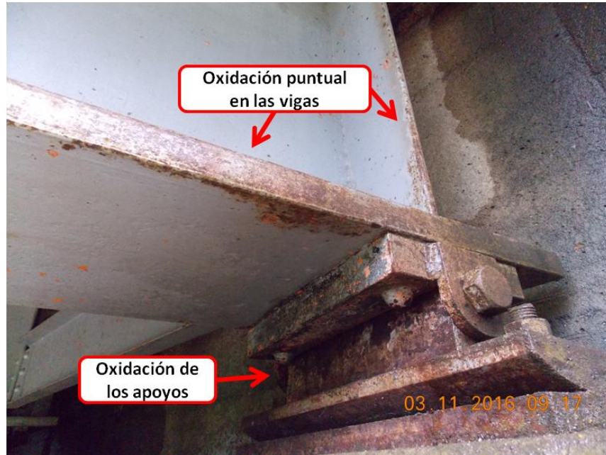
Figura 10. Oxidación puntual de las vigas cerca de los extremos y oxidación generalizada de los apoyos sobre el bastión 1.
