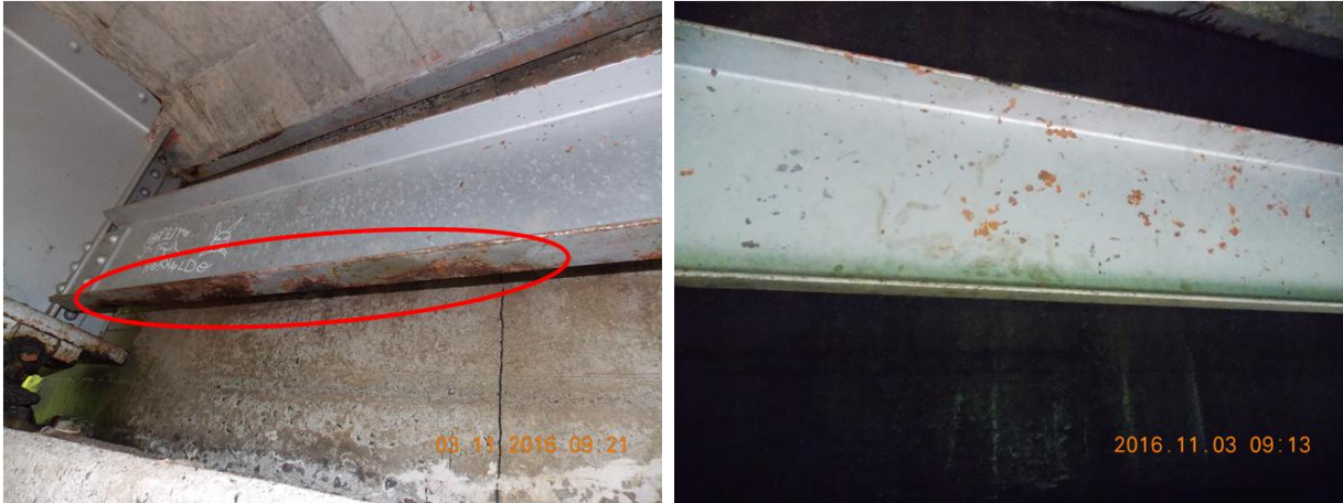
Figura 12. Puntos de oxidación, corrosión y desprendimiento de pintura en vigas diafragma extremas de la superestructura.
