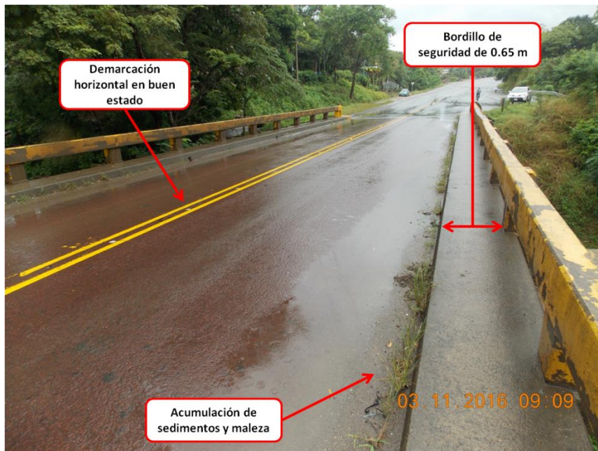
Figura 3. Bordillo de seguridad, acumulación de sedimentos y maleza en las entradas del sistema de drenaje del puente y demarcación horizontal de la línea de centro en buen estado.
