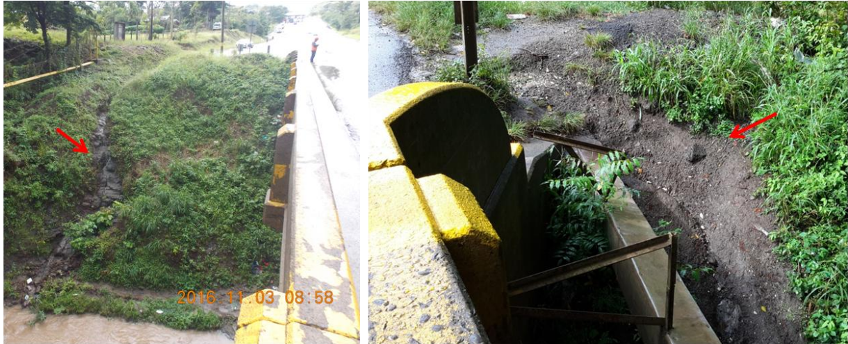
Figura 8. Canales formados por el agua que drena desde la carretera en el relleno de aproximación del acceso 1.
