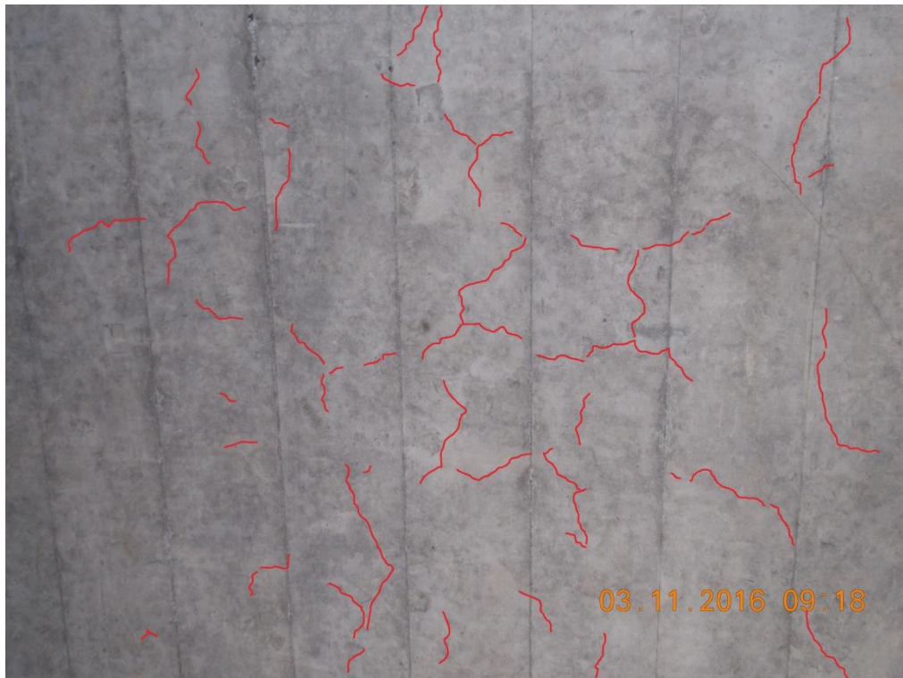
Figura 9. Agrietamiento en la cara inferior de la losa de concreto.
