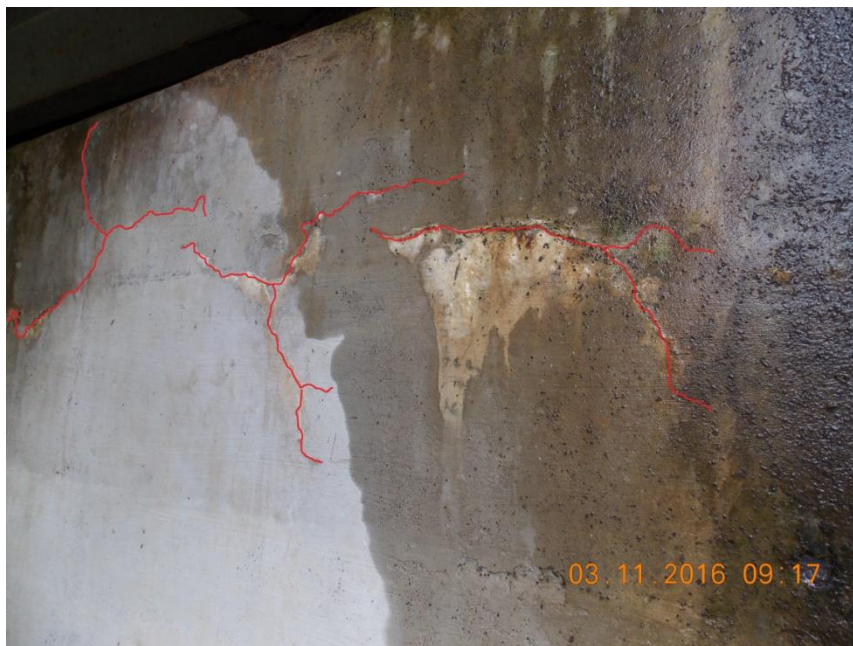
Figura 15. Agrietamiento y eflorescencias en la viga cabezal del bastión 2.
