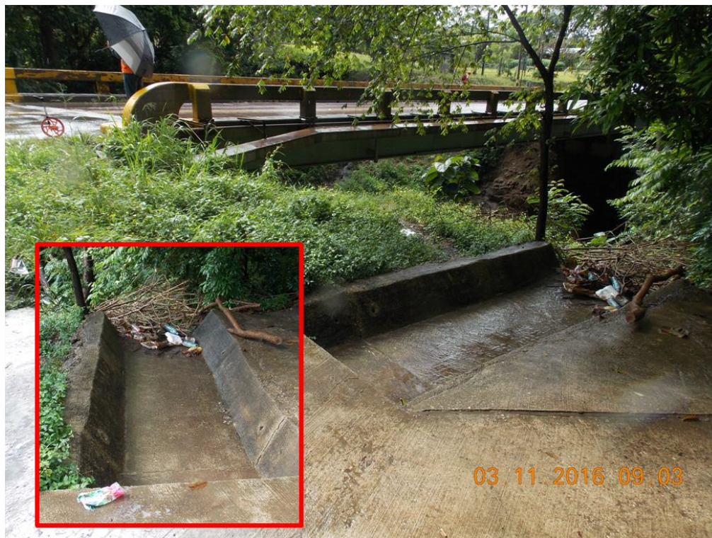
Figura 7. Cuneta de drenaje obstruida por ramas y basura en el acceso 2.
