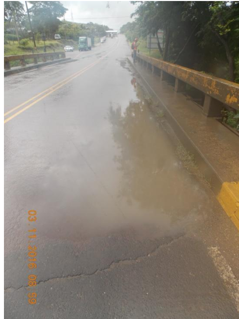
Figura 4. Acumulación de agua en la calzada del puente que evidencia la obstrucción total del sistema de drenaje de la superestructura.
