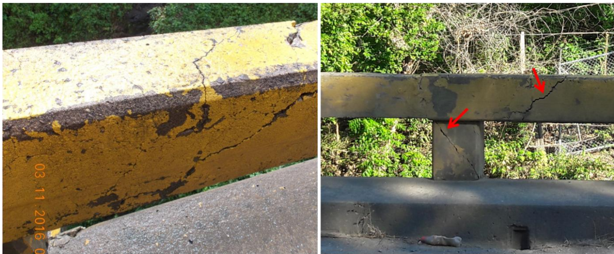
Figura 1. Agrietamiento típico en el sistema de contención vehicular del puente.
