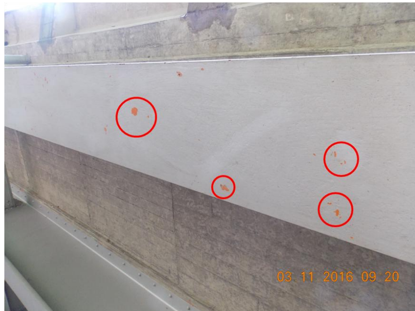
Figura 11. Puntos donde se ha desprendido la capa superficial del sistema de protección de pintura de las vigas.
