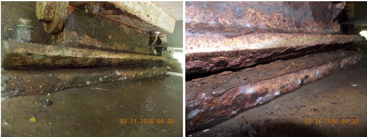
Figura 13. Corrosión severa de apoyos sobre el bastión 2.
