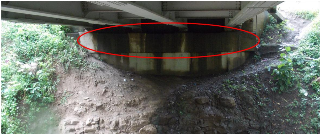
Figura 6. Manchas de humedad en bastión producto del ingreso de agua a través de la junta de expansión.
