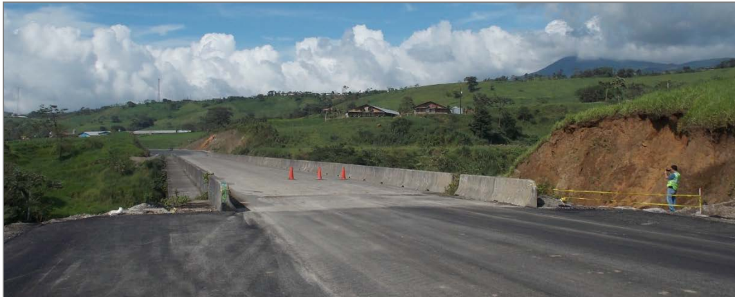
Figura 3. Puente sin señalización. Estación 24+650. Fecha: 19 de agosto de 2015. Fuente: LanammeUCR.
