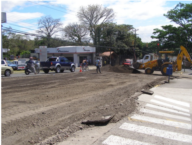
Fotografía 8 . Ausencia de área de prevención transición, de trabajo y terminación establecidos. Fecha 06/02/2012
