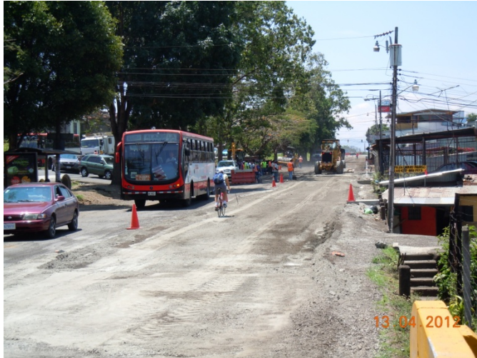
Fotografía 3. Falta de claridad en la definición de los frentes de trabajo Fecha:13/04/2012
