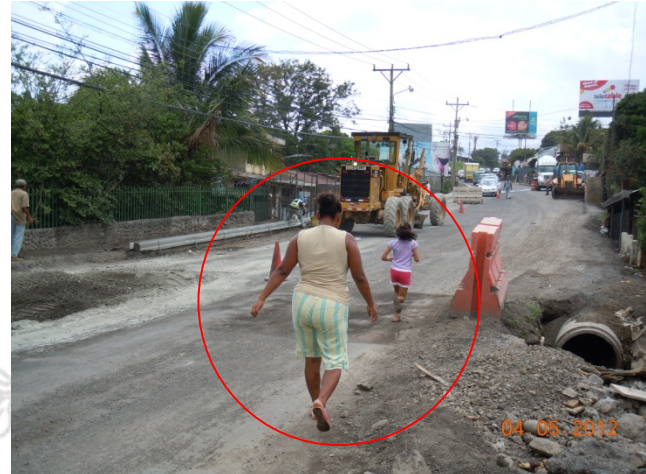
Fotografía 13. Falta de facilidades peatonales, control del tránsito en obra Fecha:04/05/2012
