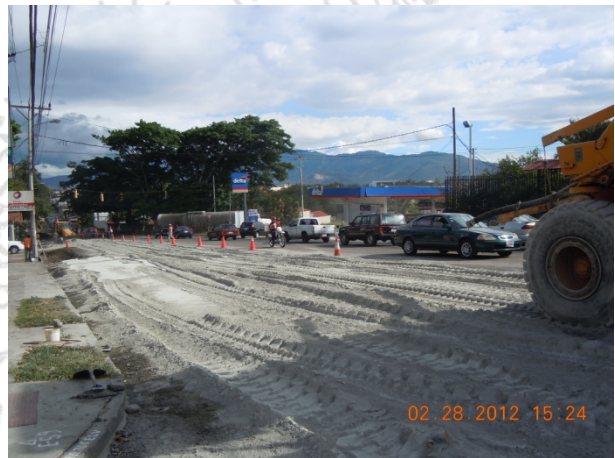
Fotografía 2. Inexistencia de separación entre flujos de tránsito Fecha: 28/02/2012
