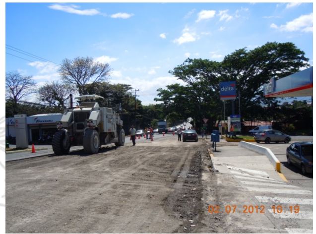
Fotografía 9 . Ausencia de área de prevención transición, de trabajo y terminación establecidos. Fecha 07/02/2012
