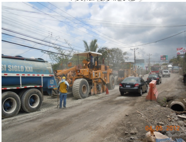
Fotografía 5. Falta de claridad en la definición de los frentes de trabajo Fecha:04/05/2012
