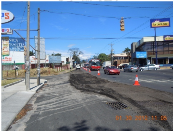
Fotografía 1. Inexistencia de separación entre flujos de tránsito Fecha: 30/01/2012
