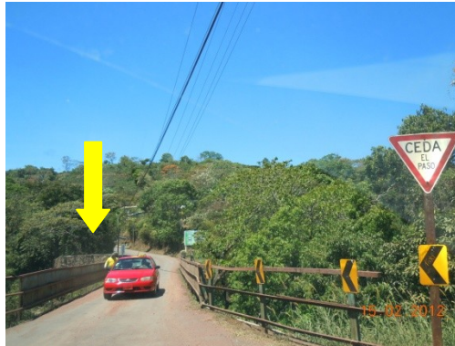
Fotografía 27. Puente sin pasarela peatonal.
