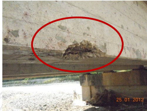
Fotografía 6. Viga con acero expuesto en proceso de corrosión.
