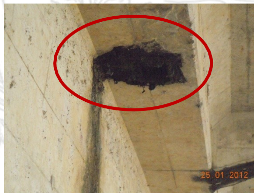
Fotografía 7. Ausencia de bajante para drenaje
