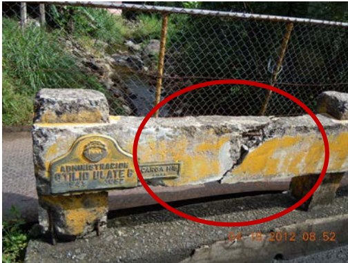
Fotografía 2. Barrera rígida con acero expuesto. Ubicación: Zona 6-1, Zona San Carlos, Ruta 140, Puente sobre Quebrada Matapalo, 5Km de Ciudad Quesada hacia La Marina, San Carlos. Fecha de la visita: 18/04/2012.
