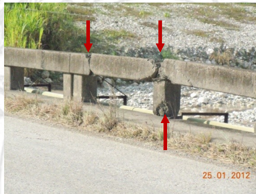
Fotografía 1. Barrera rígida con acero expuesto.
