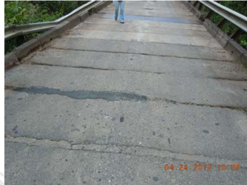
Fotografía 10. Paneles de concreto deteriorados. No hay demarcación vial. Ubicación: Zona 4-1, Pérez Zeledón, Ruta Nacional 244, Puente sobre el Río Platanar. Fecha de la visita: 24/04/2012.
