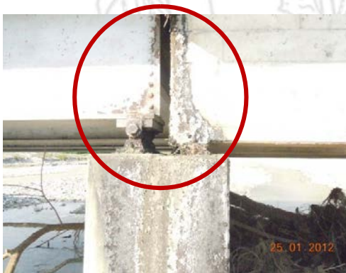
Fotografía 4. Vigas corroídas requieren mantenimiento.
