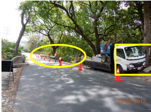
Fotografía 11. Sustitución de barrera por barrera tipo "Flex beam" en el puente sobre río sin nombre.
