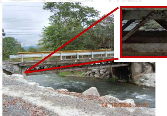
Fotografía 5. Viga corroída requiere de mantenimiento.
