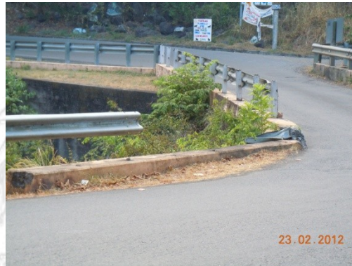
Fotografía 15. Barrera flexible colisionada y sin sustituir.
