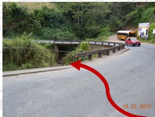
Fotografía 25. Ubicación: Zona 1-8, Turrialba, 200 m antes de Pacayas, sentido San José-Pacayas. Fecha de la visita: 18/02/2012.
