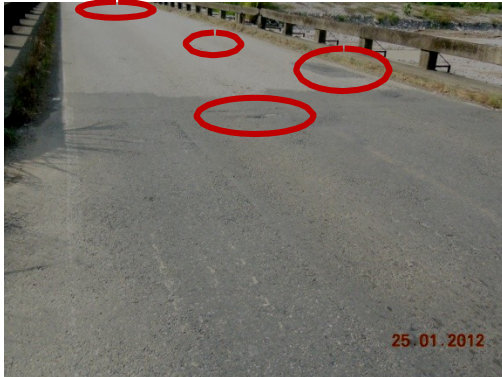
Fotografía 9. Deterioros existentes en la superficie de la losa y falta de demarcación. Ubicación: Zona 4-3 Zona Sur, Ruta Nacional 2, Puente sobre el Río Claro. Fecha de la visita: 25/01/2012.
