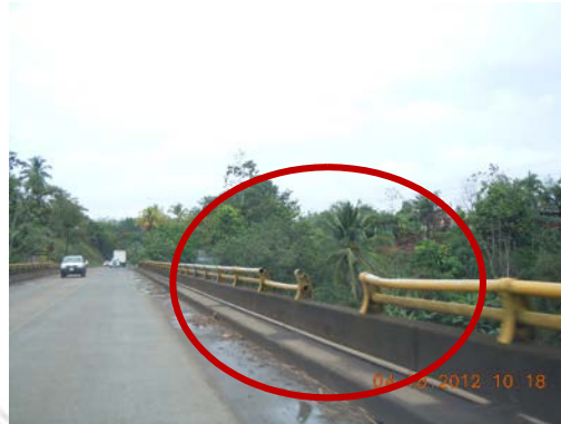
Fotografía 3. Barrera mixta incompleta. Ubicación: Zona 6-1, Zona San Carlos, Ruta 35, Puente sobre Río San Carlos. Fecha de la visita: 18/04/2012.
