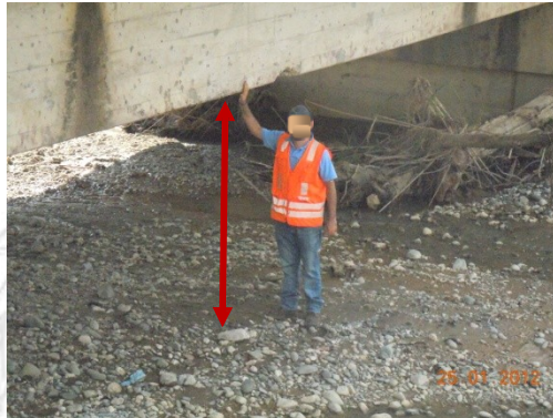
Fotografía 8. Capacidad hidráulica se disminuyó debido al material arrastrado por el río. Ubicación: Zona 4-3 Zona Sur, Ruta Nacional 2, Puente sobre el Río Claro. Fecha de la visita: 25/01/2012.
