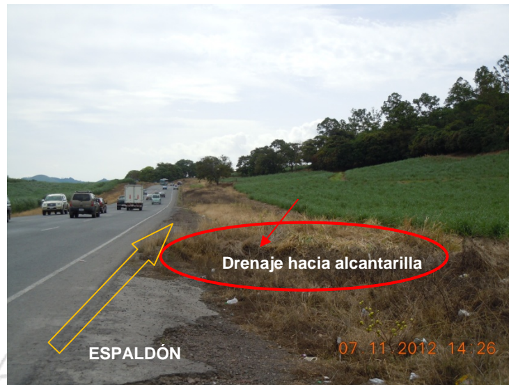
Fotografía 2. Drenaje contiguo al espaldón en el lugar conocido como “recta de los mangos” ó “cañales de Grecia”, aprox. Km. 28+900. Fuente: LanammeUCR.
