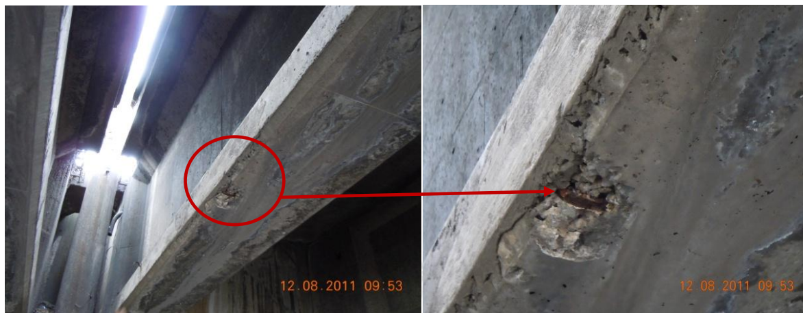
Figura 20. Acero de refuerzo expuesto en una de las vigas principales (viga más cercana al centro en el puente izquierdo, sentido Alajuela – San José)
