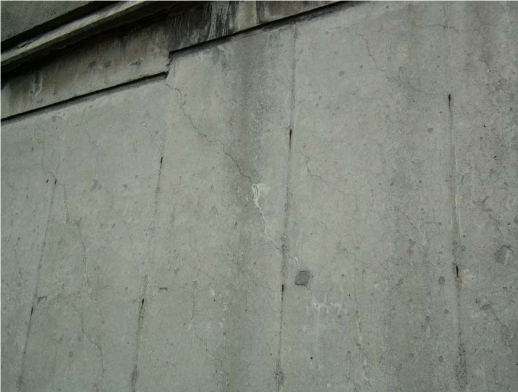
Figura 16: Fisuramiento diagonal en bastión Alajuela
