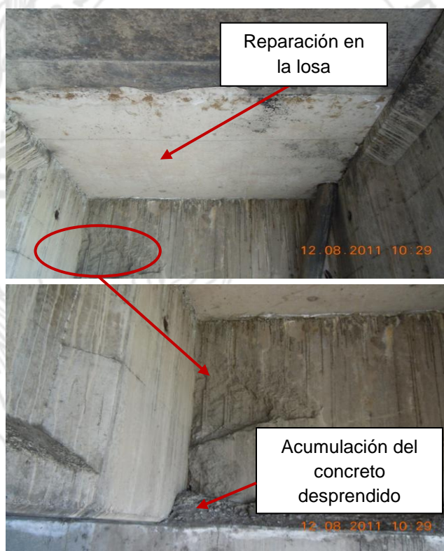
Figura 23. Desprendimiento del concreto y acero de refuerzo expuesto en la viga diafragma del bastión Norte (puente derecho).
