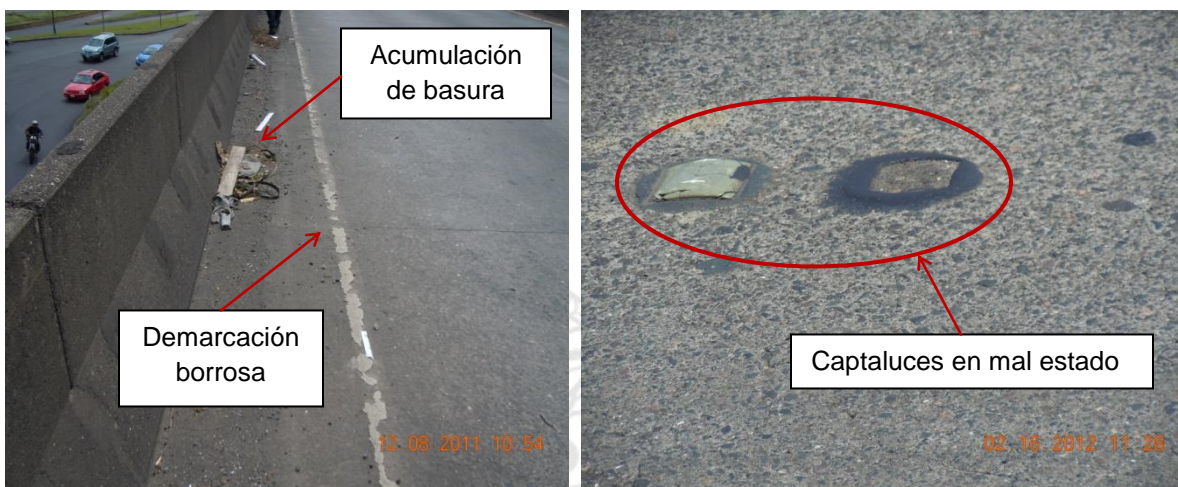
Figura 8. Demarcación borrosa y captaluces en mal estado
