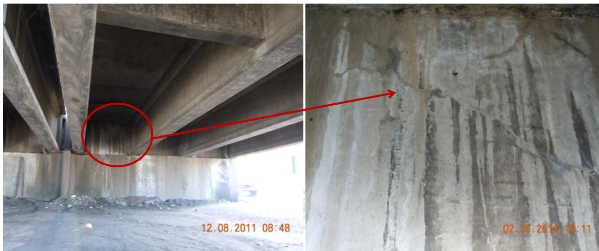
Figura 22. Agrietamiento existente en la viga diafragma del bastión Sur
