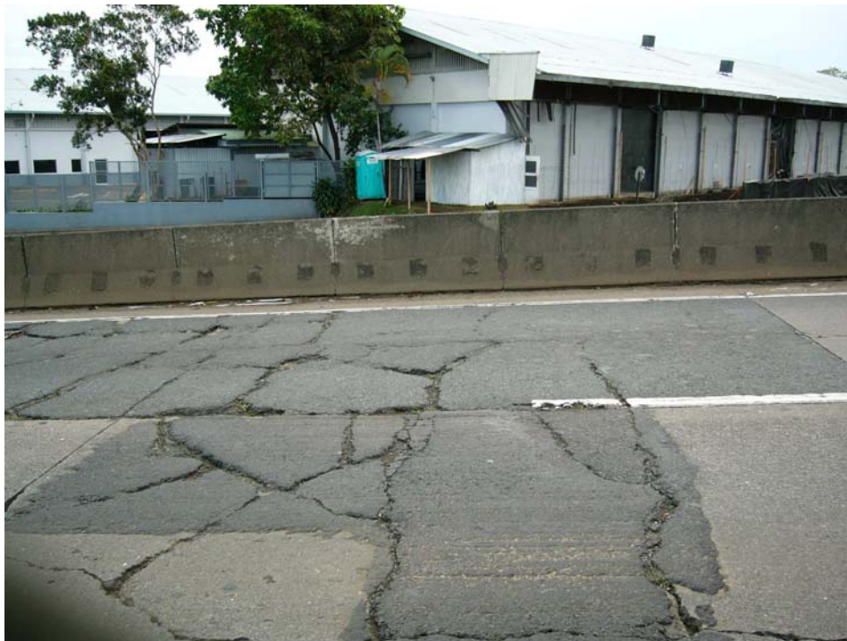
Figura 18: Deterioro en losa sobre relleno de aproximación
