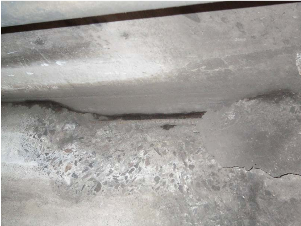
Figura 13: Pérdida de concreto en bastiones
