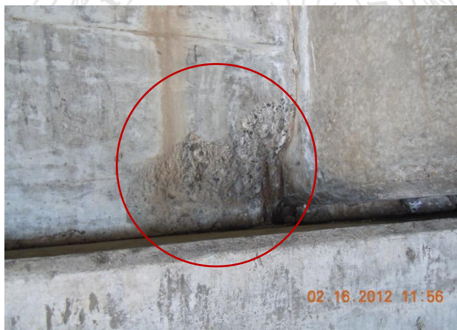
Figura 21. La segunda viga (de Este a Oeste) del puente izquierdo presenta desprendimiento del concreto y acero de refuerzo expuesto en la unión con el diafragma del bastión Norte.
