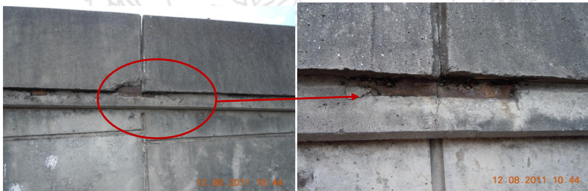
Figura 7. Oxidación en los elementos de anclaje de las barandas de contención vehicular.
