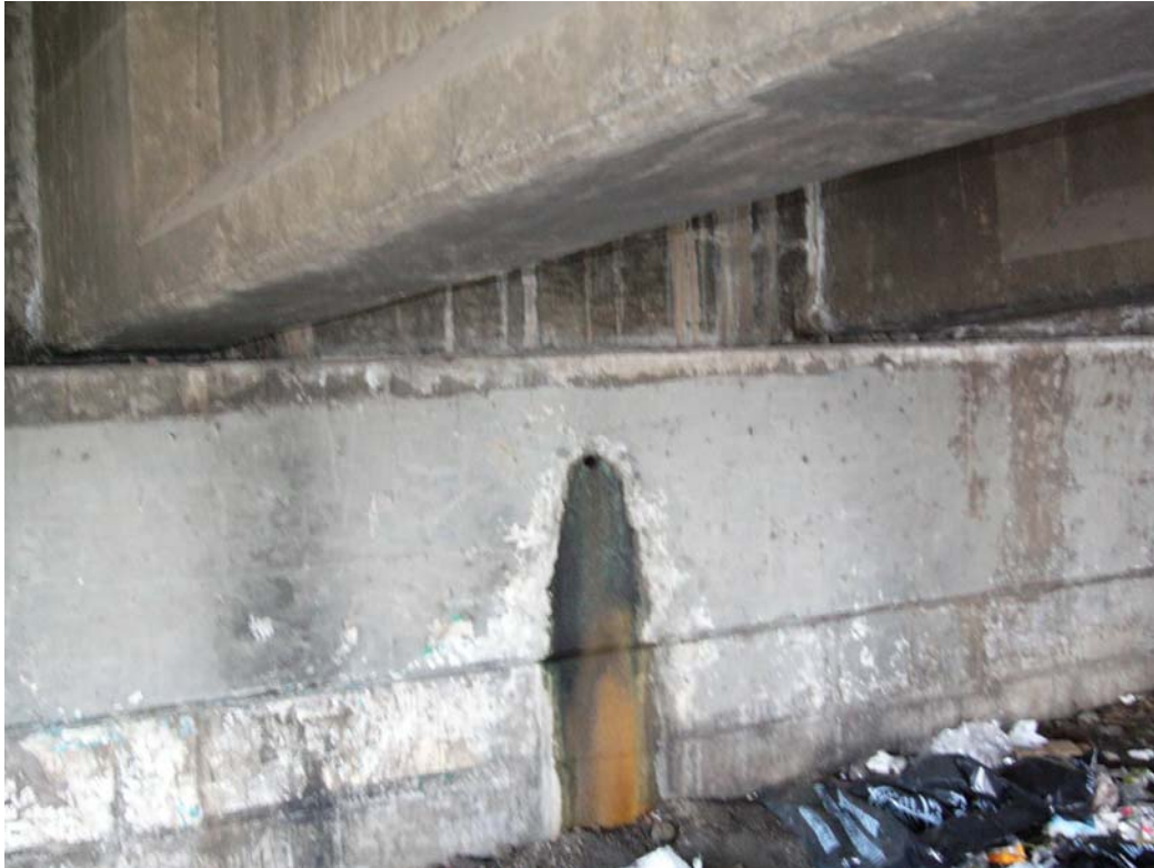
Figura 11: Acumulación de desechos en bastiones
