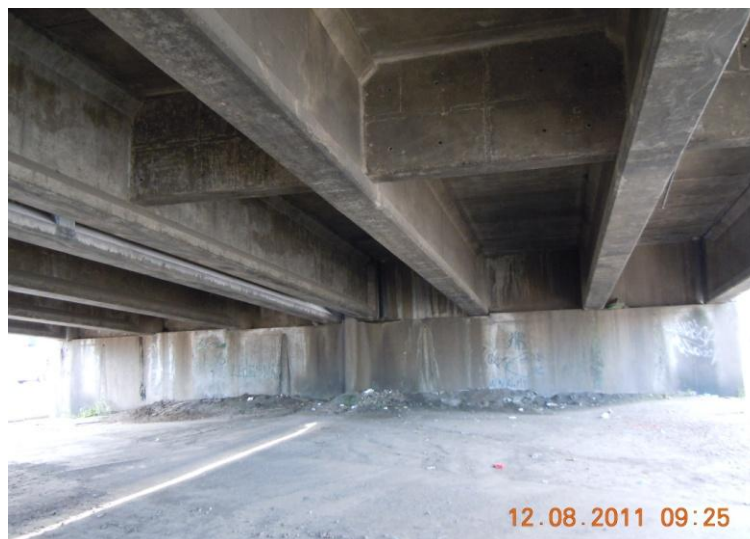
Figura 26. Filtración de agua a través de la junta de expansión en el muro del bastión Sur en ambos puentes (bastión Sur)
