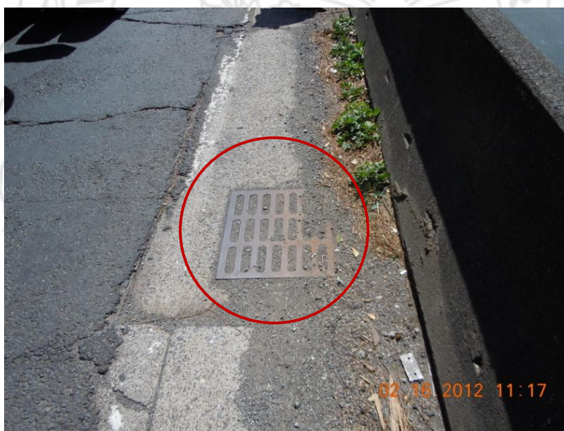
Figura 9. Drenaje en la rampa de acceso Norte (puente izquierdo) obstruido debido a la acumulación de sedimentos
