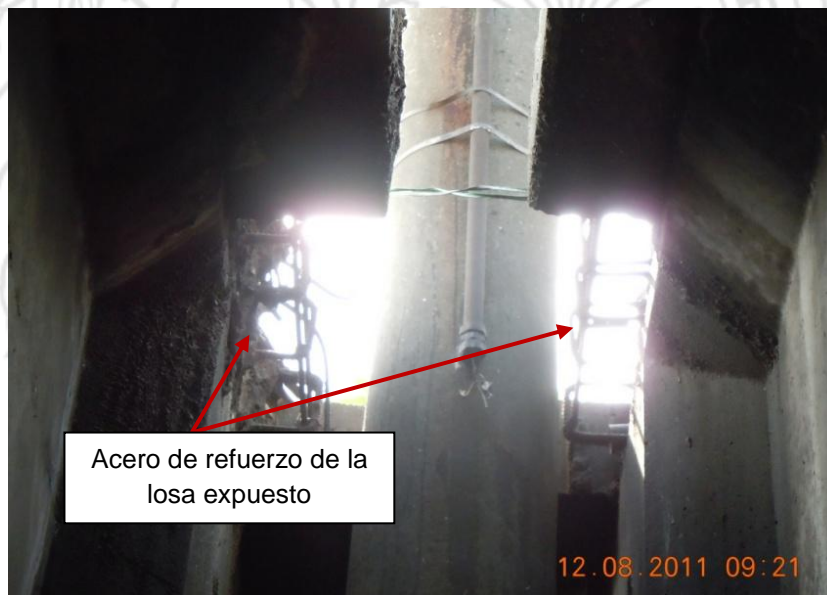
Figura 19. El acero de refuerzo de la losa está expuesto en las zonas donde se colocaron los postes del alumbrado público.
