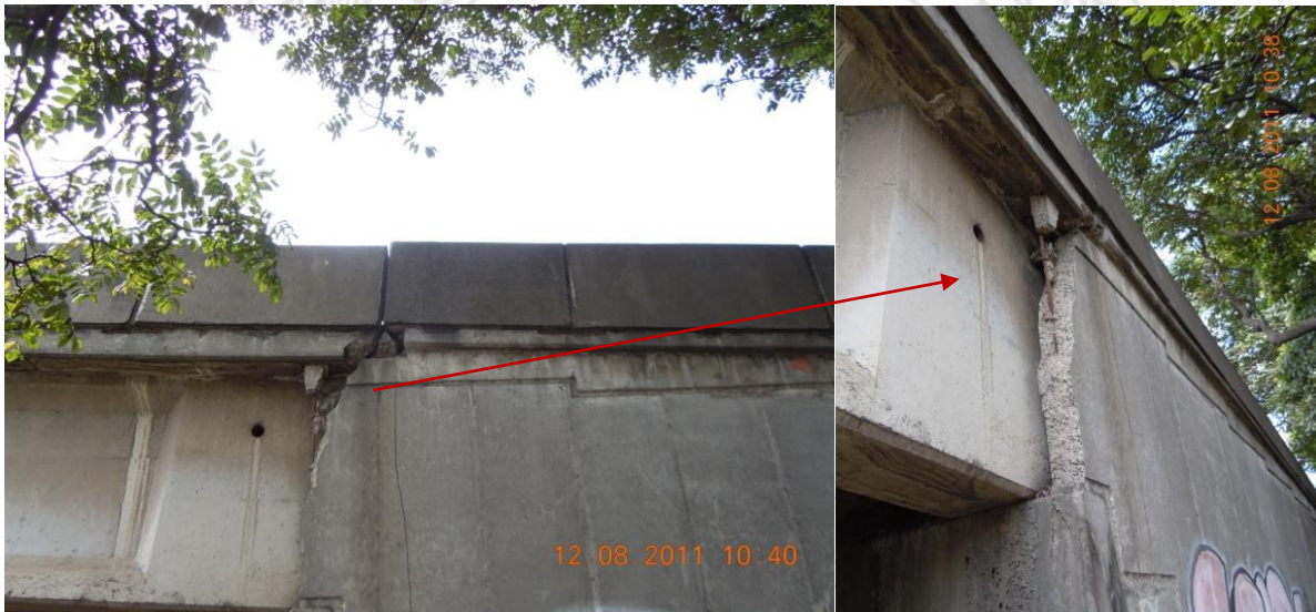
Figura 29. Pérdida del concreto y acero de refuerzo expuesto en el aletón del puente derecho (acceso Norte)
