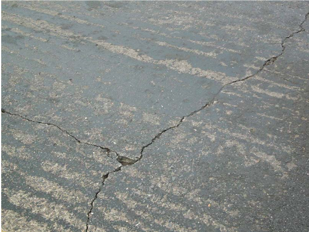
19: Deterioro en losa sobre relleno de aproximación
