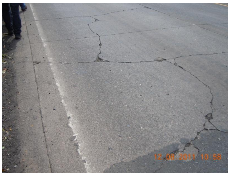
Figura 10. Agrietamiento de la losa de aproximación (acceso Alajuela, puente derecho)
