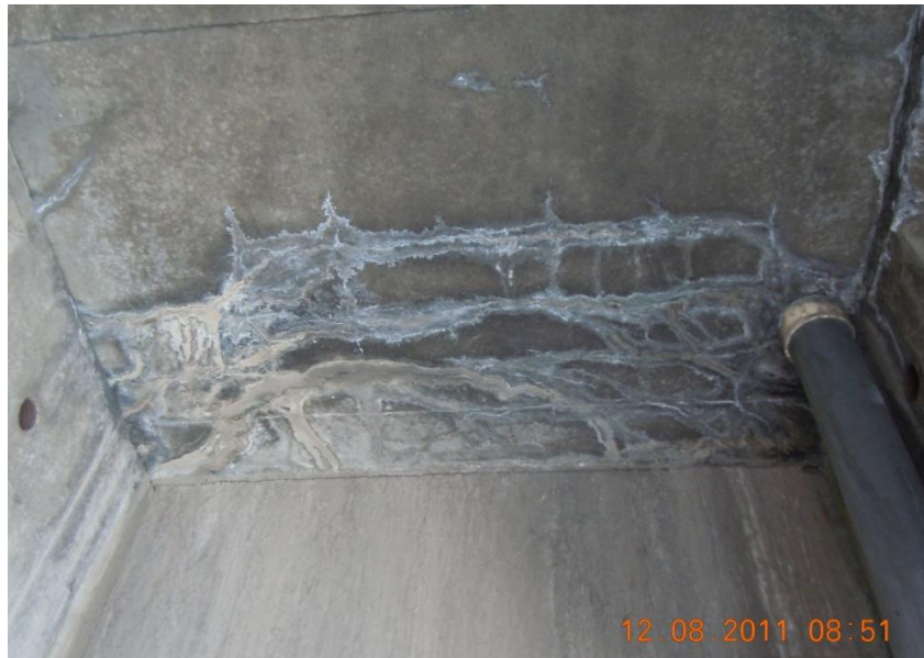
Figura 18. Filtración de agua en las zonas cercanas a los bajantes
