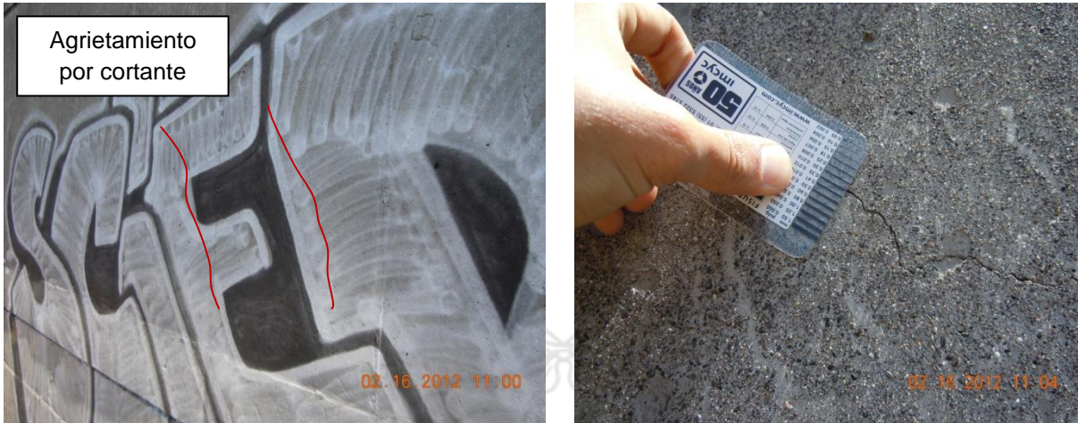
Figura 28. Agrietamiento por cortante en los aletones del bastión Norte
