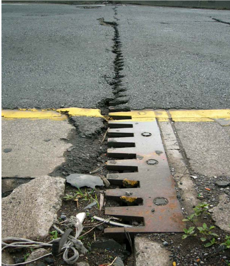
Figura 12: Deterioro de juntas de Movimiento
