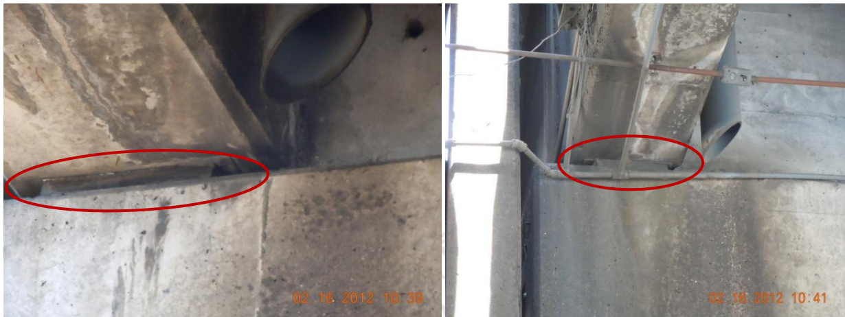
Figura 24. Deformación lateral en los apoyos sobre la pila 5 (de Sur a Norte, puente izquierdo)
