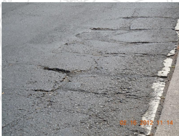
Figura 11. Losas de aproximación que presentan agrietamiento sobre las cuales se colocó una sobrecapa asfáltica (acceso Alajuela, puente izquierdo)
