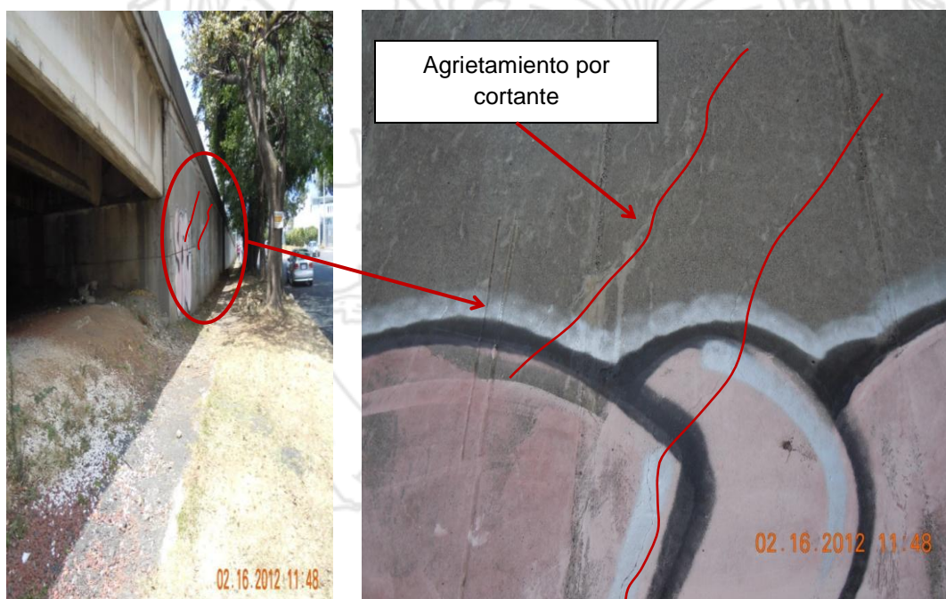
Figura 27. Agrietamiento por cortante en los aletones del bastión Norte
