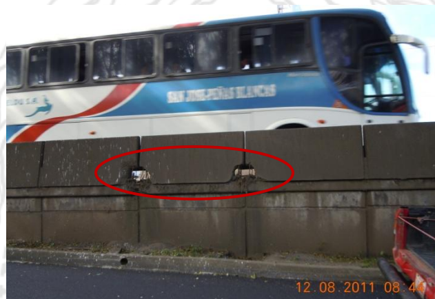
Figura 6. Pérdida de secciones de las barandas y acero de refuerzo expuesto (puente derecho) ocasionado por colisiones de vehículos contra la baranda
