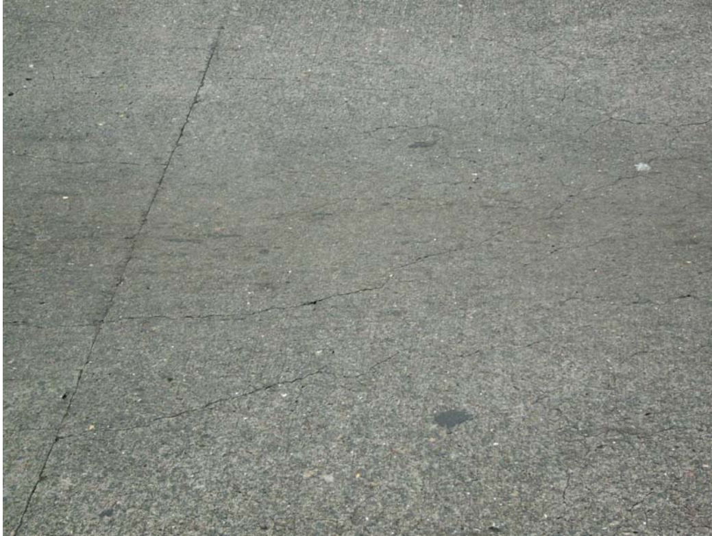
Figura 5: Fisuras en losa de rodamiento
