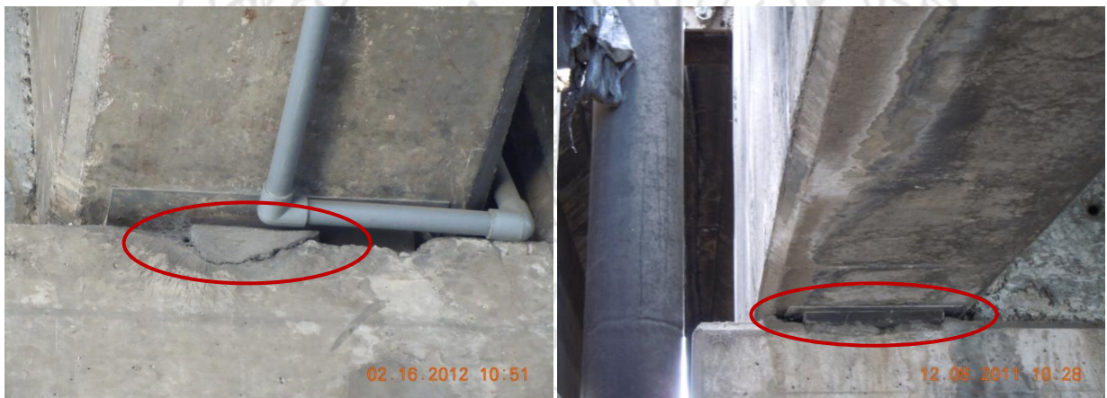
Figura 25. Desprendimiento del concreto en las vigas cabezales de las pilas bajo los apoyos expansivos de las vigas principales.
