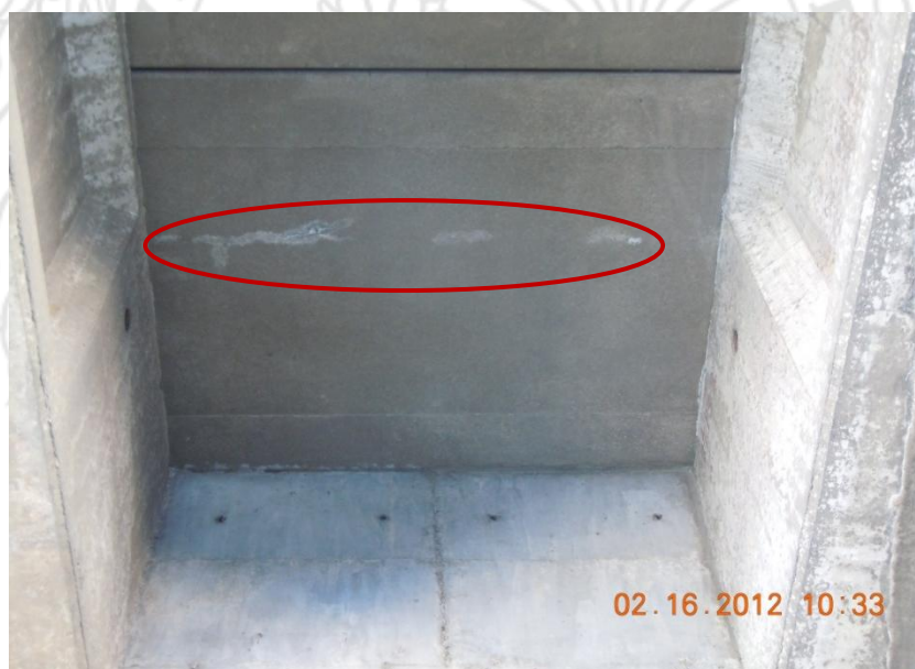
Figura 17. Eflorescencias en la superficie inferior de la losa (puente izquierdo, sentido Alajuela – San José)
