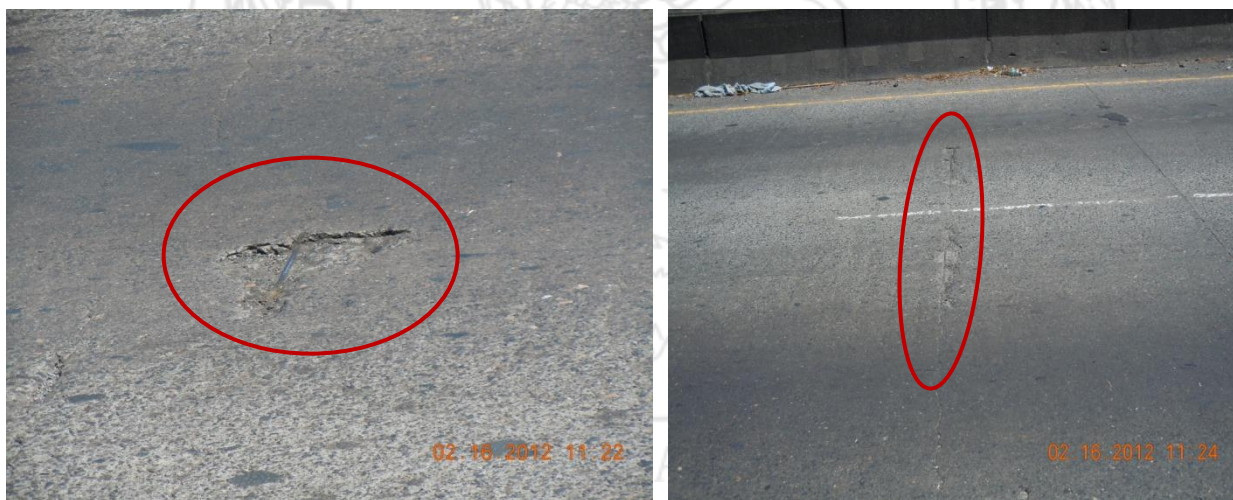
Figura 15. Agujeros en la losa y acero de refuerzo expuesto (puente izquierdo, sentido Alajuela – San José)
