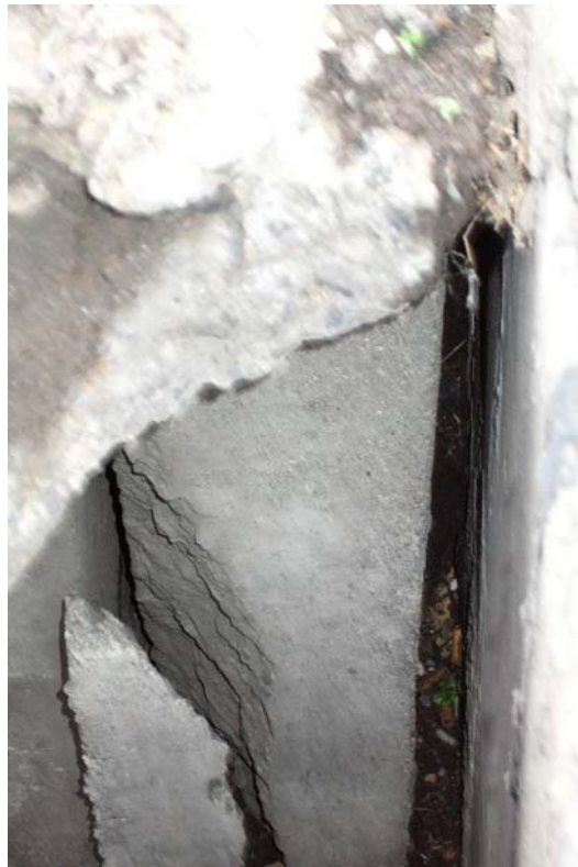
Figura 3: Deterioro en diafragmas de conexión a bastiones
