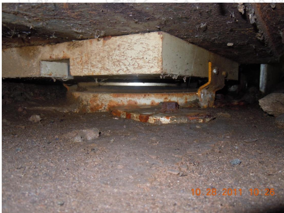
Figura 15. Oxidación y corrosión de los apoyos en los bastiones.
