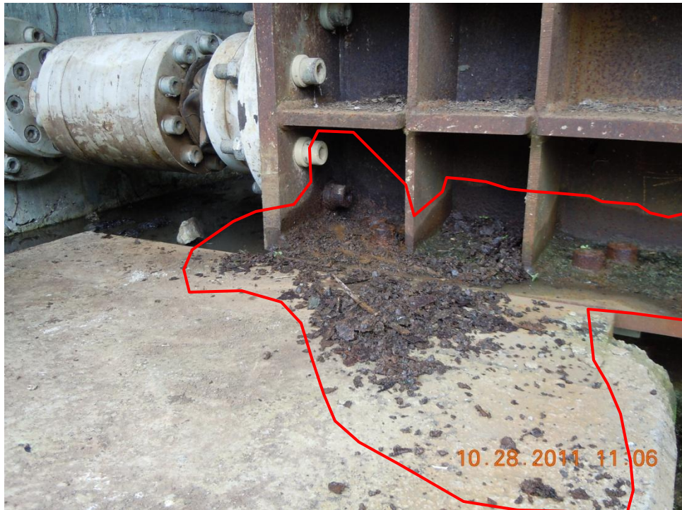
Figura 8. Corrosión anormal en las vigas principales de acero corten justo sobre los apoyos debido al contacto continuo con el agua.
