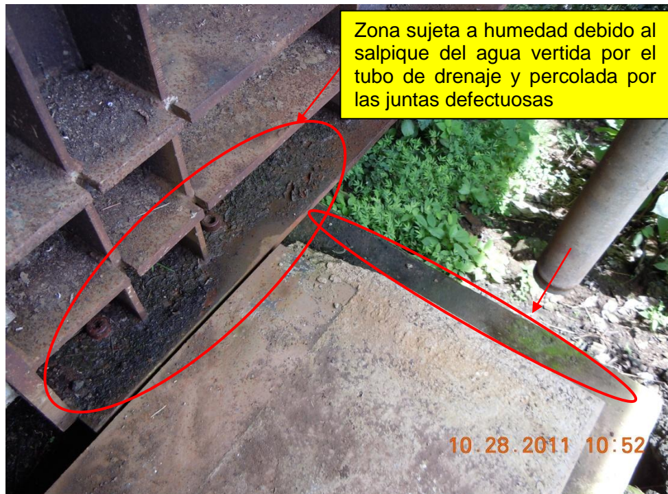
Figura 10. Drenaje que descarga directamente sobre los bastiones
