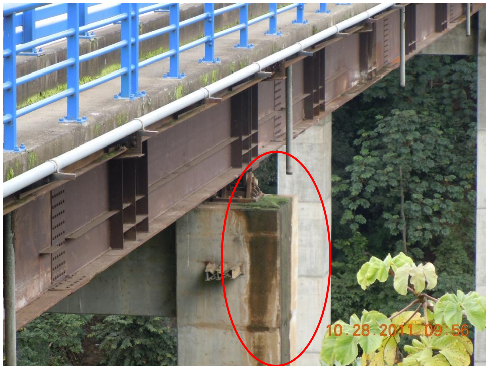
Figura 16. Plantas existentes alrededor de los apoyos en las pilas debido a descarga de agua de los drenajes sobre la pila.
