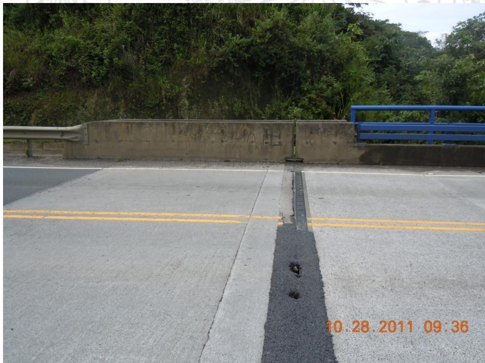
Figura 7. Sección de junta de expansión faltante del acceso oeste rellena con concreto asfáltico.
