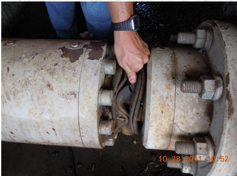
Figura 9. Falta del cobertor de protección de lámina de acero sobre los amortiguadores, oxidación de la superficie y deterioro de los protectores de hule.
