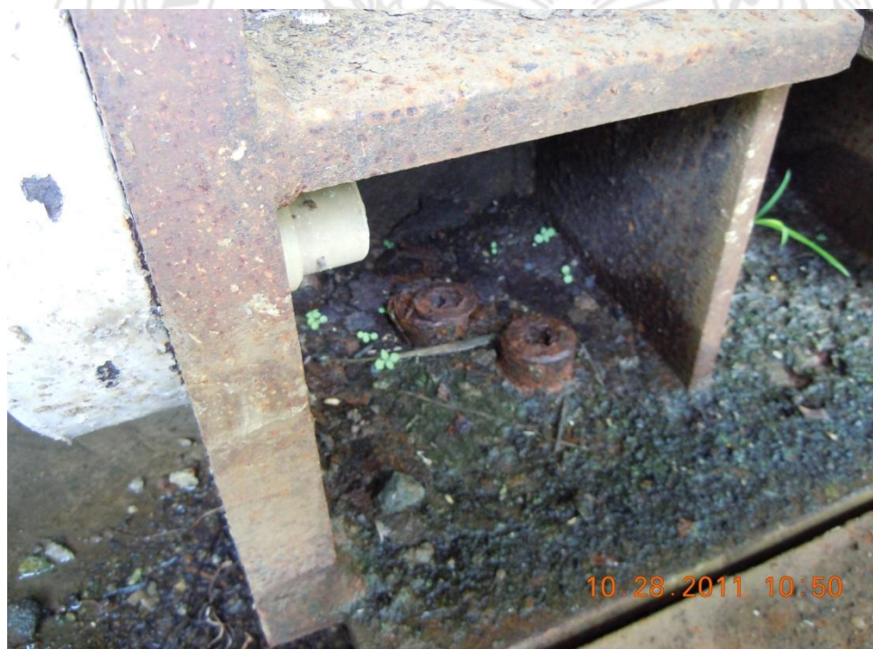
Figura 11. Corrosión anormal de la viga y de los pernos de anclaje debido a la exposición constante a la humedad.
