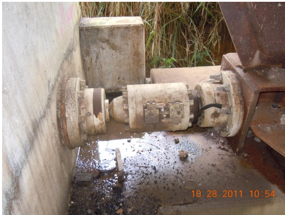
Figura 14. Amortiguador sin cobertor y sin aparente sistema de lubricación.
