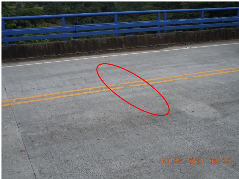
Figura 6. Grieta en una dirección en losa de rodadura (Espaciamiento entre grietas mayor a 1m)
