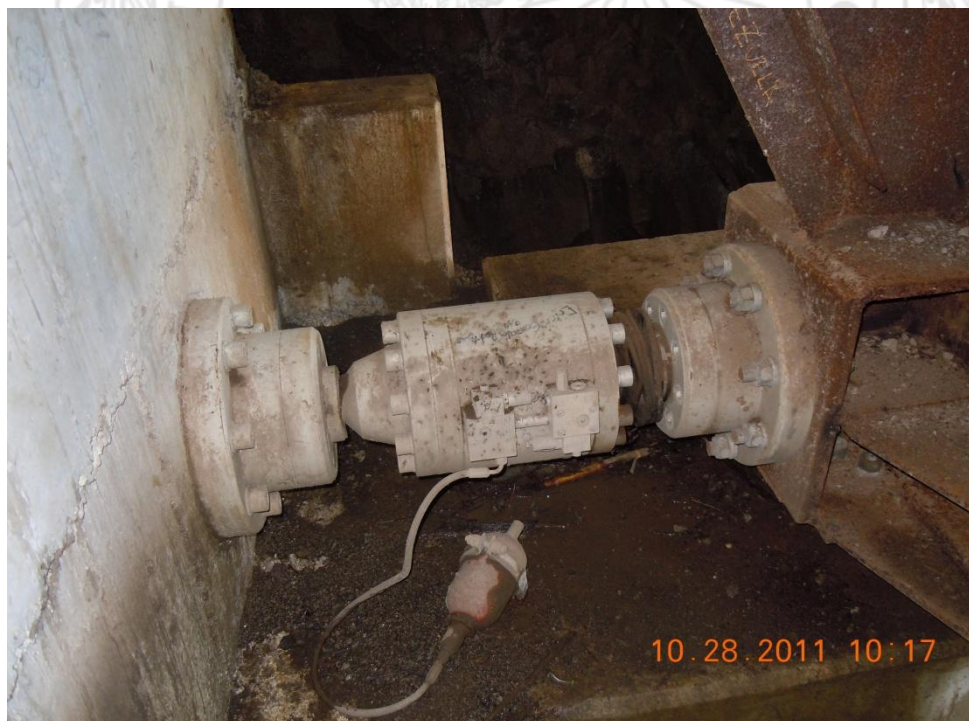
Figura 13. Amortiguador sin cobertor y aparente sistema lubricación expuesto del cual se desconoce si se encuentra en buenas condiciones.
