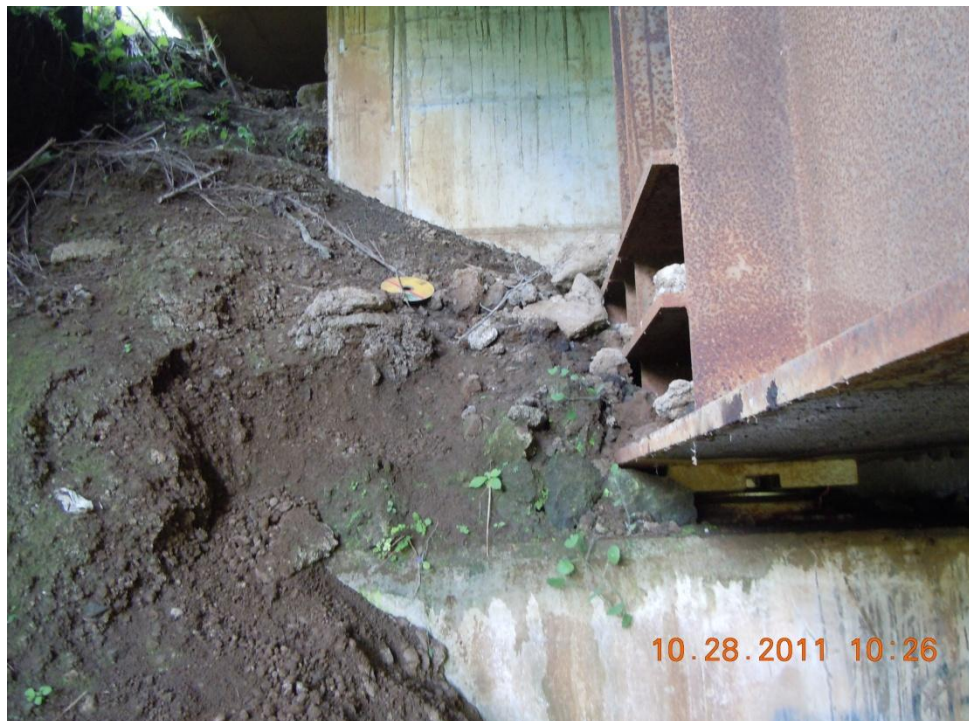
Figura 12. Suelo erosionado de los taludes junto a los bastiones que se deposita sobre la viga cabezal de los bastiones y alrededor de los apoyos del puente.
