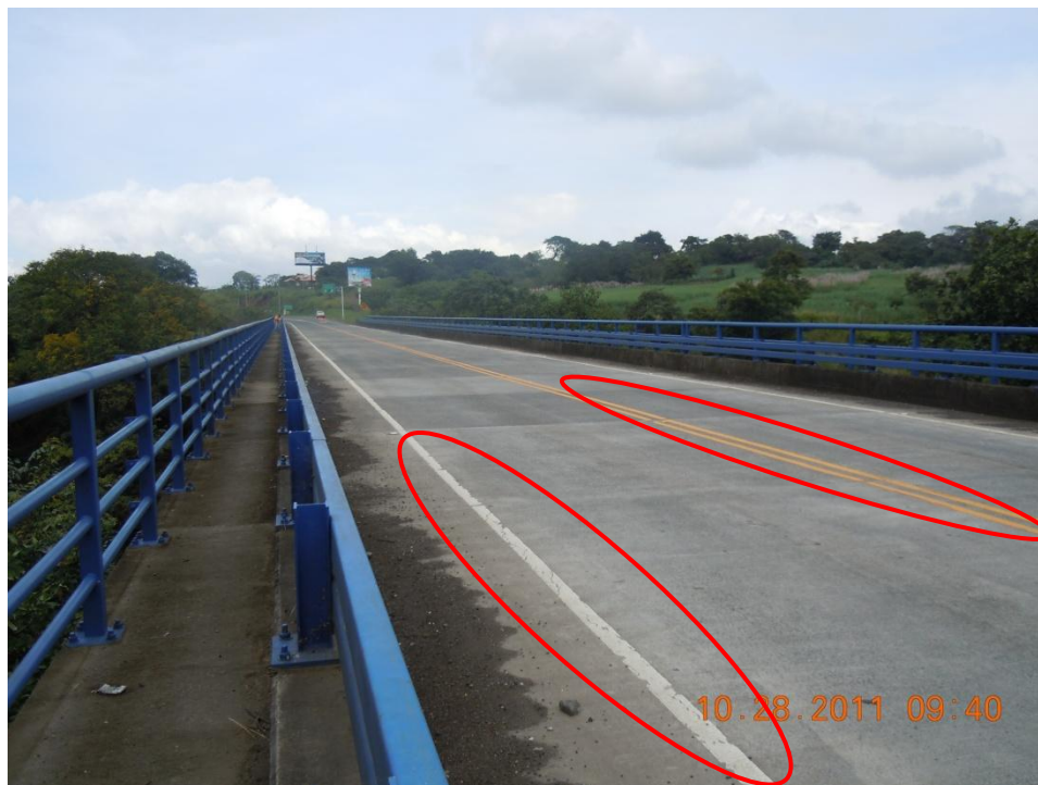
Figura 4. Estado regular de la demarcación vial del puente
