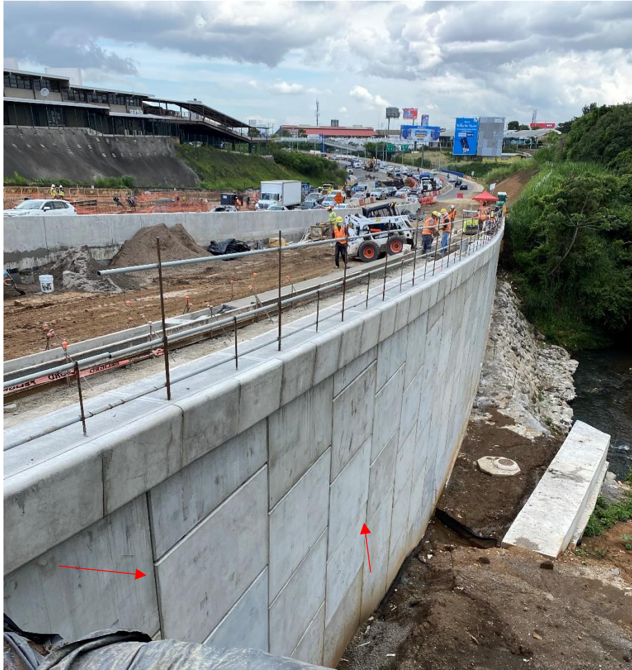
Fotografía 3. Cuadrantes que sobresalen del paramento del muro
