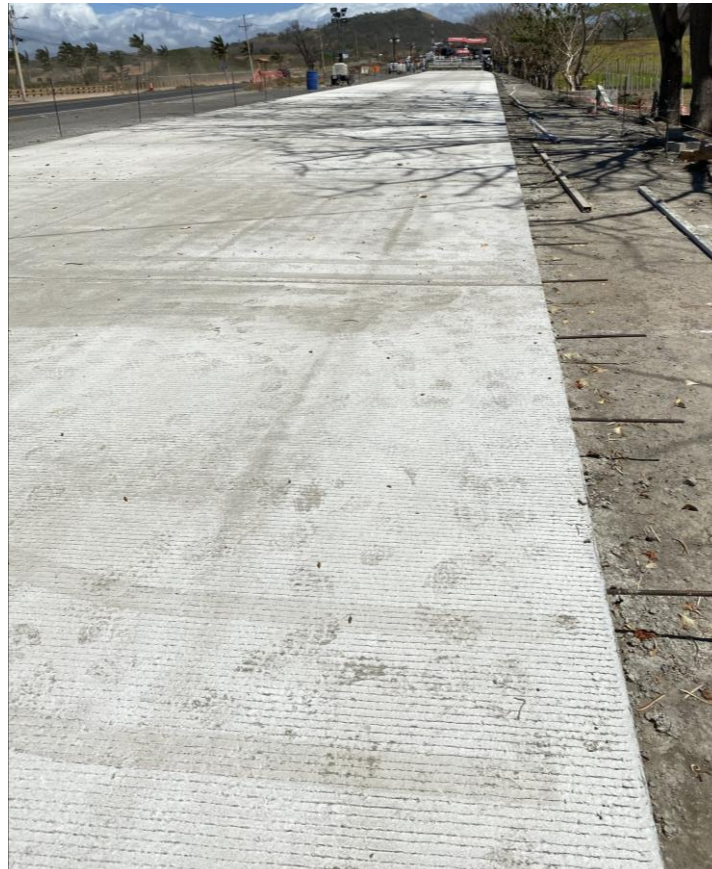
Fotografía 1. Pavimento de concreto cerca del río Salitral
