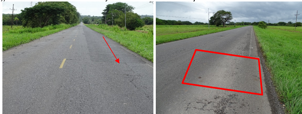
Figura 26. Construcción de baches que no abarcan la totalidad del área con deterioro. Ruta Nacional 1, Sección de control 50040 (Liberia (RN21 y RN918) – Límite Cantonal Liberia/La Cruz (Quebrada Puercos)). Estacionamiento 228+315 y 227+875. Fecha 30 de junio de 2022. Fuente: LanammeUCR
