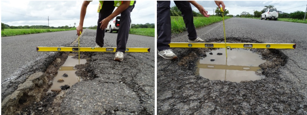
Figura 25. Formación de huecos. Ruta Nacional 1, Sección de control 50040 (Liberia (RN21 y RN918) – Límite Cantonal Liberia/La Cruz (Quebrada Puercos)). Estacionamiento 228+675 y 228+315. Fecha 30 de junio de 2022. Fuente: LanammeUCR
