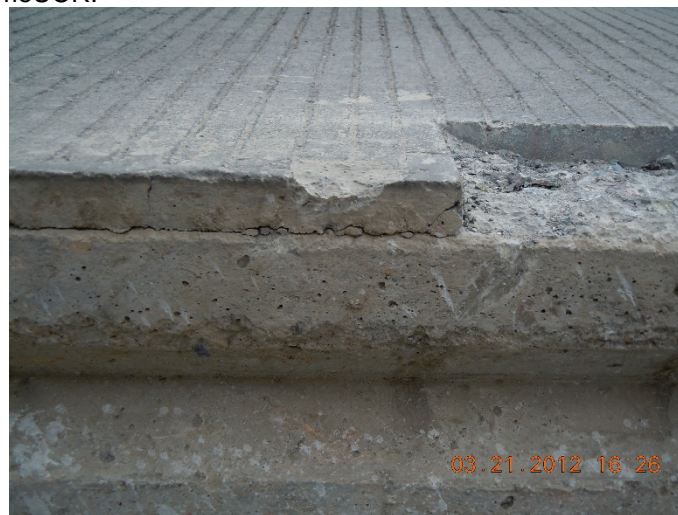
Figura 12. Las reparaciones realizadas no abarcaban la totalidad de las grietas. Ubicación: ruta nacional 2, km 18+700. Sección de control 30730, Lte. Cant. La Unión/Cartago - Taras. Fecha: 21 de marzo de 2012. Fuente: LanammeUCR.
