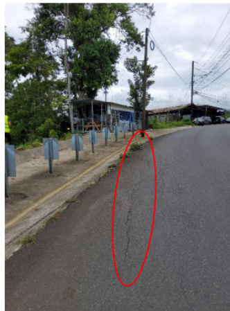
Figura 1 Grieta localizada en la superficie de pavimento
