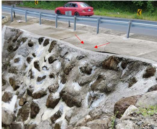
Figura 7 Evidencia de movimiento en el talud inferior de la vía en el sitio "Puente Casa"
