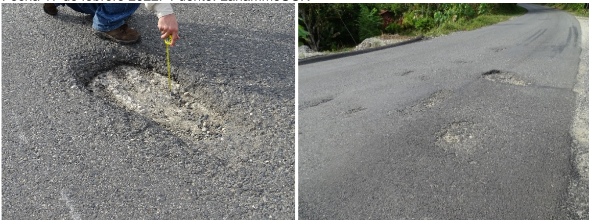
Figura 5. Formación de huecos en superficie de rodamiento. Ruta Nacional 2, Sección de control 60030 (Palmar Norte R34 – Chacarita R245). Estacionamientos 276+320, 277+230, 277+420 y 283+160. Fecha 17 de febrero 2022. Fuente: LanammeUCR
