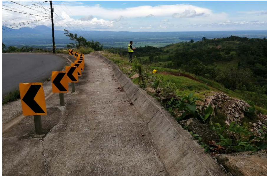
Figura 34. Ausencia de sistemas de contención vehicular. Ruta Nacional 141, Sección de control 20630 (Ciudad Quesada R140 – Florencia R35) Estacionamiento 54+735. Fecha 24 de marzo de 2022. Fuente: LanammeUCR
