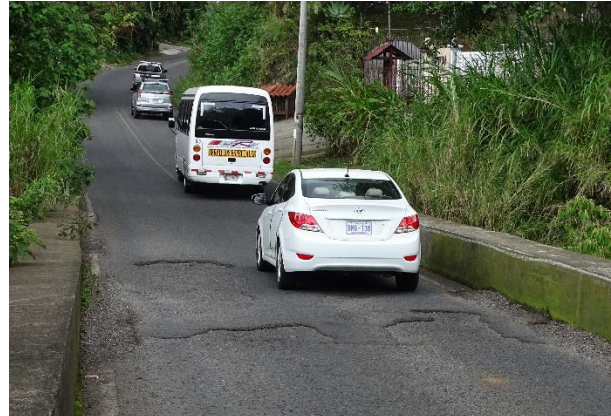
Figura 17. Deterioro de la carpeta asfáltica del tablero del puente sobre el Río Tibasito, Sección de control 40430 Montero o San Miguel (R32) – Los Ángeles de Tures (R116). Estacionamiento 3+776. Fecha 11 de mayo de 2022. Fuente: LanammeUCR
