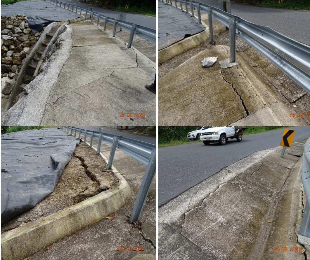
Figura 40. Deterioros de trabajos ejecutados en el Sector Puente Casa con meses de antigüedad. Ruta Nacional 141, Sección de control 20630 (Ciudad Quesada R140 – Florencia R35) Estacionamiento 55+600. Fecha 26 de septiembre de 2022. Fuente: LanammeUCR
