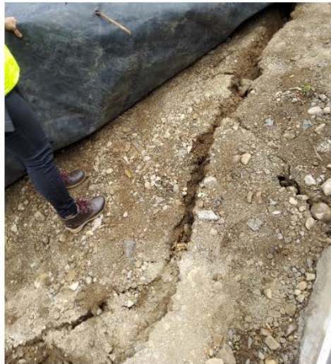
Figura 11 Formación de surcos en el relleno por filtración de agua de escorrentía
