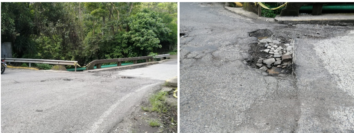
Figura 15. Deterioro del acceso al puente sobre el Río Ipís, Ruta Nacional 117, Sección de control 19035 (El Límite (RN102) – Límite Provincial San José/Heredia (Río Virilla)). Estacionamiento 1+545. Fecha 11 de mayo de 2022. Fuente: LanammeUCR
