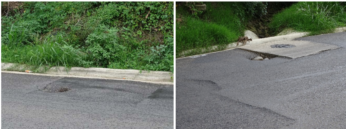
Figura 13. Huecos sobre bacheos, Ruta Nacional 117, Sección de control 19035 (El Límite (RN102) – Límite Provincial San José/Heredia (Río Virilla)) Estacionamiento 24+290. Fecha 11 de mayo de 2022. Fuente: LanammeUCR
