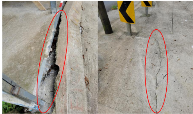
Figura 4 Agrietamientos en los alrededores de la vivienda
