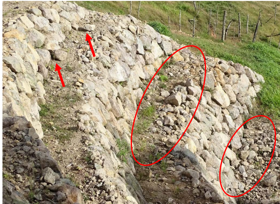
Figura 35. Condición de deterioro del sistema de banqueo con desprendimiento de rocas. Ruta Nacional 141, Sección de control 20630 (Ciudad Quesada R140 – Florencia R35) Estacionamiento 54+735. Fecha 24 de marzo de 2022. Fuente: LanammeUCR
