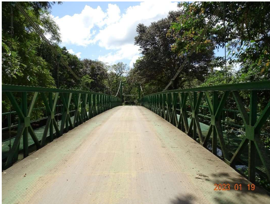
Figura 4.2. Vista a lo largo de la línea de centro del puente hacia San Isidro de Yolillal
