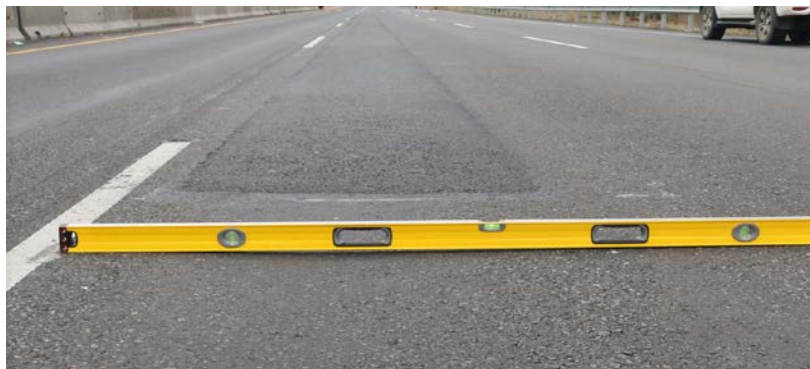
Figura 54. Ahuellamiento Obras de Ampliación Río Alajuela cercano a estacionamiento 26+960, carril central Sentido San José-San Ramón. Fecha 22 de agosto de 2022
