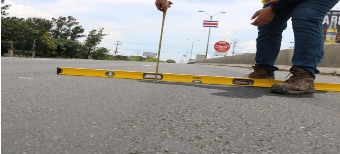
Figura 50. Ahuellamiento Obras de Ampliación Río Segundo cercano a estacionamiento 14+470 carril interno sentido San Ramón -San José 14+470. Fecha 22 de agosto de 2022
