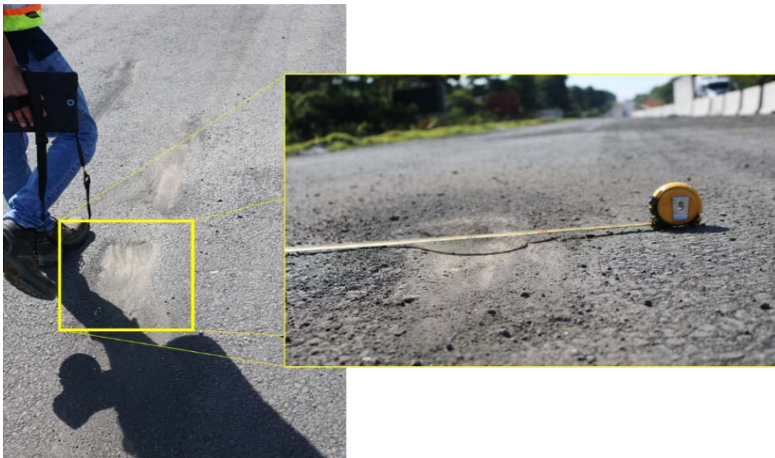
Figura 17. Deformación cubierta de polvo y arena. Fecha: 2 de julio del 2021
