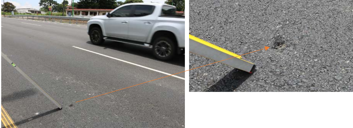
Figura 69. Secciones con desprendimiento de agregados, carril central Obras de Ampliación río Alajuela. Fecha: 23 de junio del 2022
