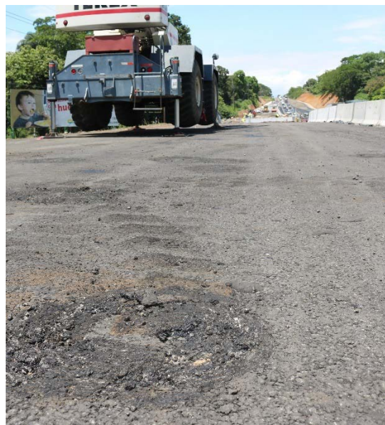
Figura 16. Desprendimientos y deformaciones río Alajuela. Fecha: 4 de junio del 2021
