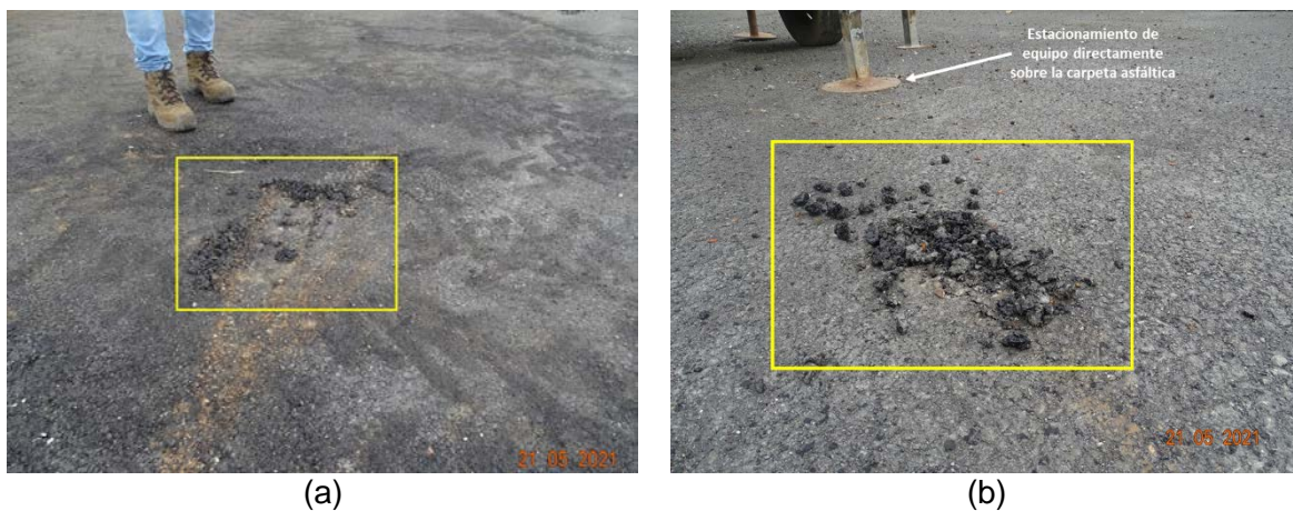
Figura 11. Desprendimientos de mezcla asfáltica. Fecha: 21 de mayo del 2021
