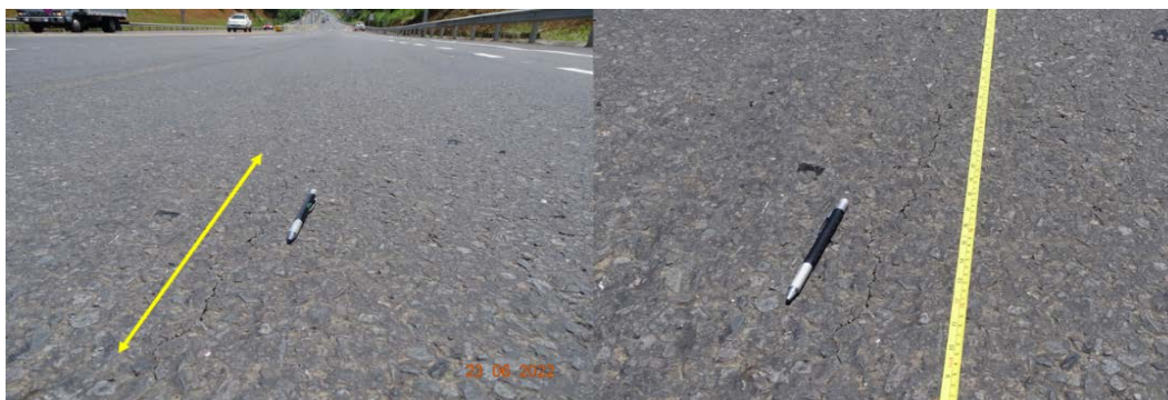
Figura 70. Grieta longitudinal en sección con deformación permanente Est. 26+800. Fecha: 23 de junio del 2022
