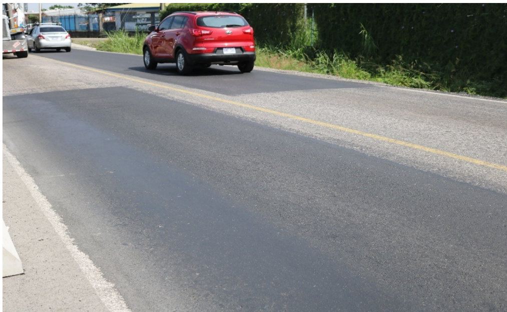
Figura 8. Bache con presencia de exudación. Fecha: 2 de julio del 2021
