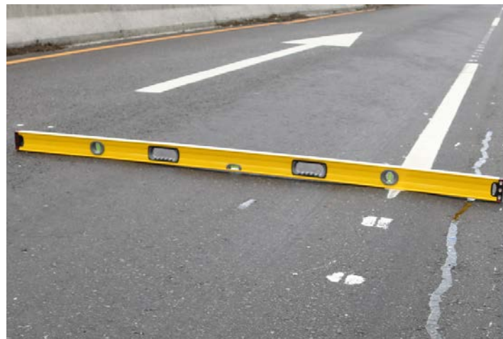
Figura 46. Ahuellamiento en carril interno sentido San Ramón – San José PD Firestone. Fecha: 29 de abril del 2022
