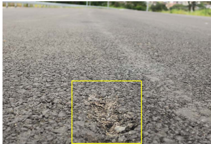
Figura 67. Desprendimiento de agregados en tronco principal Conector Barreal - Castella Fecha: 02 de julio del 2021
