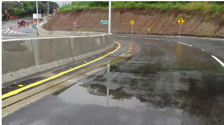
Figura 38. Deformación, acumulación de agua cerca del drenaje ranurado y concentraciones de humedad deformaciones en carpeta. Fecha: 24 de setiembre del 2021
