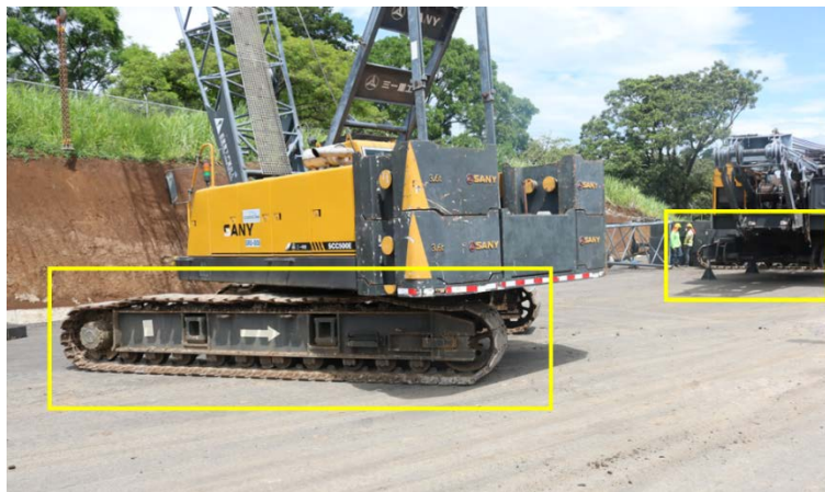
Figura 14. Maquinaria pesada en obras del Puente río Segundo. Fecha: 4 de junio del 2021
