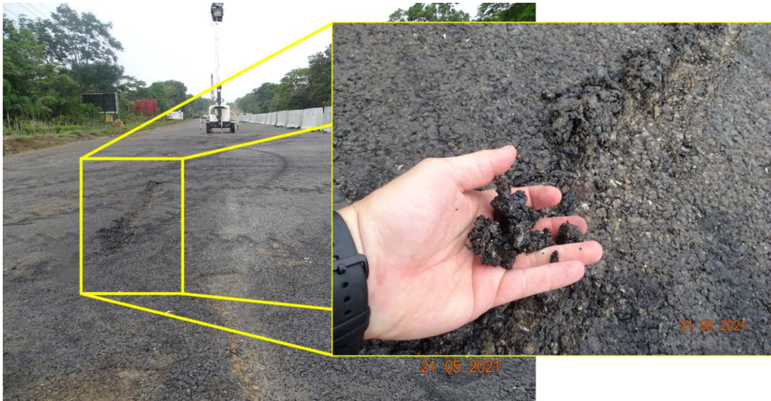
Figura 10. Deterioros en paño de mezcla asfáltica río Alajuela. Fecha: 21 de mayo del 2021
