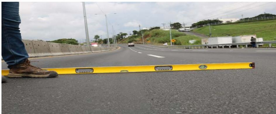
Figura 49. Ahuellamiento Obras de Ampliación Río Segundo cercano a estacionamiento 18+660, carril interno sentido San Ramón- San José. Fecha 22 de agosto de 2022
