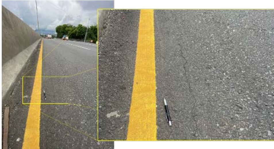
Figura 71. Grieta longitudinal inicio del proyecto Puente sobre el río Segundo. Fecha: 23 de junio del 2022
