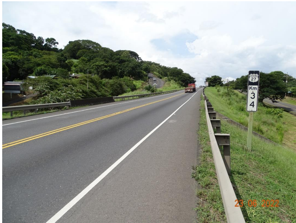
Figura 4.2. Vista a lo largo de la línea de centro del puente hacia San José
