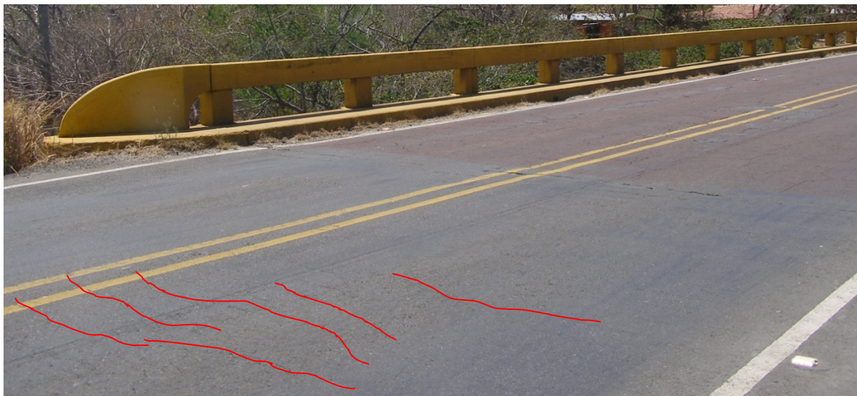
Figura 11: Agrietamiento transversal en la carpeta asfáltica del acceso-este (similar en el acceso-oeste).
