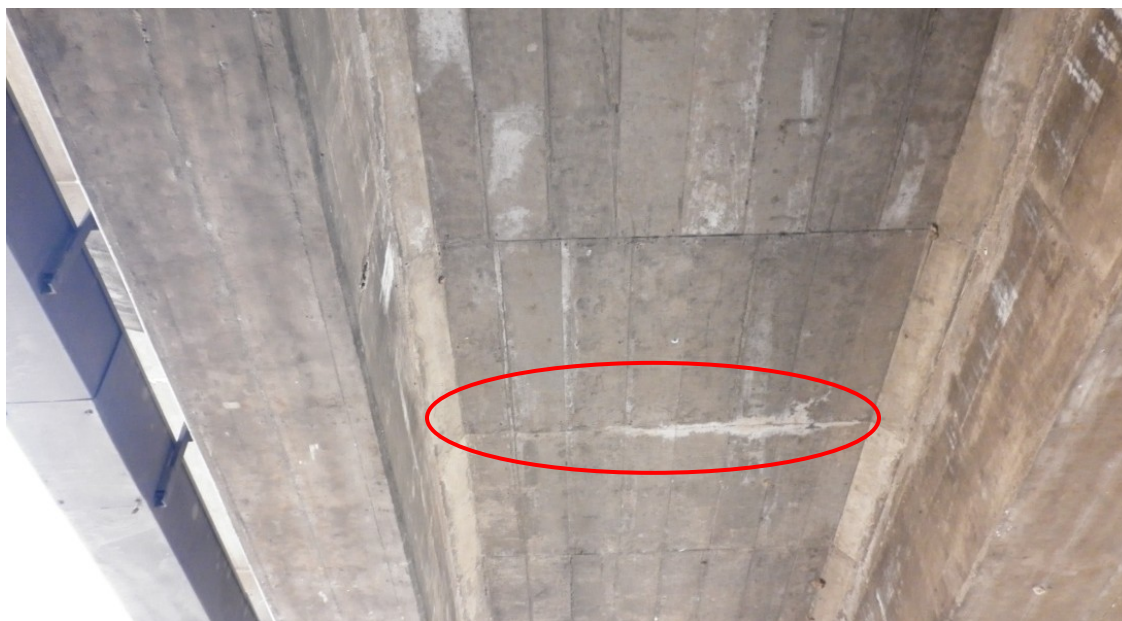
Figura 14: Grieta transversal con eflorescencia en la zona inferior de la losa.
