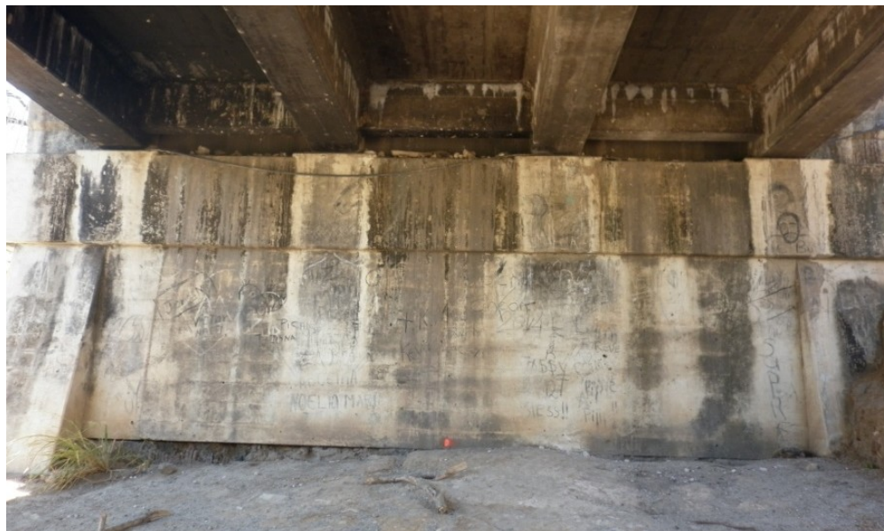
Figura 13: Manchas de humedad en la viga cabezal y cuerpo del bastión 2 producto del ingreso de agua a través de la junta.
