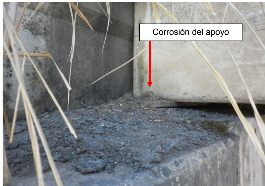
Figura 20: Apoyo sobre el bastión 1 corroído y cubierto con sedimentos provenientes de la superficie del puente que ingresaron por la junta de expansión .
