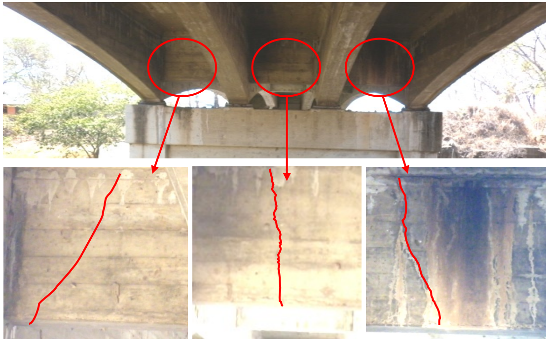
Figura 19: Grietas por cortante en las vigas diafragma ubicadas sobre las pilas (típico).
