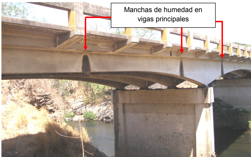
Figura 10: Manchas de humedad y musgo en la viga principal debido a la falta de tubos de extensión en los desagües del puente.
