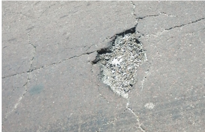
Figura 7: Desprendimiento de carpeta asfáltica.
