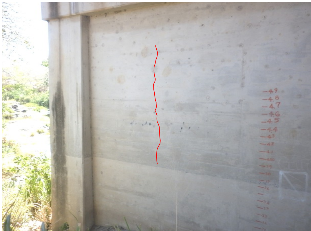
Figura 23: Grieta vertical por retracción temprana del concreto en muro pantalla de la pila 1.
