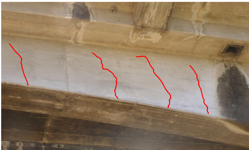
Figura 16: Detalle típico de grietas por cortante en la viga principal externa, en la zona cercana a la pila 2 (detalle típico).
