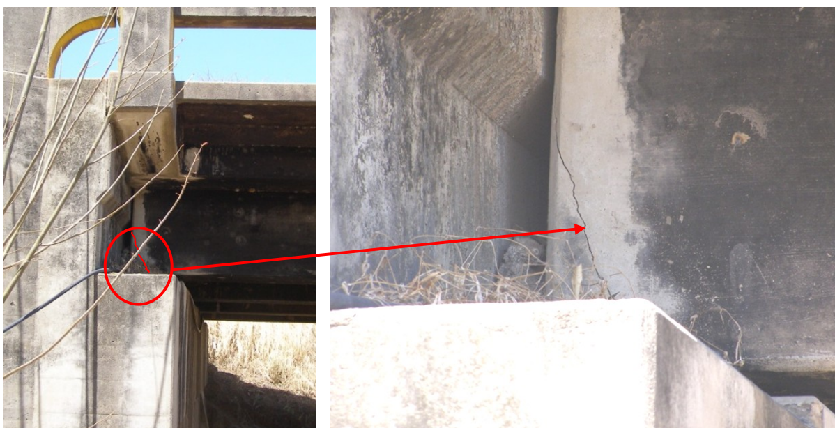
Figura 18: Grieta por restricción del movimiento de la viga externa observada en el apoyo sur sobre el bastión 2.
