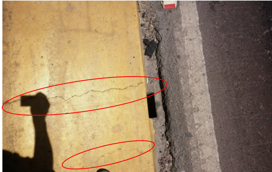
Figura 9: Agrietamiento transversal en la superficie superior del bordillo de seguridad.
