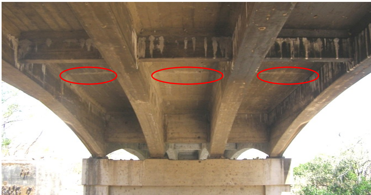
Figura 15: Grietas transversales con eflorescencia en la superficie inferior de la losa y que coinciden con una junta de construcción.
