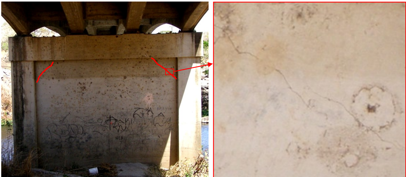
Figura 22: Grietas por cortante en el muro pantalla de la pila 2.
