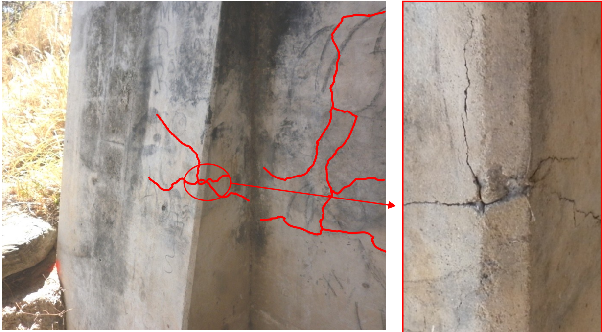
Figura 21: Grietas en el cuerpo del bastión 2.
