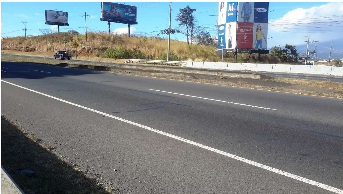
Figura 4.2. Vista a lo largo de la línea de centro (vista hacia Ciudad Colón).
