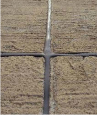
Figura 55. Sello excesivo en la junta Fuente: Calo. & Fernández. (2012)
