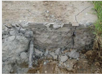
Figura 56. Agrietamiento de la losa de pavimento adyacente y deterioros en la base Fuente: Calo. (2016)
