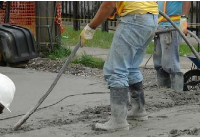
Figura 59. Uso incorrecto del vibrador de inmersión para concreto Fuente: LanammeUCR. (2008)
