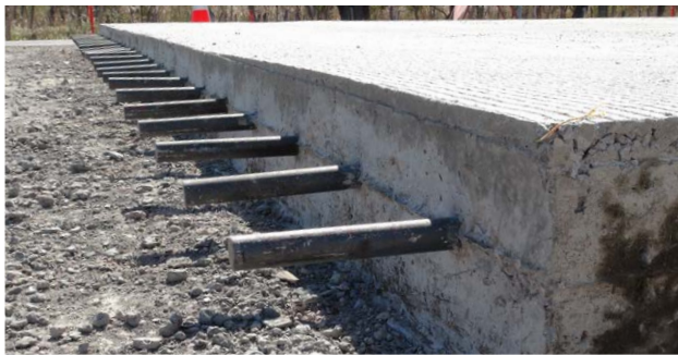
Figura 2. Dovelas en pavimento de concreto hidráulico articulado Fuente: LanammeUCR, 2013
