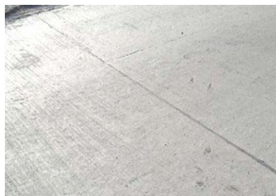
b) Pérdida de textura superficial
