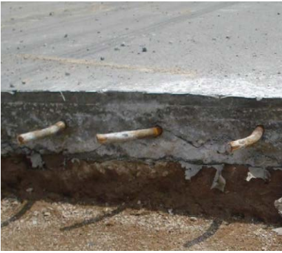
Figura 57. Deformación de dovelas existentes
