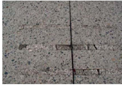
Figura 62. Deterioro del material de relleno de la ranura de la dovela colocada Fuente: Federal Highway Administration. (2014)
