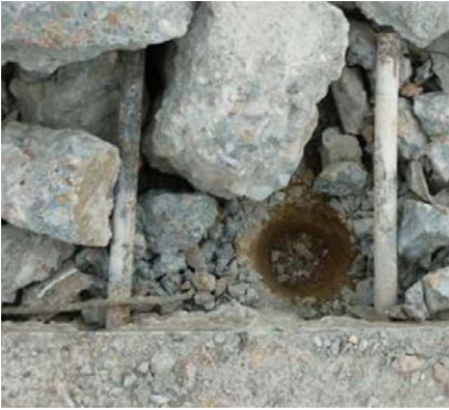
Figura 53. Deterioro de la base Fuente: Calo. & Fernández. (2012)
