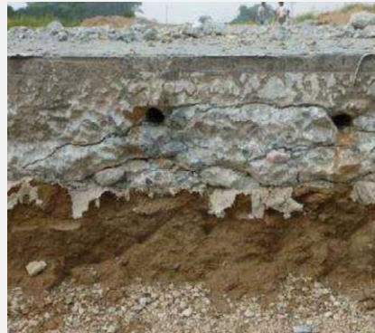
Figura 54. Agrietamiento de la losa de pavimento adyacente Fuente: Calo. & Fernández. (2012)
