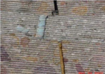
Figura 63. Interrupción de la continuidad de la junta en el concreto Fuente: Federal Highway Administration. (2014)
