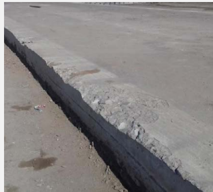
Figura 58. Deterioro de la superficie de la losa adyacente
