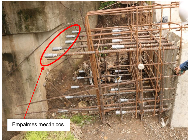
Figura 8. Observaciones realizadas en el puente sobre el Río Lajas. Junta de construcción vertical de la viga cabezal y empalmes mecánicos del refuerzo longitudinal del bastión 2 (hacia Cañas).
