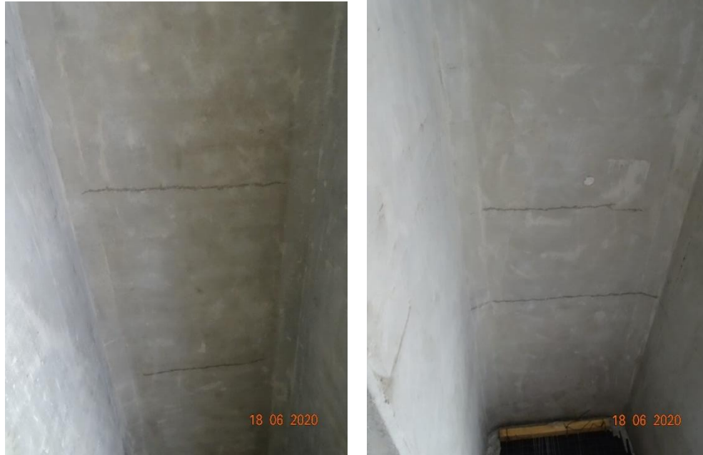
Figura 17. Observaciones realizadas en el puente sobre el Río Salitral (aguas abajo). Evidencia de fisuras resanadas al medio de las vigas prefabricadas presforzadas doble “T”
