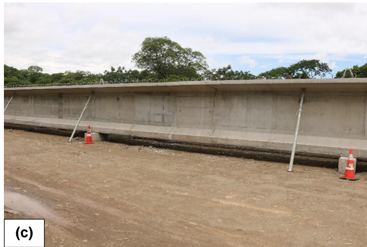
Figura 11. Observaciones realizadas en el puente sobre el Río Higerón. (a) Drenajes en zona de apoyos de viga cabezal de bastión 2 (hacia Cañas). (b) Junta de construcción vertical de la viga cabezal del bastión 1 (hacia Limonal). (c) Construcción de juntas en campo de las vigas tipo “Bulbo” prefabricadas.
