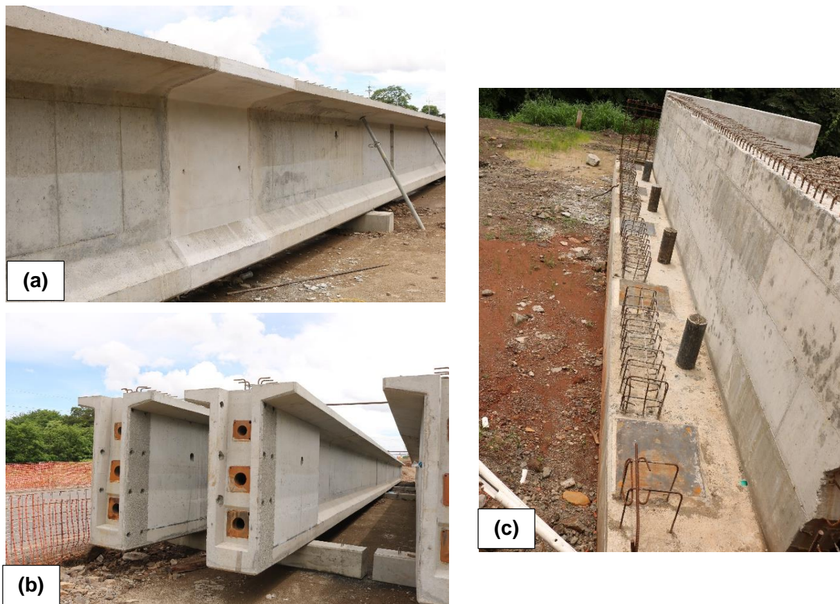
Figura 10. Avance en la construcción del puente sobre el Río Higerón. (a) Vigas prefabricada tipo “Bulbo” completadas en sitio. (b) Vigas prefabricada preparadas para aplicación del presfuerzo (c) Bastión 1 (hacia Limonal) completado hasta nivel de viga cabezal y parapeto.
