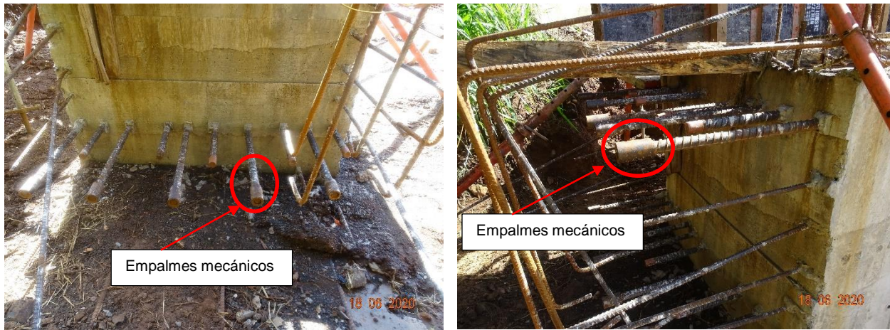
Figura 21. Observaciones realizadas en el puente sobre el Río Javillos. Junta de construcción vertical de la viga cabezal del bastión 2 (hacia Cañas).
