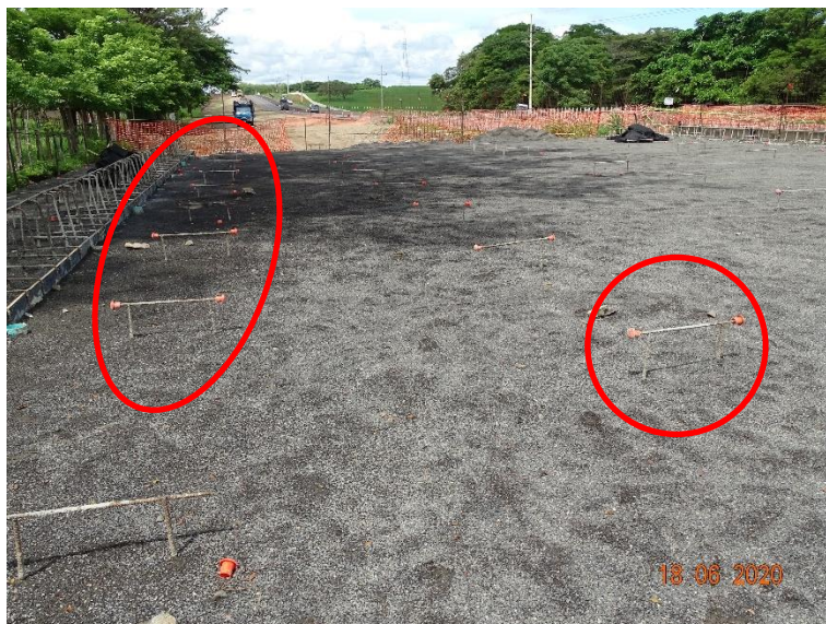
Figura 18. Observaciones realizadas en el puente sobre el Río Salitral. Barras de refuerzo que sobresalen de la losa y material de curado sobre la misma.
