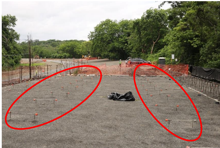
Figura 4. Observaciones realizadas en la superestructura del puente sobre Río Desjarretado. Barras de refuerzo que sobresalen de la losa y material de curado sobre la misma.
