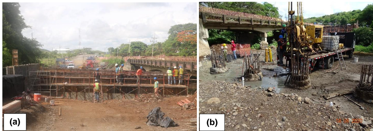
Figura 20. Avance en la construcción del puente sobre el Río Javillos. (a) Armado y encofrado de parapeto y aletón aguas arriba del bastión 2 (hacia Cañas). (b) Micropilotes en cimentación del bastión 1 (hacia Cañas).
