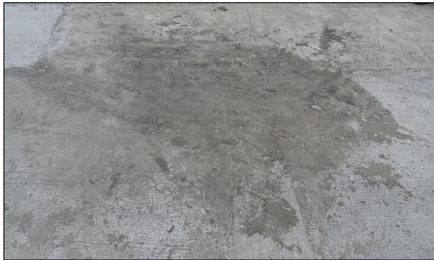
Figura 4. Acumulación de sedimento sobre la losa del tablero.
