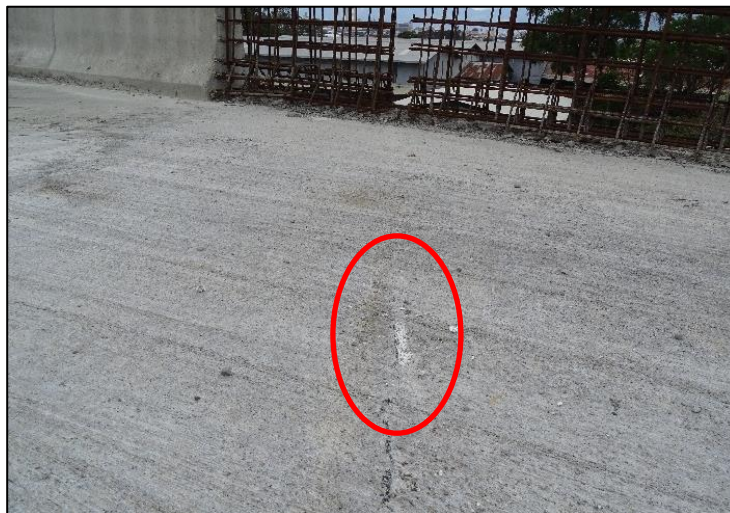
Figura 11. Junta donde la rótula de continuidad entre tableros ya había sido construida. Se observó el uso de una lámina de poliestireno para generar la abertura en las losas de los tableros; aún no se había colocado el sello que se muestra en los planos.
