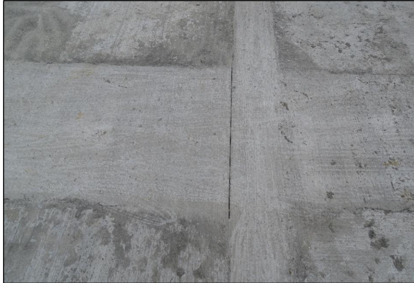
Figura 6. Junta de contracción sobre una de las uniones coladas en sitio entre los paneles prefabricados.
