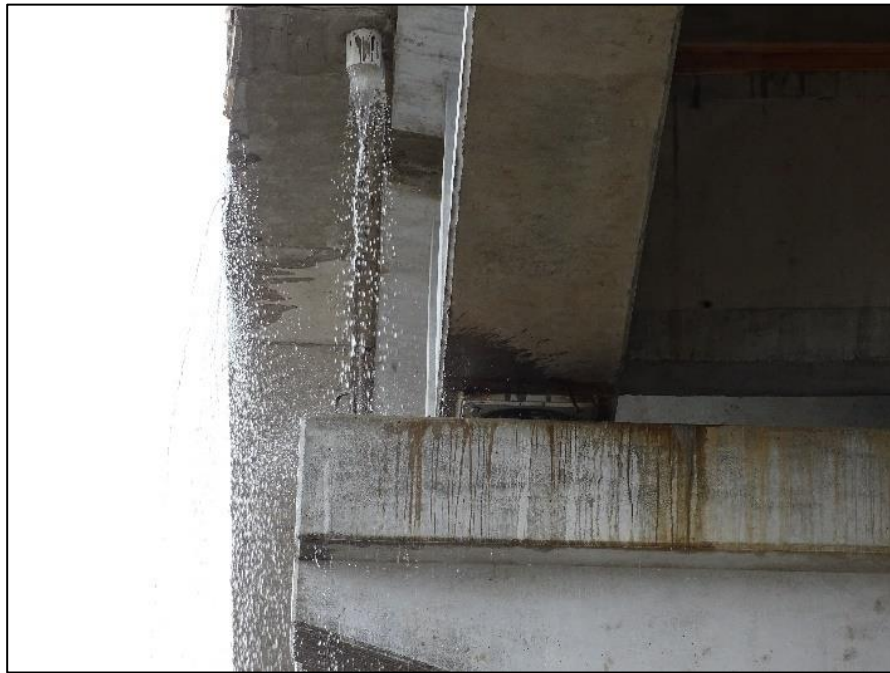
Figura 18. Agua de lluvia proveniente de la superestructura descargando directamente sobre la pila del viaducto.
