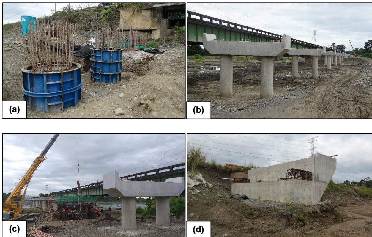
Figura 15. Avance en la construcción del puente sobre el Chirripó. (a) Colado de los pilotes del Bastión 1 (lado de San José). El concreto aún estaba fresco. (b) Vista general de las pilas construidas. (c) Trabajos de construcción en la Pila 11. (d) Avance en la construcción del Bastión 2 (lado de Limón).
