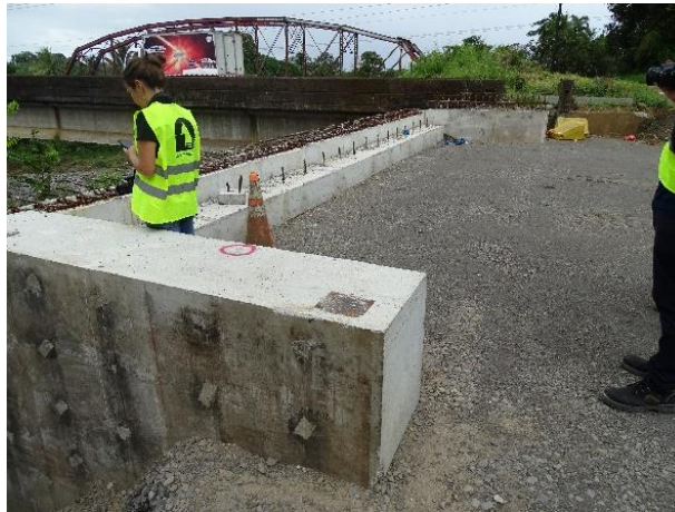
Figura 10. Bastión 2 (lado de Limón) del puente sobre el Río Parismina, no se observó sistema de drenaje detrás del bastión
