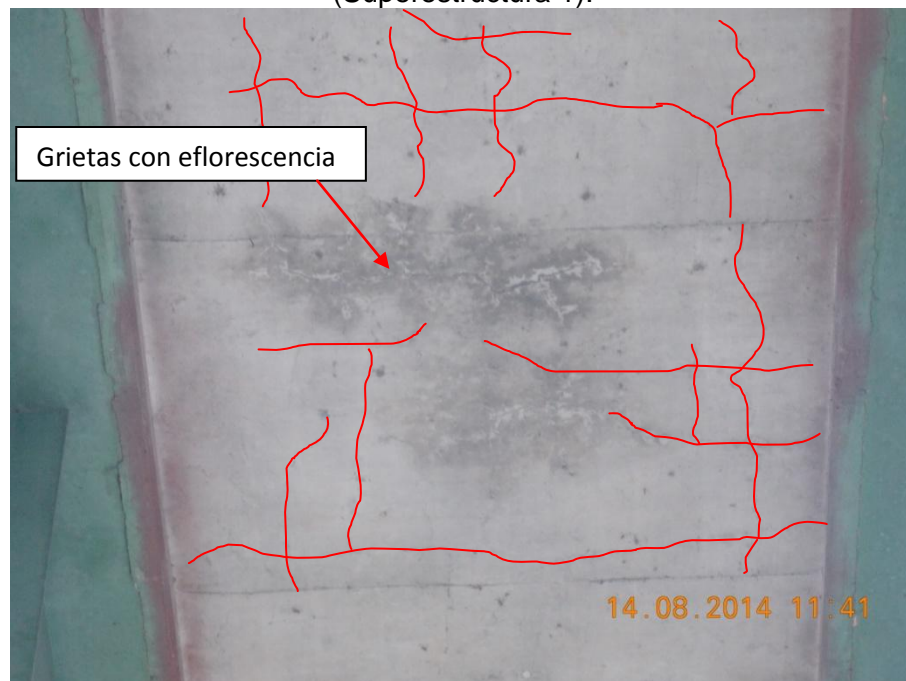
Figura 12: Agrietamiento típico en dos direcciones y eflorescencia en la superficie inferior de la losa de concreto de la superestructura 1.
