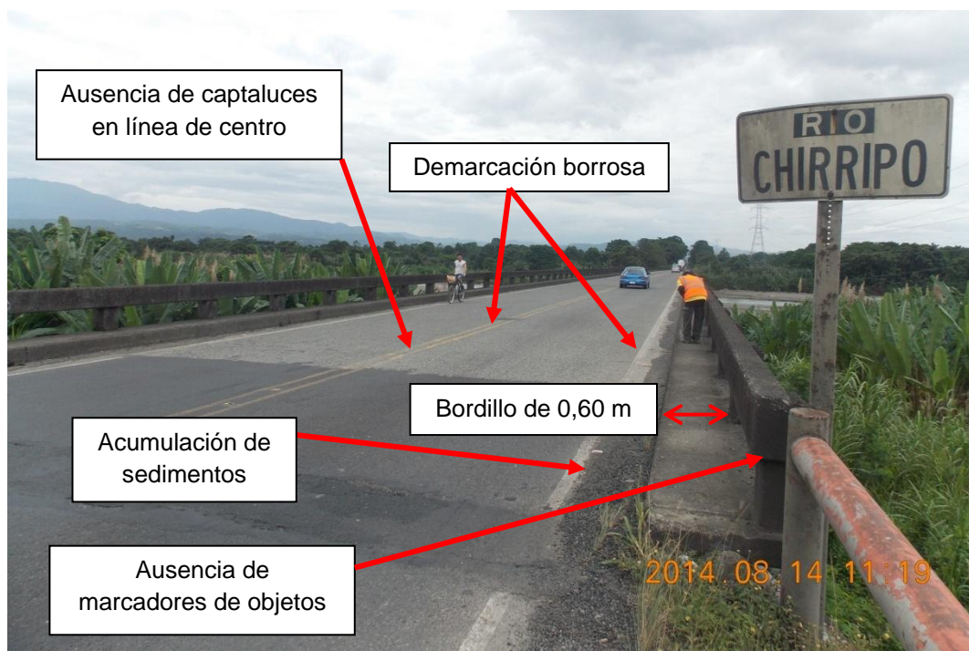
Figura 4: Rótulo, ausencia de captaluces, demarcación borrosa y acumulación de sedimentos en el bordillo.
