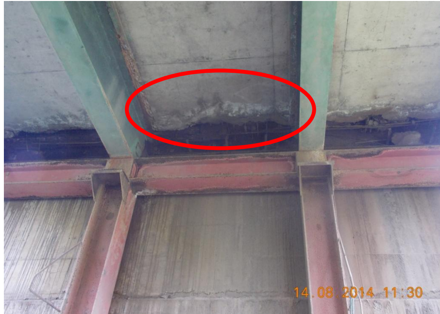
Figura 7: Desprendimientos de concreto y acero de refuerzo expuesto en la losa cerca de la junta de expansión entre las superestructuras 1 y 2
