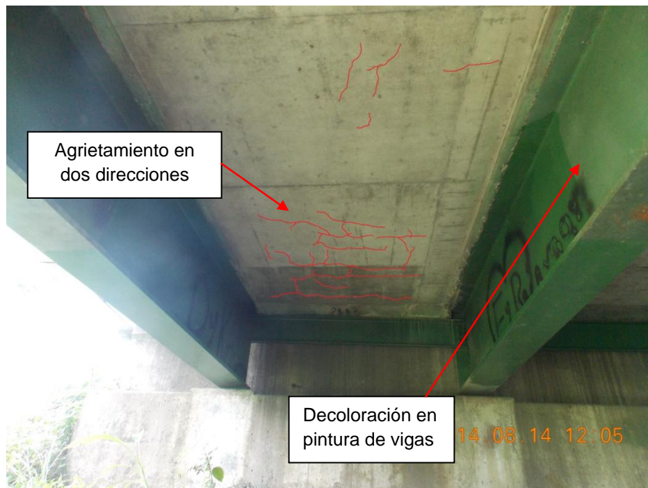
Figura 18: Agrietamiento en dos direcciones en la losa de la superestructura 1 .
