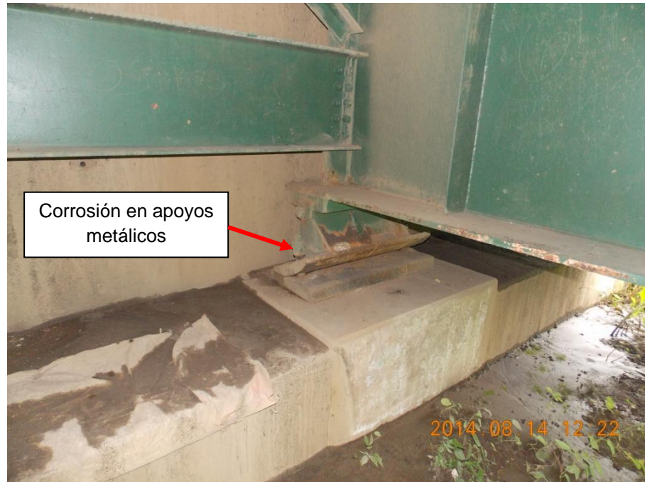
Figura 21: Apoyo expansivo tipo balancín sobre la pila 1 inclinado debido a sismo.
