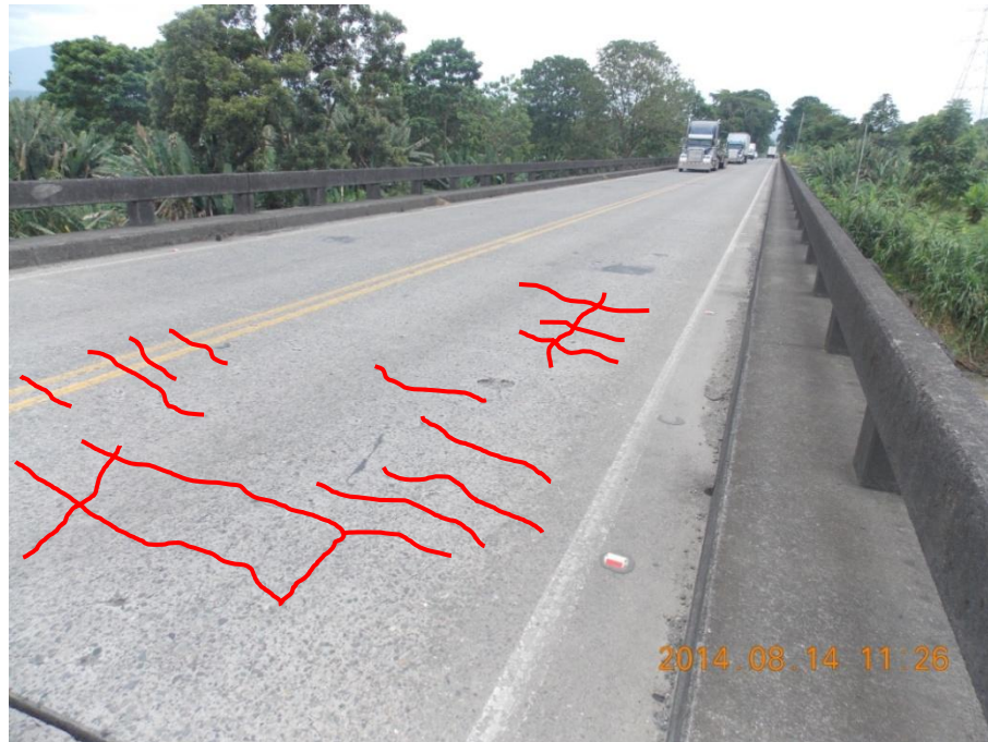
Figura 11: Agrietamiento típico en la superficie superior de la losa de concreto del puente (Superestructura 1).
