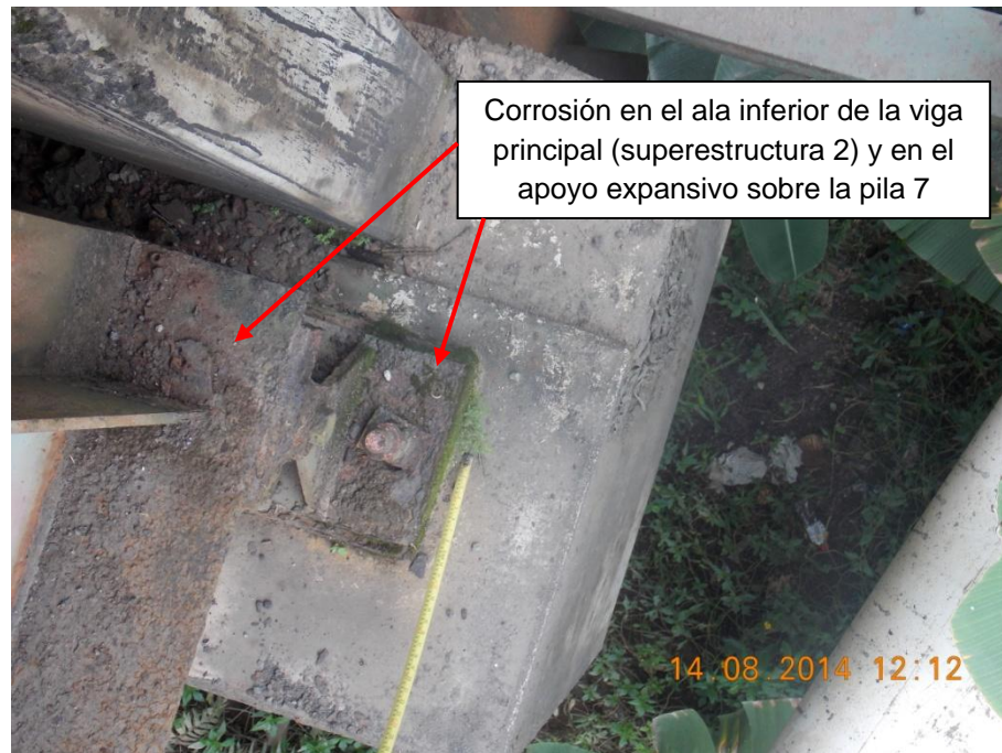
Figura 15: Vista superior de un apoyo sobre la pila 7 a través de la junta de expansión entre las superestructuras 1 y 2.
