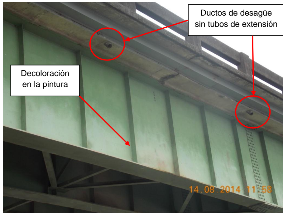
Figura 5: Detalle típico de ductos de drenaje sin tubos de extensión y decoloración de la pintura de las vigas principales de la superestructura 2.
