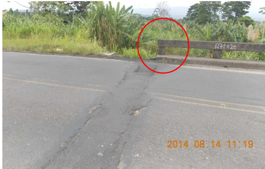
Figura 1: Barrera vehicular del acceso-este sin remate, junta de expansión obstruida con material asfáltico y ausencia de guardavías en acceso este.
