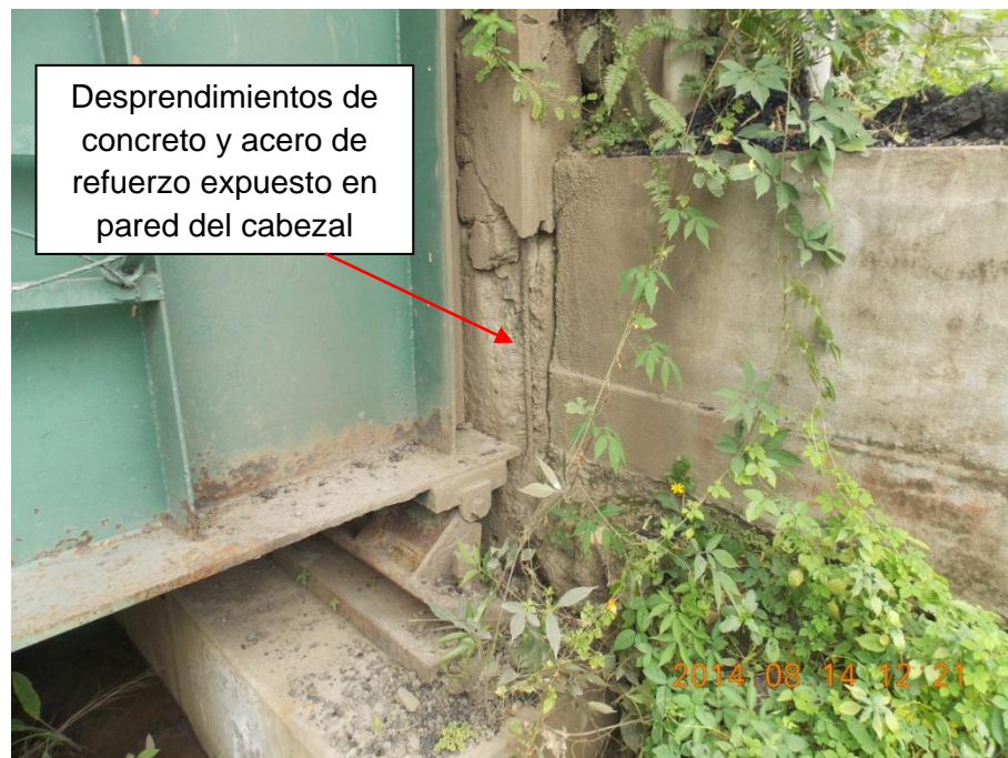
Figura 23. Desprendimientos de concreto y acero de refuerzo expuesto en la pared del cabezal del lado sur de la pila 1.
