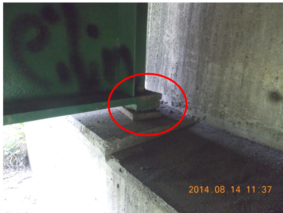
Figura 22. Apoyo desplazado de la superestructura 2 sobre el bastión 2.
