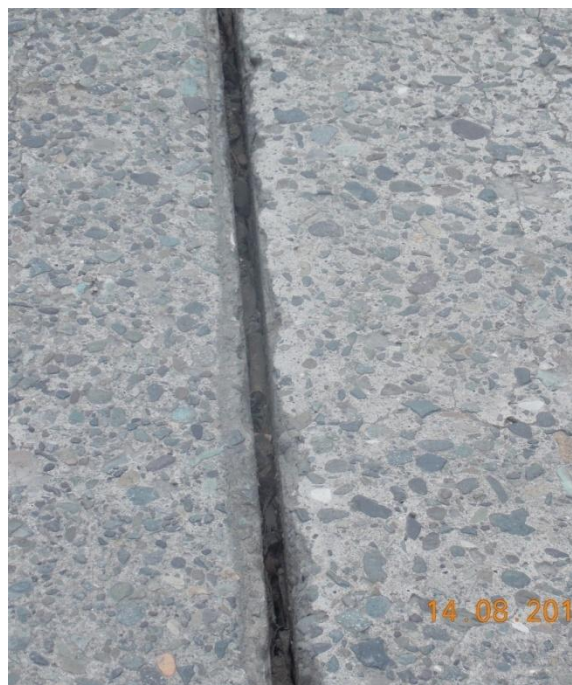
(b) Acercamiento de la junta de losa con deficiencias en el sello impermeable
