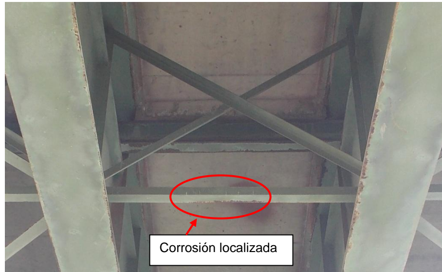
Figura 17: Detalle típico de decoloración de pintura y corrosión localizada en sistema de arriostramiento de la superestructura 1.
