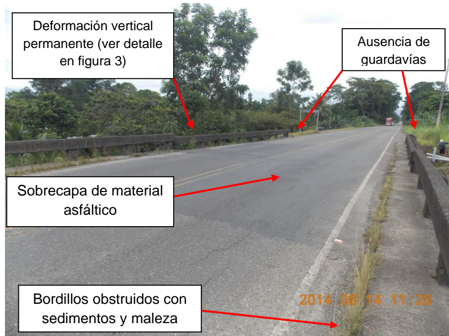
Figura 2: Vista superior de la superestructura 2 mostrando varias deficiencias.
