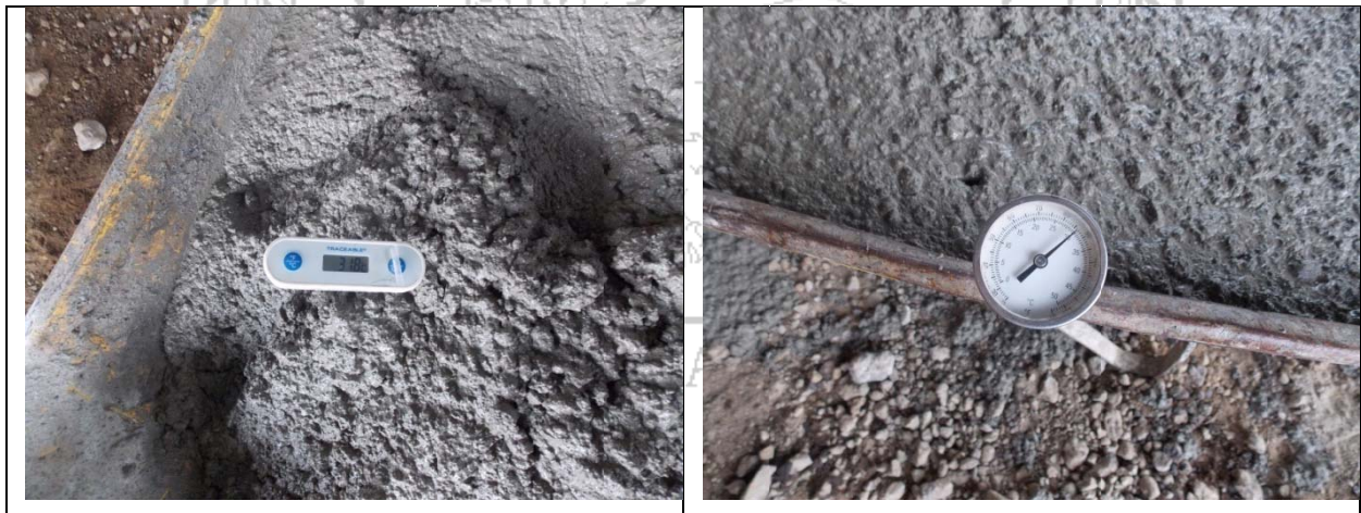
Figura 3 y Figura 4 . Toma de temperatura de colocación del concreto por parte del laboratorio de Autocontrol y Verificación de la calidad respectivamente.
