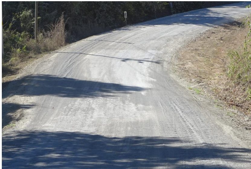
Figura 17. Material de secado no es barrido, crea superficie deslizante y se acumula en las orillas. Ruta Nacional 160, Tambor - Cóbano. Sección de Control 60813, Estacionamiento: 1+720 desde Tambor. Fecha: 31 ene 2019. Fuente: Unidad de Auditoría Técnica, LanammeUCR
