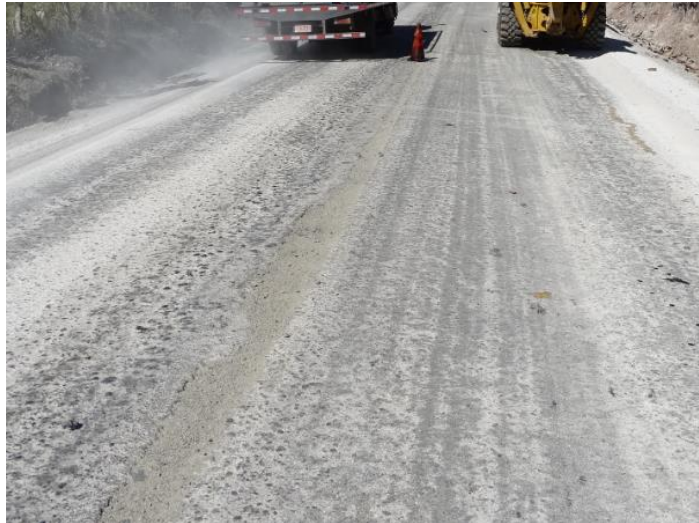
Figura 9. Deterioro leve en la junta longitudinal entre dos paños mejorados con cemento. Ruta Nacional 160, Tambor - Cóbano. Sección de Control 60813, Estacionamiento: 3+400 desde Tambor. Fecha: 31 ene 2019. Fuente: Unidad de Auditoría Técnica, LanammeUCR
