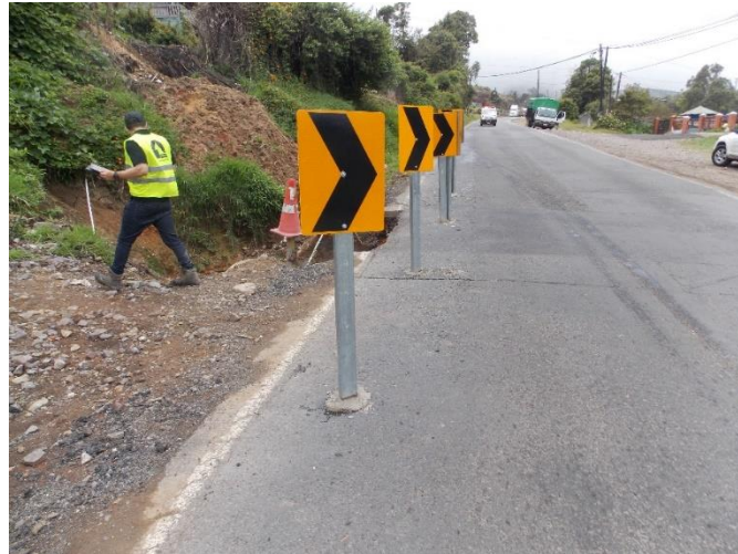
Figura 19. Pérdida de superficie de riego por inestabilidad lateral de material de relleno de tubería construida. Ubicación: Ruta Nacional 2, 6+800 del cruce de La Sierra (km 52+550). Sección de control 10042, La Sierra (R.222) – El Empalme (R.226). Fecha: 30 de abril de 2019. Fuente: Nota informe LM-IC-D-0311-19. Unidad de Auditoría Técnica, LanammeUCR.
