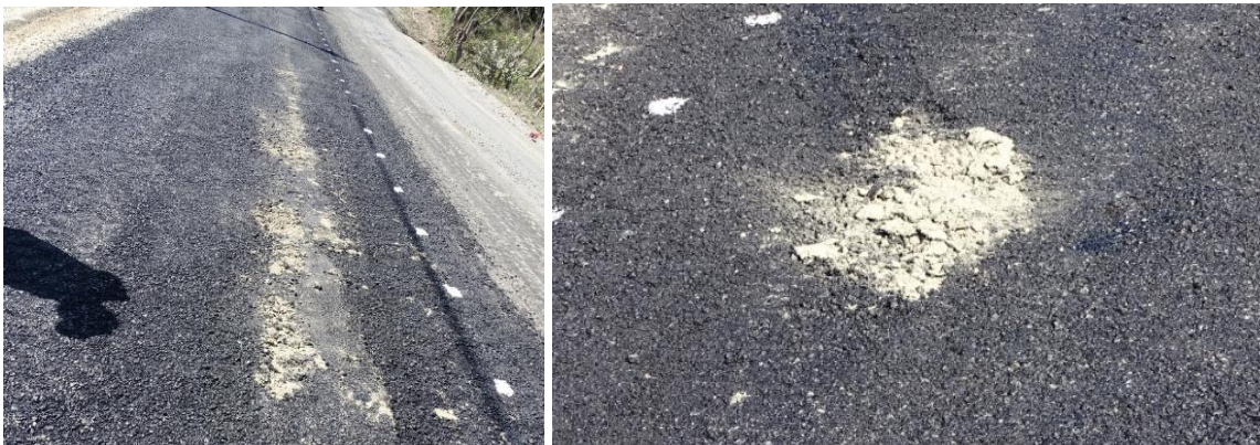
Figura 13. Material suelto bajo la capa de “traba” con mezcla asfáltica en paños mejorados con cemento. Ruta Nacional 160, Tambor - Cóbano. Sección de Control 60813, Estacionamiento: 3+900 desde Tambor. Fecha: 31 ene 2019. Fuente: Unidad de Auditoría Técnica, LanammeUCR.
