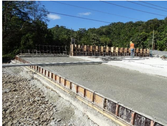
Figura 33. Colado de la losa de aproximación del lado de Paquera del puente sobre el Río Gigante. Fecha de la fotografía: 16/12/2019. Fuente: Lanamme, 2019
