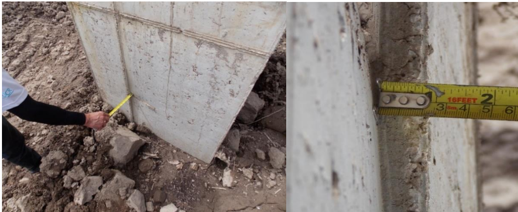
Figura 32. Desperfecto en la columna izquierda del bastión N° 2 del puente sobre el Río Gigante. Fecha de la fotografía: 27/06/2019. Fuente: Lanamme, 2019
