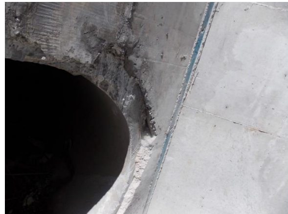
Figura 22. Desperfectos en el cabezal de la alcantarilla instalada en el km 3+902. Fecha de la fotografía: 18/09/2019. Fuente: LanammeUCR, 2019
