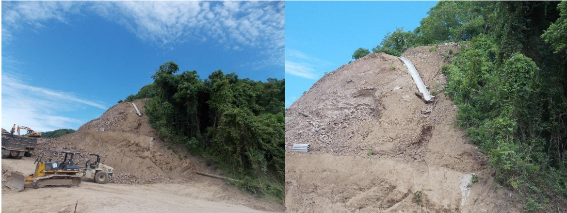
Figura 12. Erosión al final del tramo construido de la contracuneta instalada en la estación 12+700. Fecha de la fotografía: 27/06/2019. Fuente: LanammeUCR,2019
