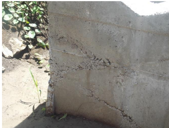
Figura 25. Nidos de piedra en el delantal y diente de la alcantarilla instalada en el km 5+258. Fecha de la fotografía: 18/09/2019. Fuente: LanammeUCR, 2019
