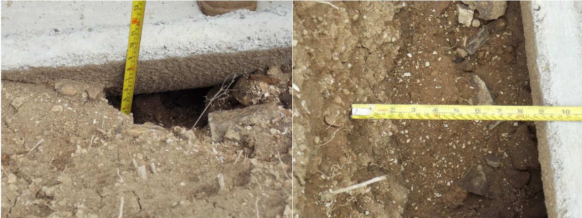
Figura 14. Erosión del suelo alrededor de la contracuneta instalada en el estacionamiento 19+050. Fecha de la fotografía: 27/06/2019. Fuente: LanammeUCR,2019
