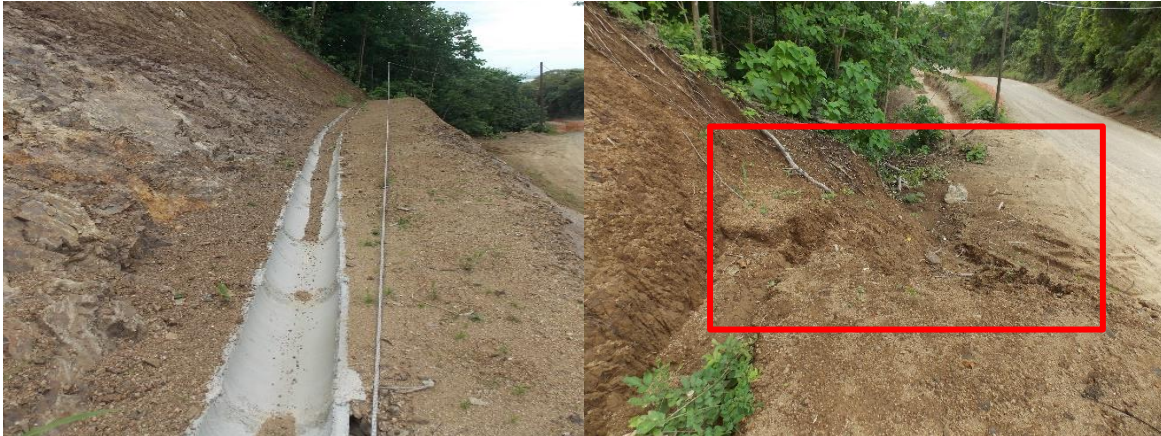
Figura 16. Colmatación de las contracunetas instaladas en el estacionamiento 19+050.
