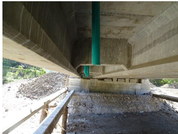
Figura 35. Tubos de los drenajes del puente sobre el Río Gigante.
