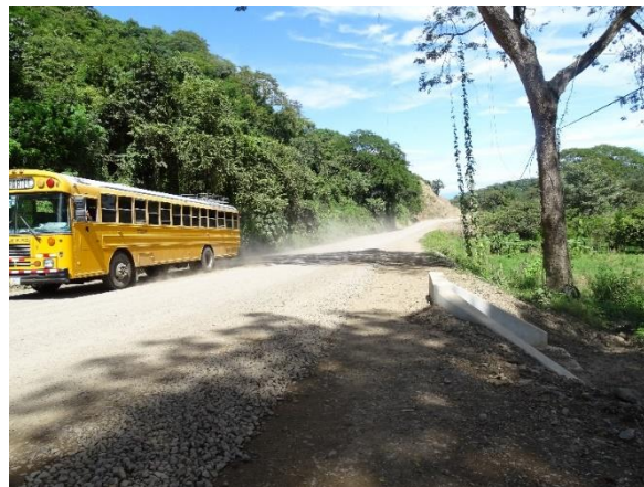
Figura 42. Cabezal de alcantarilla sin protección ni señalamiento preventivo.
