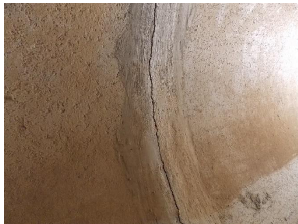
Figura 28. Agrietamientos en los sellos de unión internos de la alcantarilla instalada en el km 0+827.
