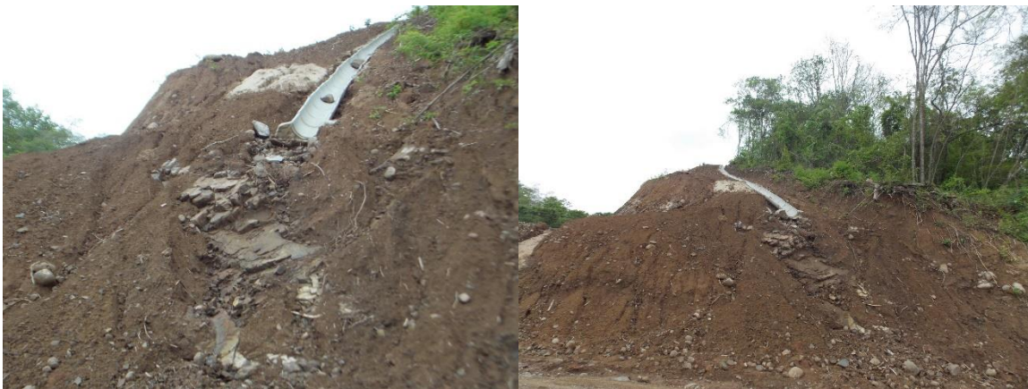
Figura 11. Erosión al final del tramo construido de la contracuneta instalada en la estación 11+850.
