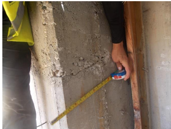
Figura 30. Nidos de piedra en la columna izquierda del bastión 2 del puente sobre el Río Gigante. Fecha de la fotografía: 18/09/2019. Fuente: LanammeUCR, 2019
