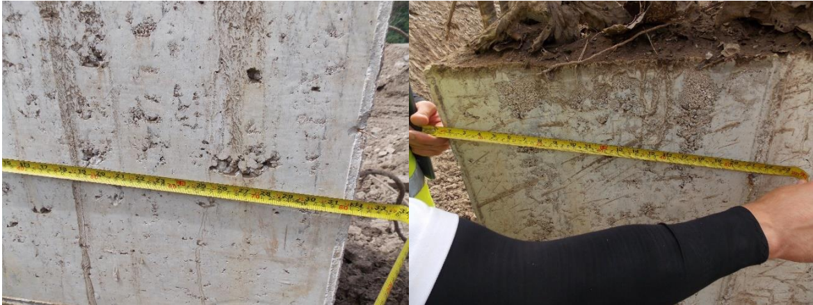
Figura 31. Nidos de piedra en la columna izquierda del bastión 2 del puente sobre el Río Gigante. Fecha de la fotografía: 27/06/2019. Fuente: Lanamme, 2019
