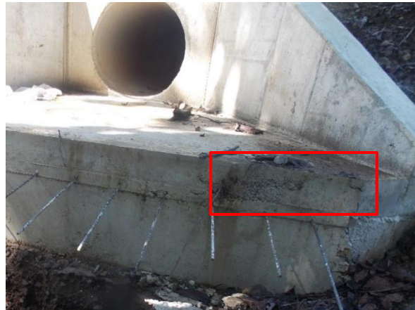
Figura 21. Nidos de piedra en el delantal y diente de la alcantarilla instalada en el km 0+707. Fecha de la fotografía: 18/09/2019. Fuente: LanammeUCR, 2019
