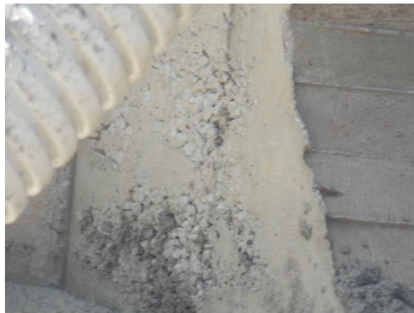
Figura 26. Nidos de piedra en el cabezal de la alcantarilla instalada en el km 8+613. Fecha de la fotografía: 18/09/2019. Fuente: LanammeUCR, 2019
