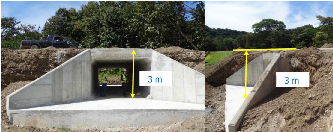
Figura 43. Desnivel mayor a 3 m sin señalamiento ni protección para los usuarios.
