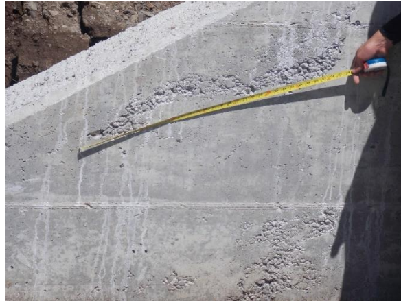
Figura 24. Nidos de piedra en el aletón de la alcantarilla instalada en el km 5+258. Fecha de la fotografía: 18/09/2019. Fuente: LanammeUCR, 2019
