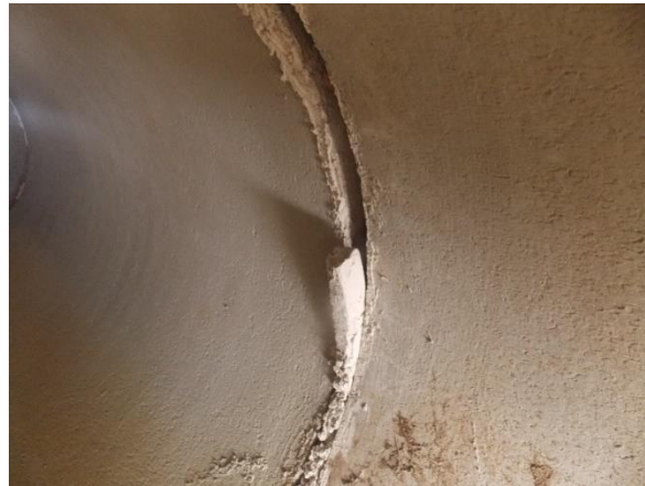
Figura 29. Desprendimiento del sello de unión interno en la alcantarilla instalada en el km 5+258. Fecha de la fotografía: 18/09/2019. Fuente: LanammeUCR, 2019
