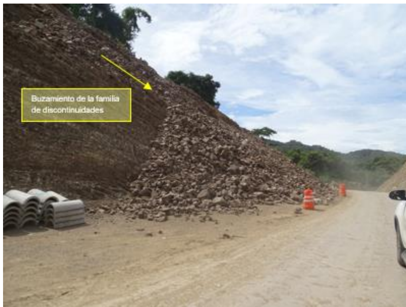
Figura 8. Falla del talud al lado derecho de la estación 12+202 Fecha de la fotografía: 06/11/2019. Fuente: LanammeUCR, 2019
