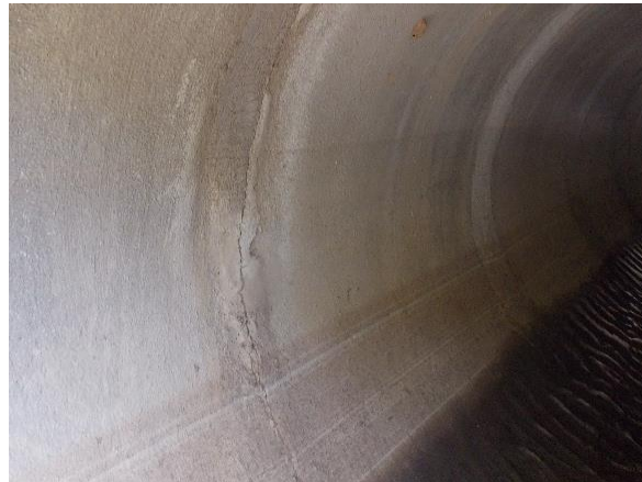
Figura 27. Agrietamientos en los sellos de unión internos de la alcantarilla instalada en el km 0+707.
