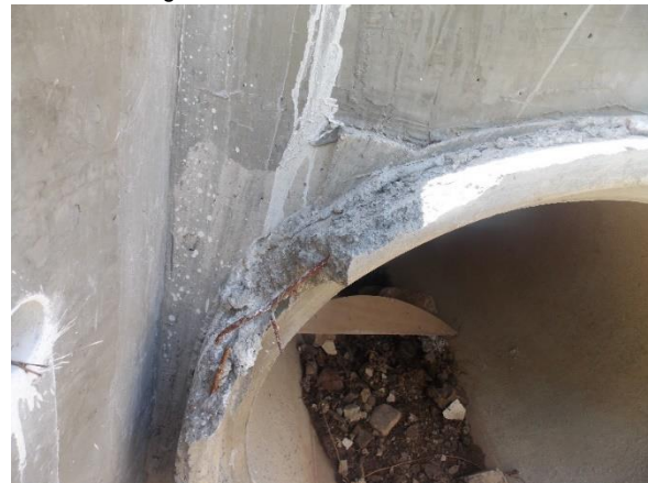
Figura 23. Acero expuesto en la toma de aguas de la alcantarilla instalada en el km 5+258. Fecha de la fotografía: 18/09/2019. Fuente: LanammeUCR, 2019
