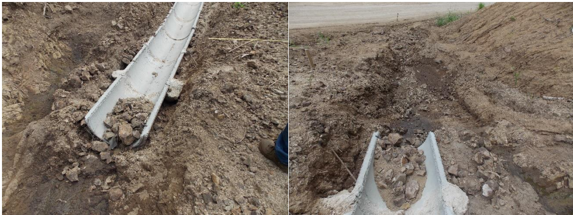
Figura 13. Erosión al final del tramo construido de la contracuneta instalada en la estación 19+050. Fecha de la fotografía: 27/06/2019. Fuente: LanammeUCR,2019
