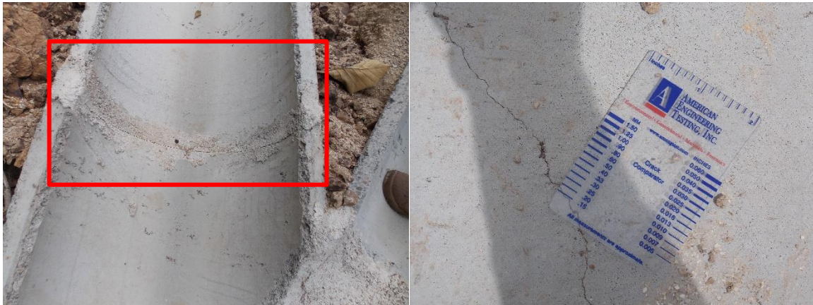
Figura 15. Deterioros en las contracunetas instaladas en el estacionamiento 19+050.
