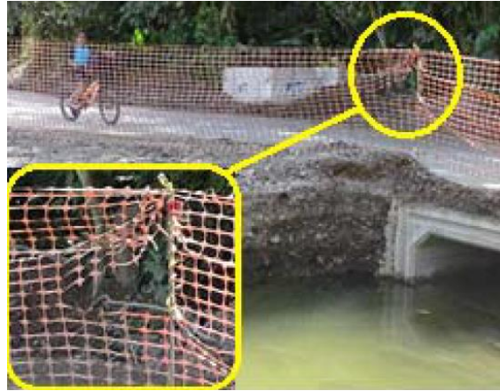
Figura 37. Malla deteriorada y con exceso de polvo. Fecha de la fotografía: 18/11/2019. Fuente: Lanamme, 2019
