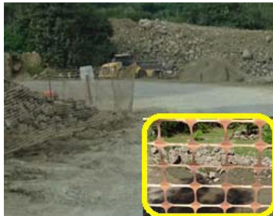
Figura 36. Malla con exceso de polvo.
