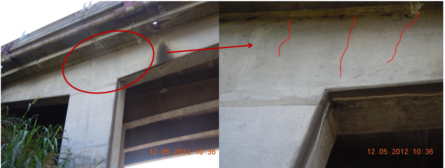
Figura 21: Grietas por flexión en vigas principales del paso inferior
