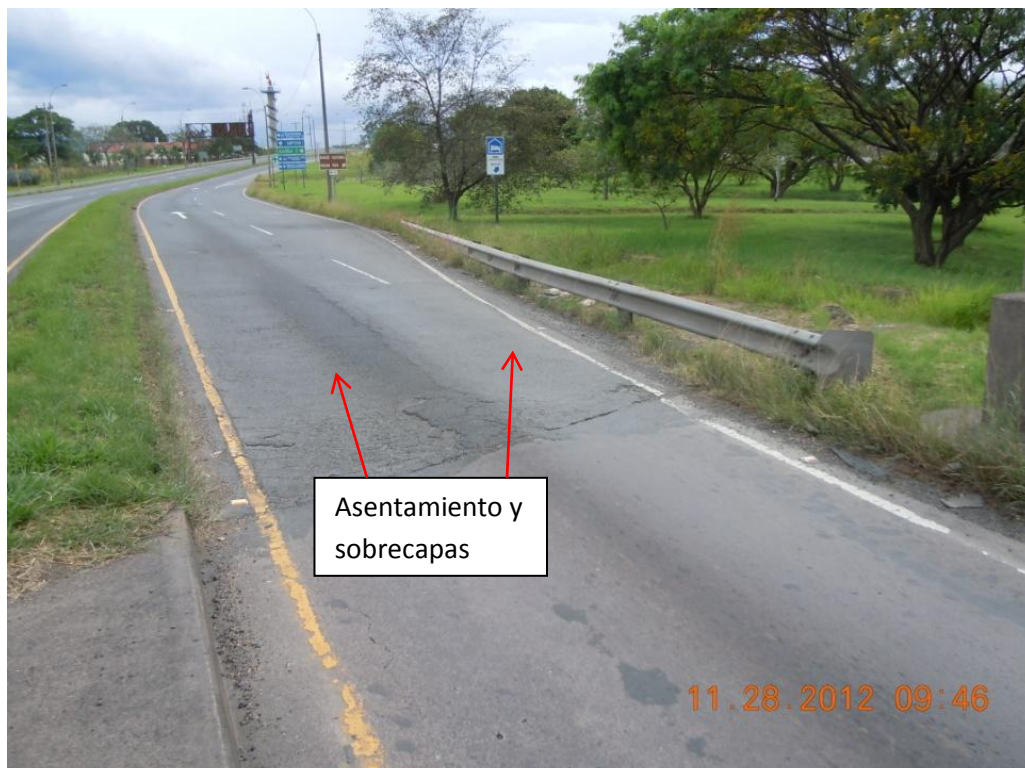
Figura 12: Asentamiento y sobrecapas de asfalto en el acceso este. Sentido San Ramón-San José
