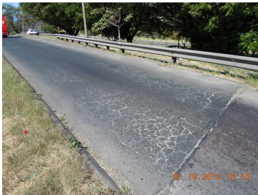
Figura 11: Agrietamiento tipo “cuero de lagarto” en la superficie de rodamiento en el acceso oeste. Sentido San José-San Ramón
