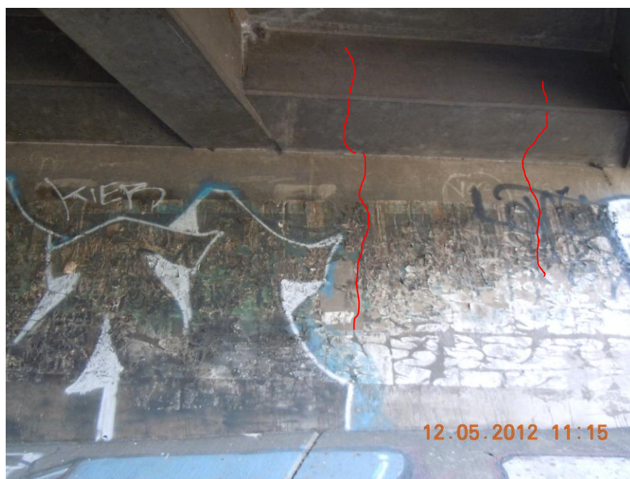
Figura 23: Grietas verticales en viga pantalla del acceso oeste
