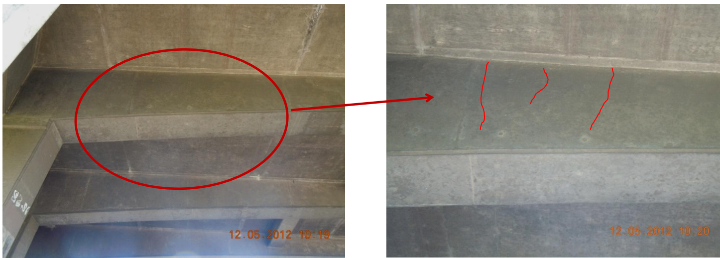
Figura 22: Grietas por flexión en vigas principales del paso inferior
