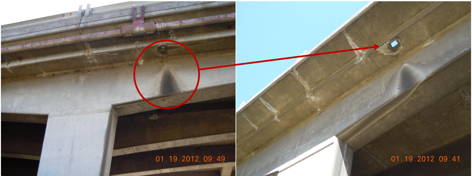
Figura 14: Ausencia de tubos de extensión en los drenajes del que impidan el contacto del agua con las vigas principales y que pueda caer sobre los vehículos
