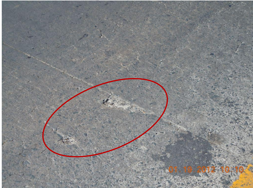
Figura 18: Evidencia de desprendimiento del concreto de la losa
