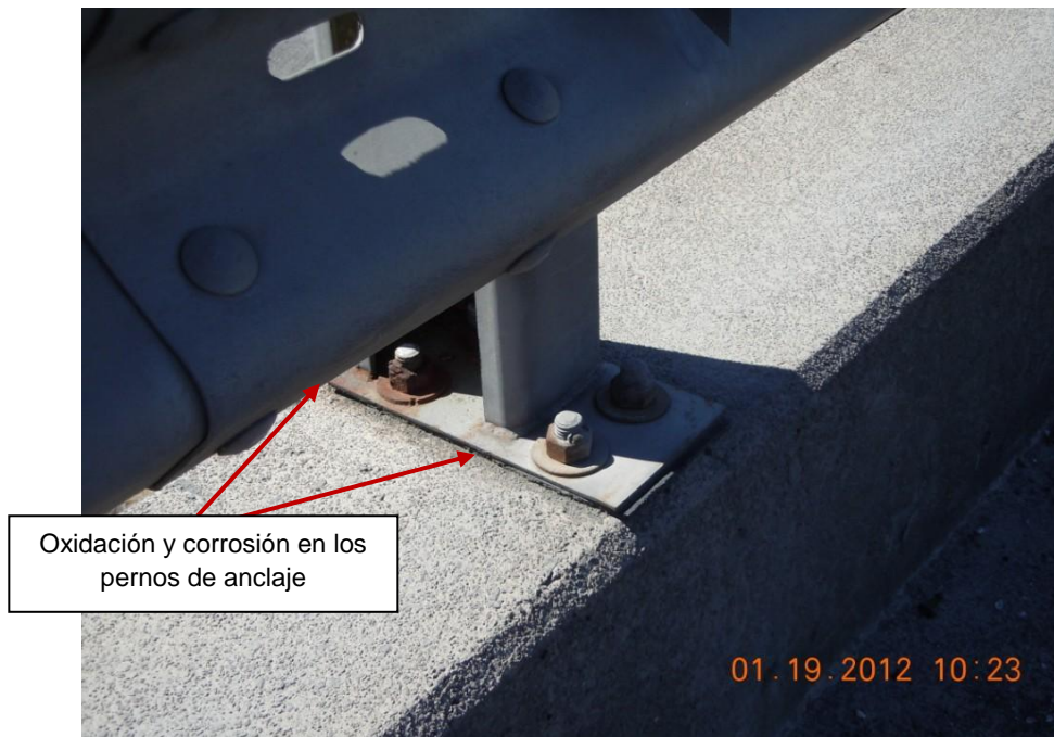
Figura 5: Oxidación y corrosión observada en los pernos de anclaje de las barandas.
