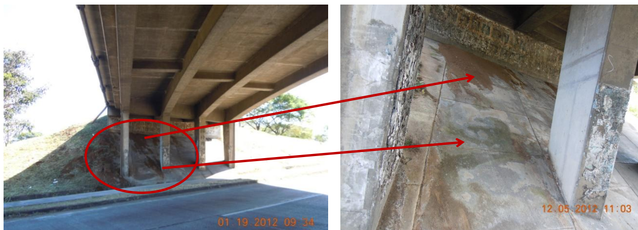
Figura 25: Suelo acumulado debido a nidos de hormigas, humedad y vegetación acumulados sobre la protección del talud
