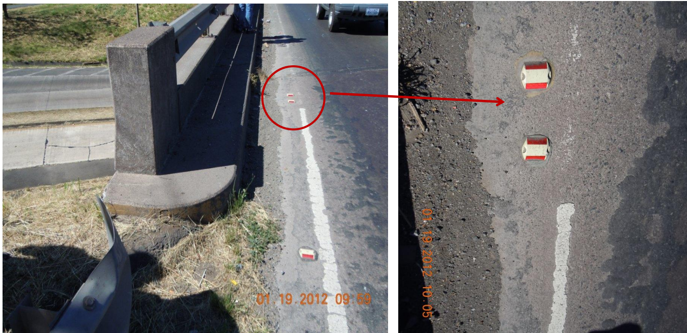
Figura 8: Demarcación horizontal borrosa y colocación inadecuada de captaluces
