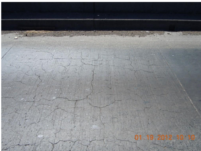
Figura 17: La superficie superior de la losa exhibe agrietamiento en dos direcciones
