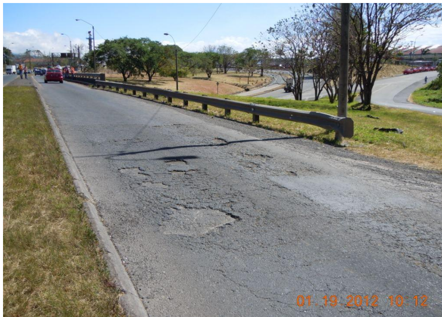
Figura 10: Carpeta asfáltica en mal estado en el acceso oeste. Sentido San Ramón-San José
