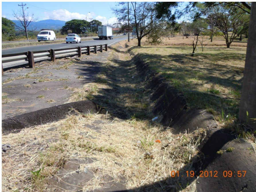
Figura 9: Vegetación y basura acumulada en los drenajes de los accesos
