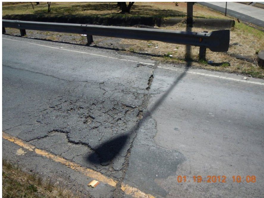
Figura 16: Junta rígida obstruida entre el pavimento y la losa de aproximación del acceso Este Sentido San Ramón – San José
