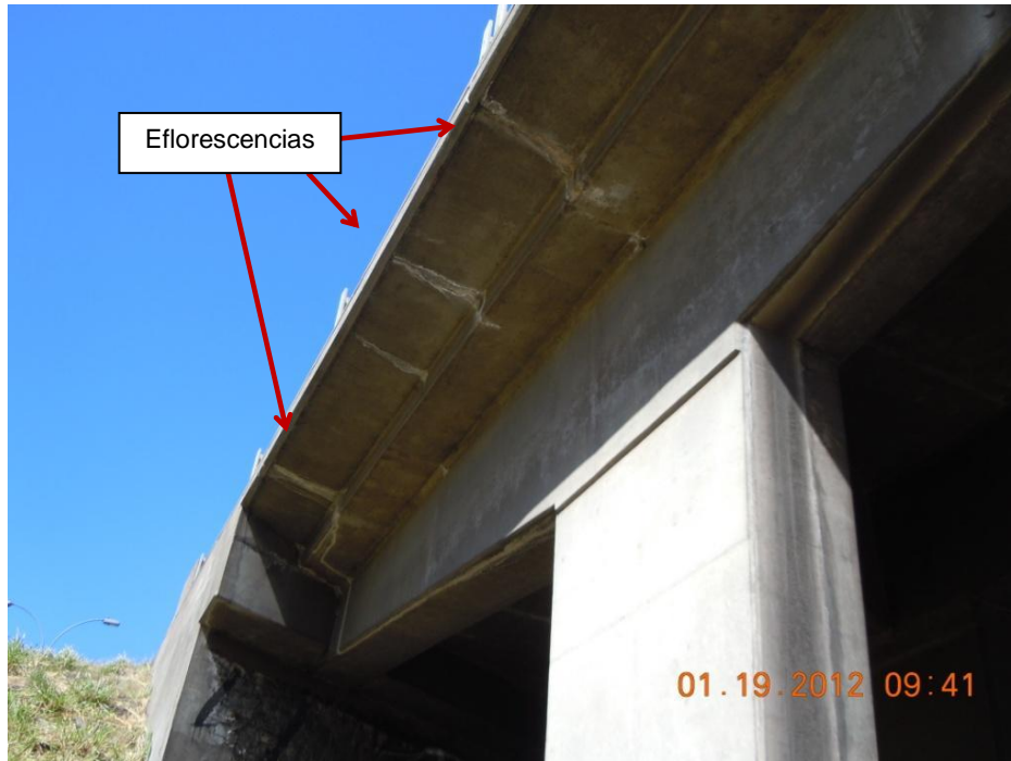
Figura 20: Eflorescencias existentes a lo largo de grietas en la superficie inferior de la losa en la zona de las aceras
