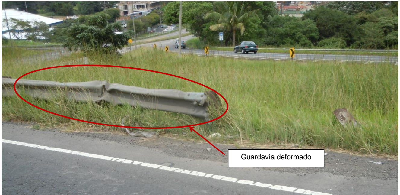
Figura 6: Guardavías deformados (guardavías norte, acceso oeste. Sentido San José-San Ramón)
