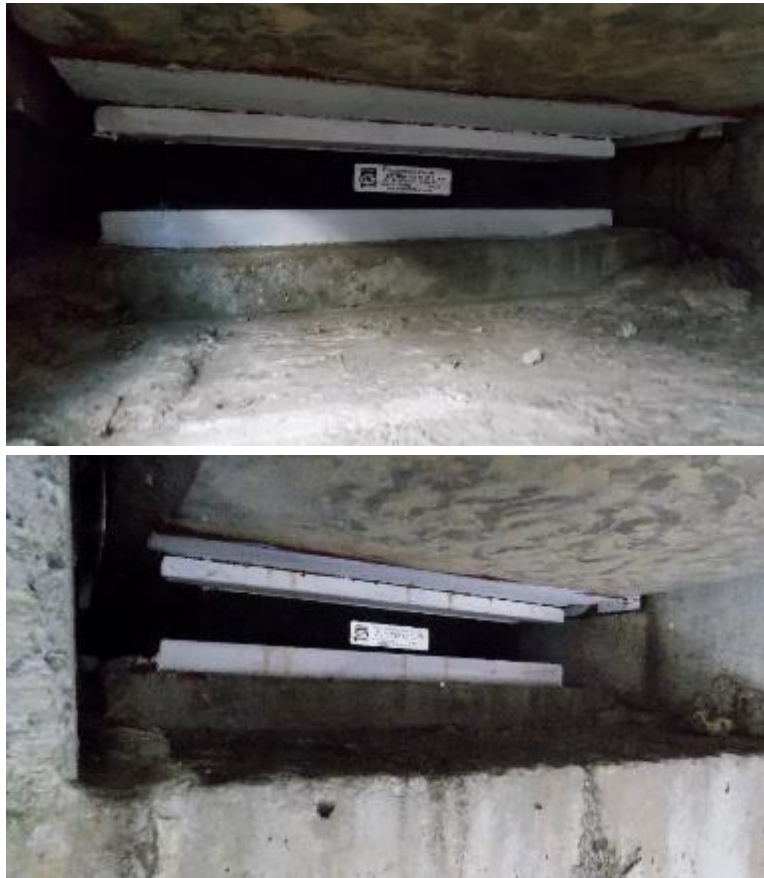
Figura 64. Reparaciones aparentes en los apoyos del puente río Peje(E5) en Florencia. Fecha de la fotografía: 27 de marzo 2019. Fuente: LanammeUCR.
