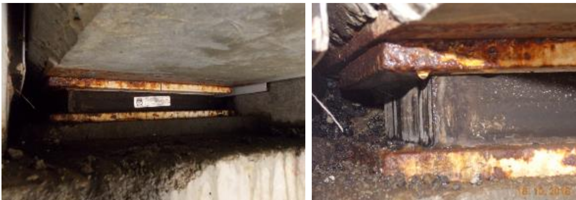
Figura 62. Condición de oxidación en algunos apoyos en bastión de puente río Peje(E6). Fecha de la fotografía 18 de octubre 2018. Fuente: LanammeUCR.
