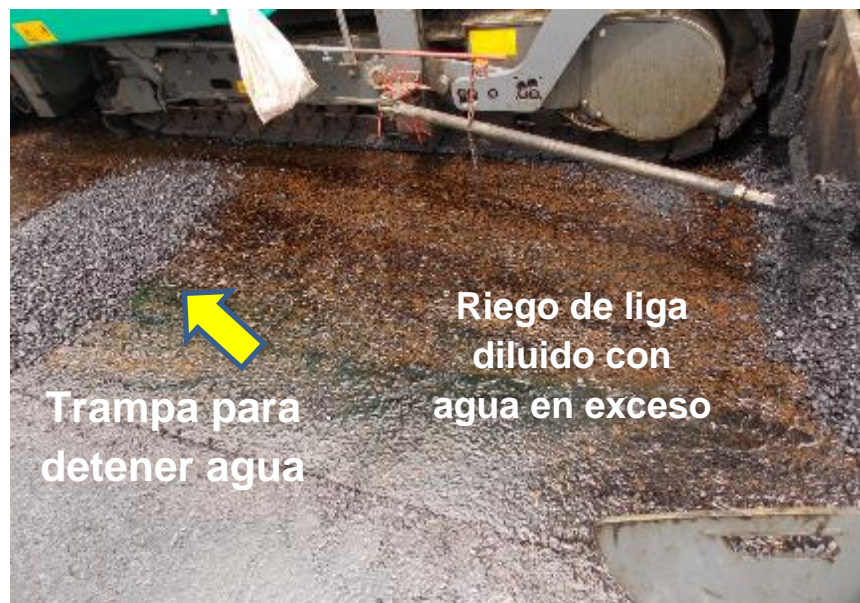
Figura 45. Colocación de mezcla asfáltica sobre riego de liga afectado por lluvia. Estacionamiento 40+700.
