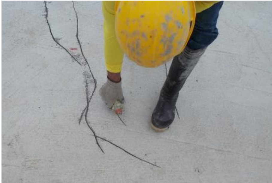
Figura 57. Colocación por gravedad del material de relleno de grietas en la losa E-2. Fecha de la fotografía 07-06-2018. Fuente: LanammeUCR.
