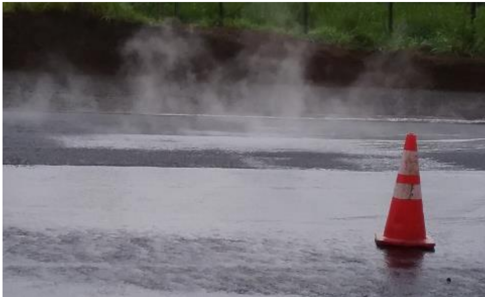
Figura 47. Agua acumulada dentro de la mezcla asfáltica sin compactar. Estacionamiento 40+650. Fecha de la fotografía 29-jun-2018. Fuente: LanammeUCR.
