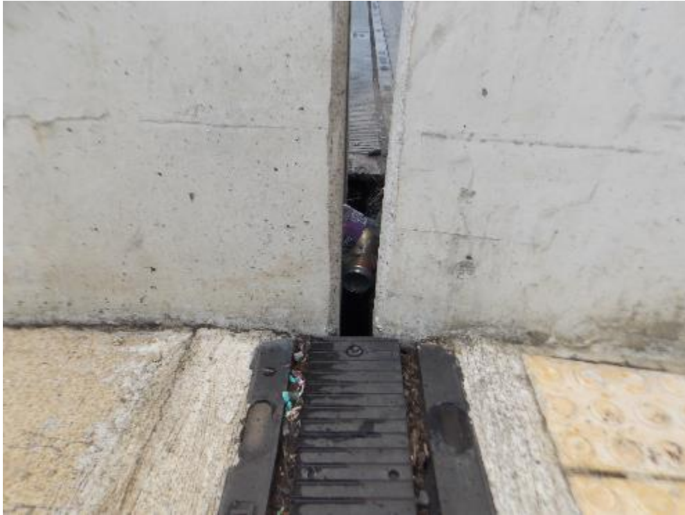
Figura 66. Discontinuidad y acumulación de basura en la junta de expansión del puente río Peje (E5) en Florencia. Fecha de la fotografía 10 de mayo de 2019. Fuente: LanammeUCR.
