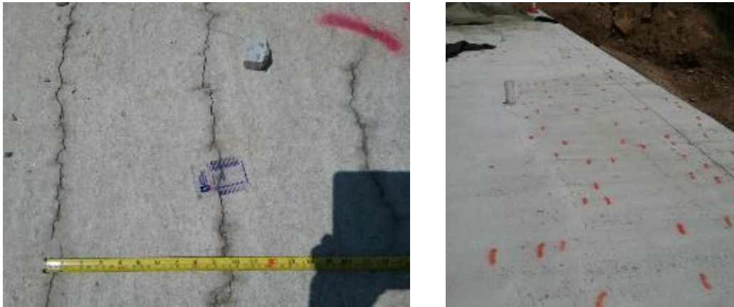
Figura 54. Agrietamientos en losa del puente sobre río Peje (E-2). Fecha 09 de mayo de 2018. Fuente: LanammeUCR
