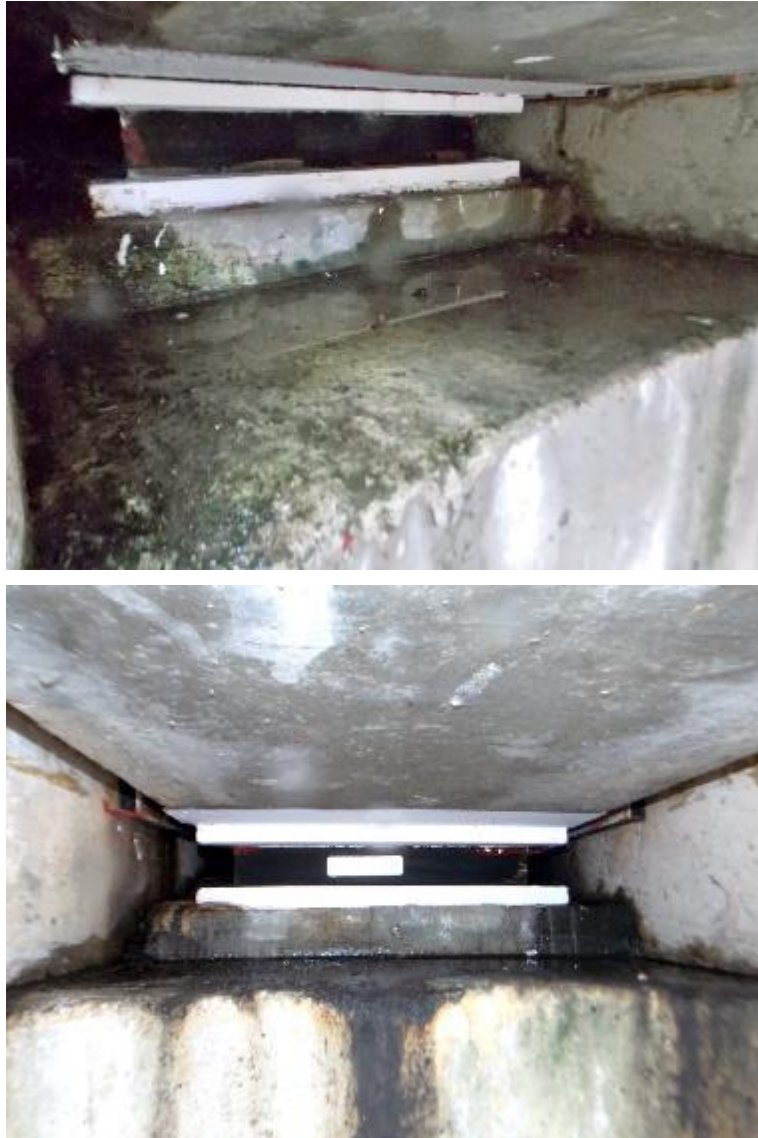
Figura 65. Acumulación de agua y corrosión en algunos apoyos del puente río Peje(E5) en Florencia.
