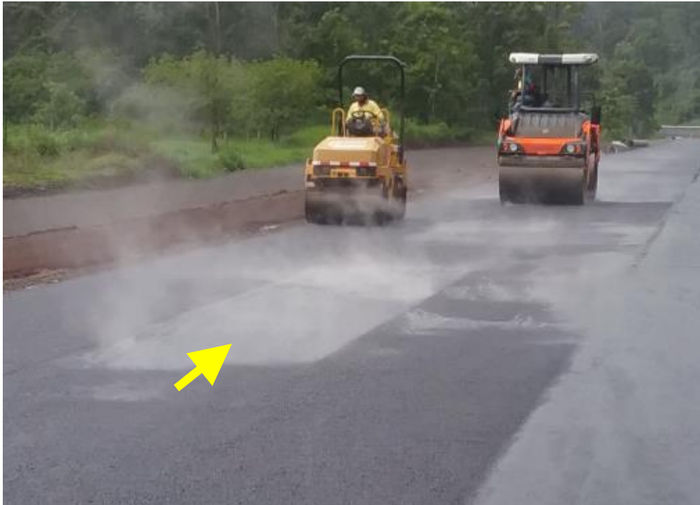
Figura 48. Compactación evidenciaba una cantidad considerable de agua que salía de la mezcla. Estacionamiento 40+650.
