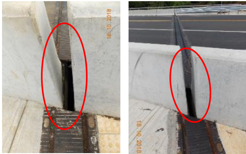
Figura 63. Discontinuidad de junta de expansión en barrera tipo “New Jersey” que divide la calzada de la acera peatonal. Puente Quebrada San Pedro y río Peje (E1 y E2 respectivamente). Fecha de la fotografía 18 de octubre 2018. Fuente: LanammeUCR.
