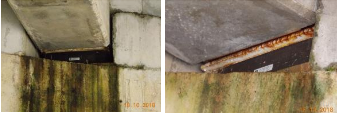
Figura 60. Condición de apoyos en bastión de puente Río Peje No. 1 (E2). Fecha de la fotografía 18 de octubre 2018. Fuente: LanammeUCR.
