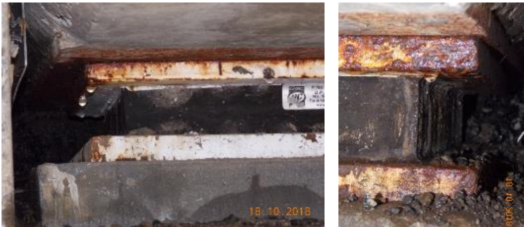
Figura 61. Condición de apoyos en bastión de puente río Peje (E5). Fecha de la fotografía 18 de octubre 2018. Fuente: LanammeUCR.
