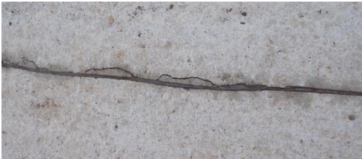
Figura 58. Grieta rellenada parcialmente con el material de sellado. Fecha de la fotografía 7 de junio de 2018. Fuente: LanammeUCR
