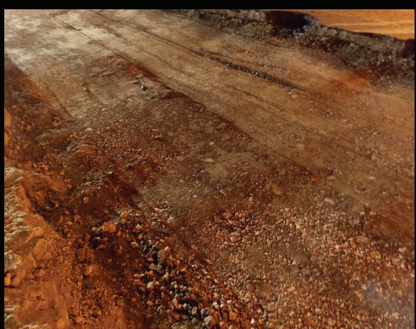
Subbase contaminada y mal compactada
