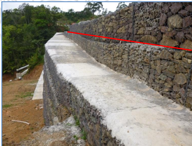
Fotografías N°2 y 3. Deformaciones en la fachada del muro de contención.
