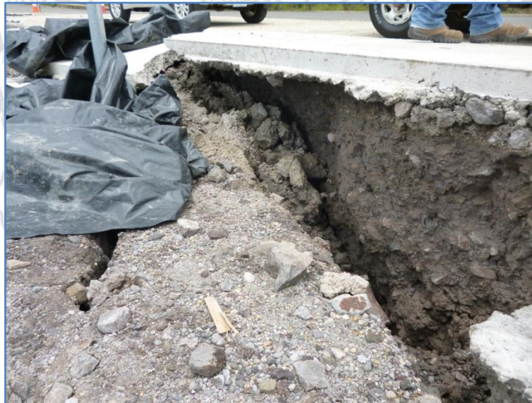
Fotografías N°6 y 7. Grieta en el relleno de la parte posterior del muro.
