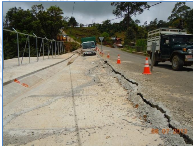
Fotografías N°8 y 9. Grieta cercana a la calzada en la parte posterior del muro.
