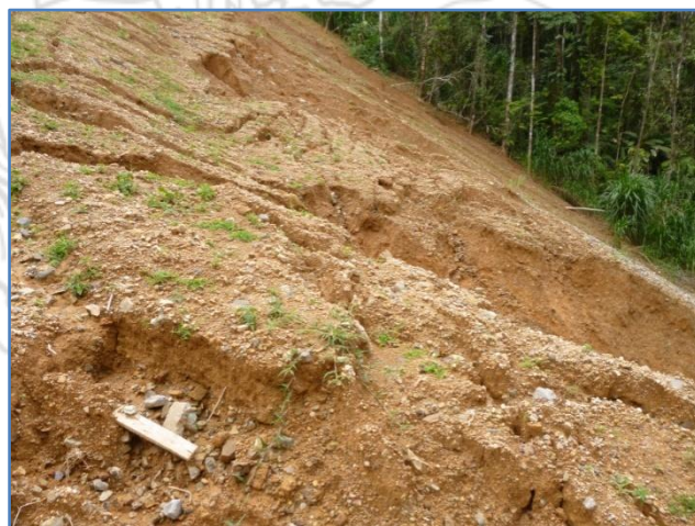
Fotografías N°10 y 11. Condición del relleno colocado al pie del muro.
