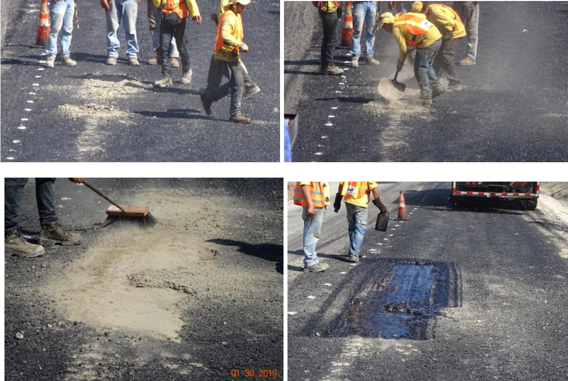
Figura 14. Reparación en zonas de material suelto observadas en paños mejorados con cemento. Ruta Nacional 160, Tambor - Cóbano. Sección de Control 60813, Estacionamiento: 3+900 desde Tambor. Fecha: 31 ene 2019. Fuente: Unidad de Auditoría Técnica, LanammeUCR
