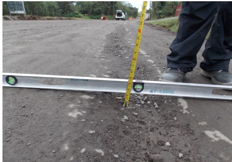
Figura 11. Ejemplo de deterioro en paño estabilizado en sentido San Ramón – Ángeles Norte. Ruta Nacional 702. Estacionamiento: 7+300. Fecha: 18 oct 2018. Fuente: Nota informe LM-PI-089-2018, Unidad de Auditoría Técnica, LanammeUCR
