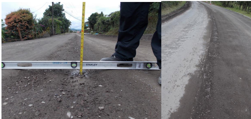
Figura 8. Ejemplo de rehabilitación con deterioro en la junta longitudinal entre dos paños estabilizados con cemento. Ruta Nacional 702, San Ramón – Ángeles Norte. Estacionamiento: 7+500. Fecha: 18 oct 2018. Fuente: Nota informe LM-PI 089-2018. Unidad de Auditoría Técnica, LanammeUCR
