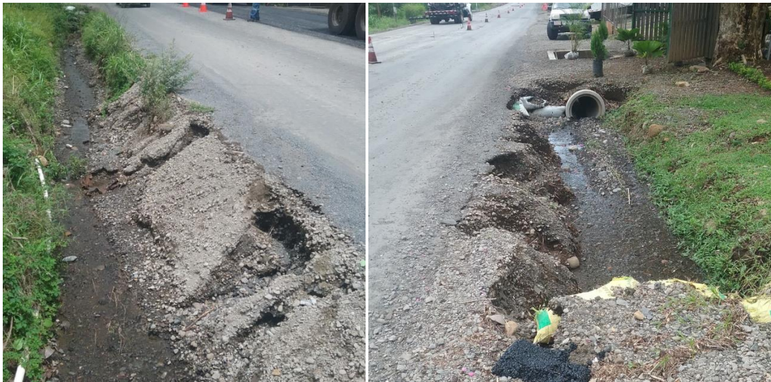
Figura 18. Ejemplo de condición de riesgo de las obras de rehabilitación por mala condición del drenaje. Ruta 751, Sección de control 20994, Los Chiles – Vuelta Kooper. Km 0+320. Fecha 31 de mayo 2018. Fuente: Informe LM-PI-AT-88-2018. Unidad de Auditoría Técnica, LanammeUCR.
