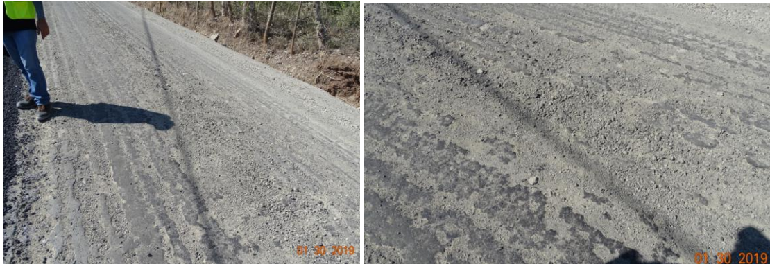
Figura 12. Deterioro superficial en paños mejorados con cemento. Ruta Nacional 160, Tambor - Cóbano. Sección de Control 60813, Estacionamiento: 3+900 desde Tambor. Fecha: 31 ene 2019. Fuente: Unidad de Auditoría Técnica, LanammeUCR
