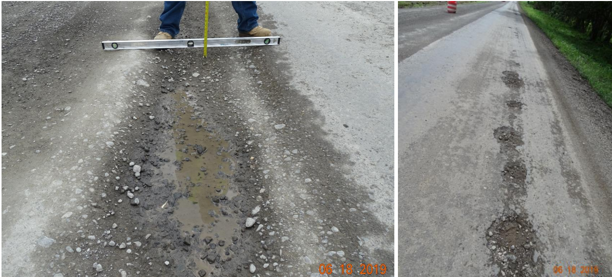
Figura 15. Base estabilizada con cemento con algunos ejemplos de deterioros encontrados. Ruta Nacional 4, San José Upala - Birmania. Sección de Control 21024, Estacionamientos: 169+550 y 165+660 respectivamente. Fecha: 18 de junio 2019. Fuente: Unidad de Auditoría Técnica, LanammeUCR.
