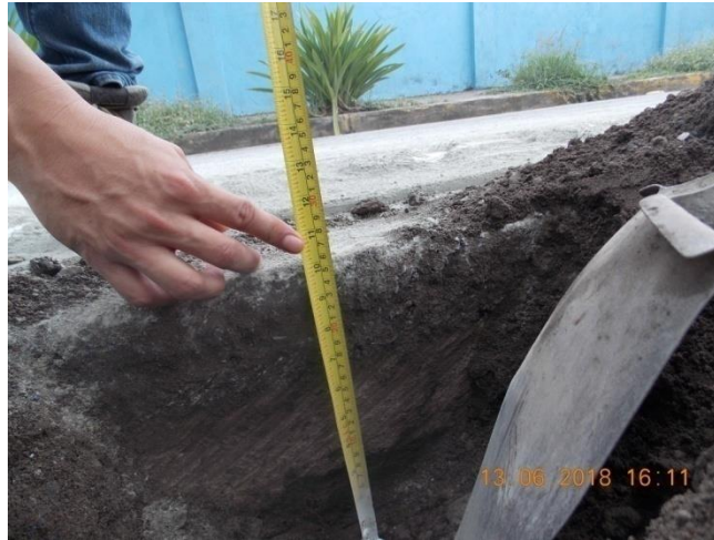
Figura 21. Caso sobre espesor recuperado 26 cm menor al requerido por presencia de tubería. Ubicación: Ruta Nacional 17, sección de control 60622 (Chacarita [plantel MOPT] – El Cocal [escuela]), km 7+540 desde el cruce con la Ruta Nacional 23. Fecha: 13 de junio de 2018. Fuente: Nota informe LM-PI-050-2018, LanammeUCR.
