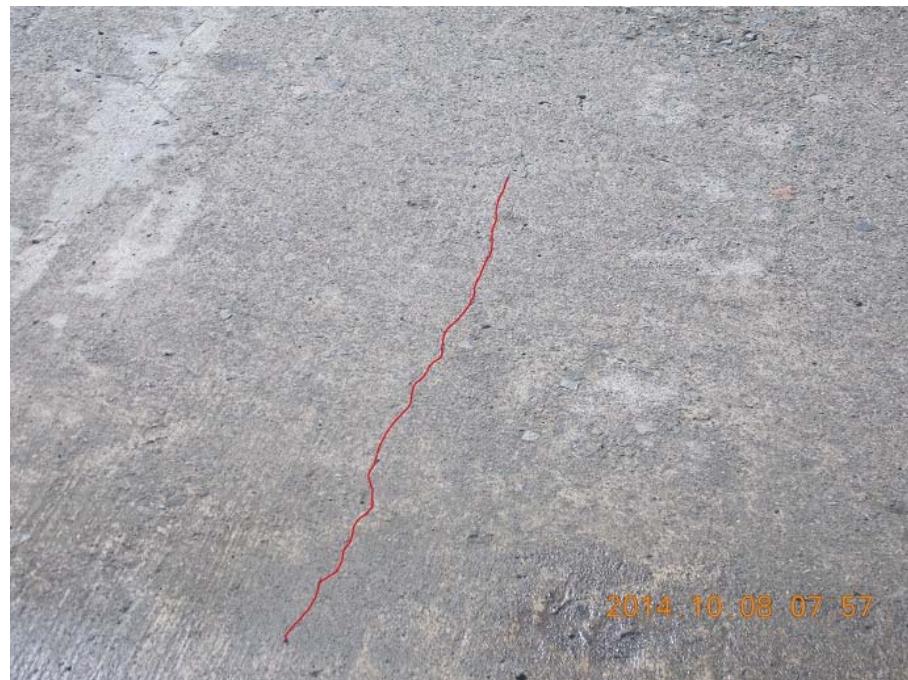
Figura 10: Agrietamiento en una dirección en la cara superior de la losa del tablero.
