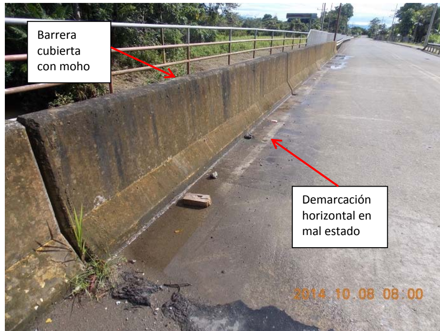
Figura 1: Barrera vehicular cubierta con moho y estado de la demarcación horizontal.
