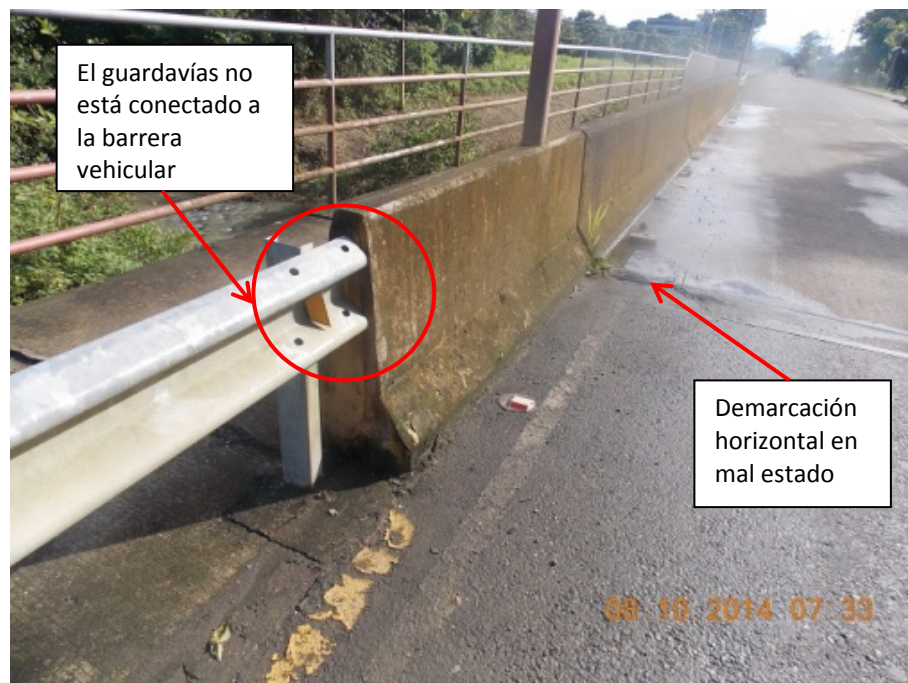
Figura 2: Guardavías sin anclaje a la barrera vehicular y estado de la demarcación horizontal.
