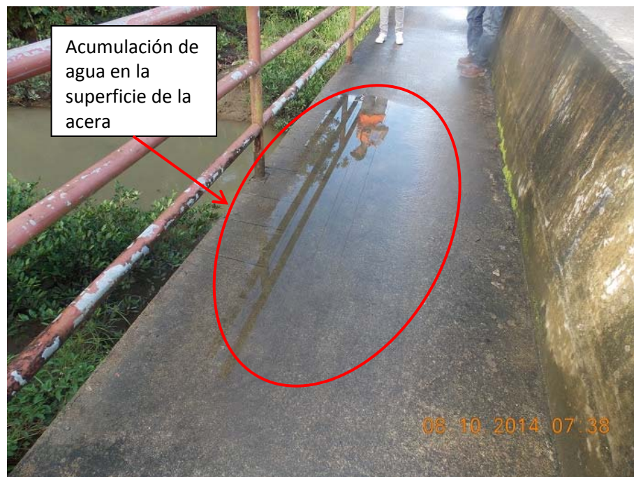
Figura 4: Acumulación de agua y crecimiento de moho en la superficie de la acera.
