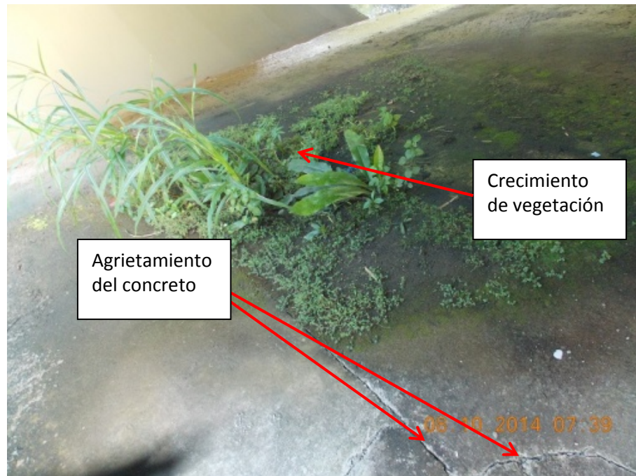
Figura 16: Agrietamiento y crecimiento de vegetación en revestimiento de concreto de taludes frente a los bastiones.
