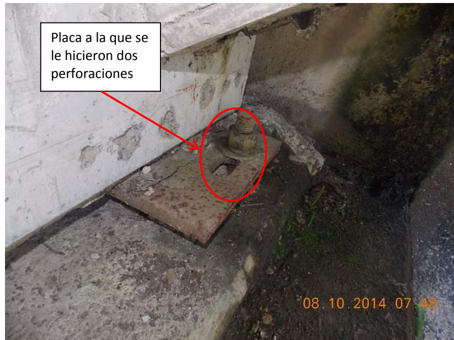
Figura 14: Placa de apoyo con una perforación sin utilizar.
