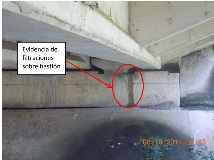
Figura 15: Evidencia de filtraciones sobre bastión.
