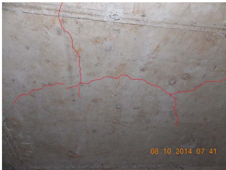
Figura 12: Agrietamiento en dos direcciones en la cara inferior de la losa del tablero.
