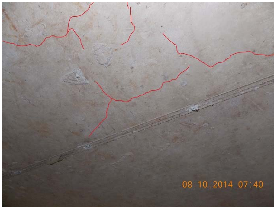
Figura 11: Agrietamiento en dos direcciones en la cara inferior de la losa del tablero.
