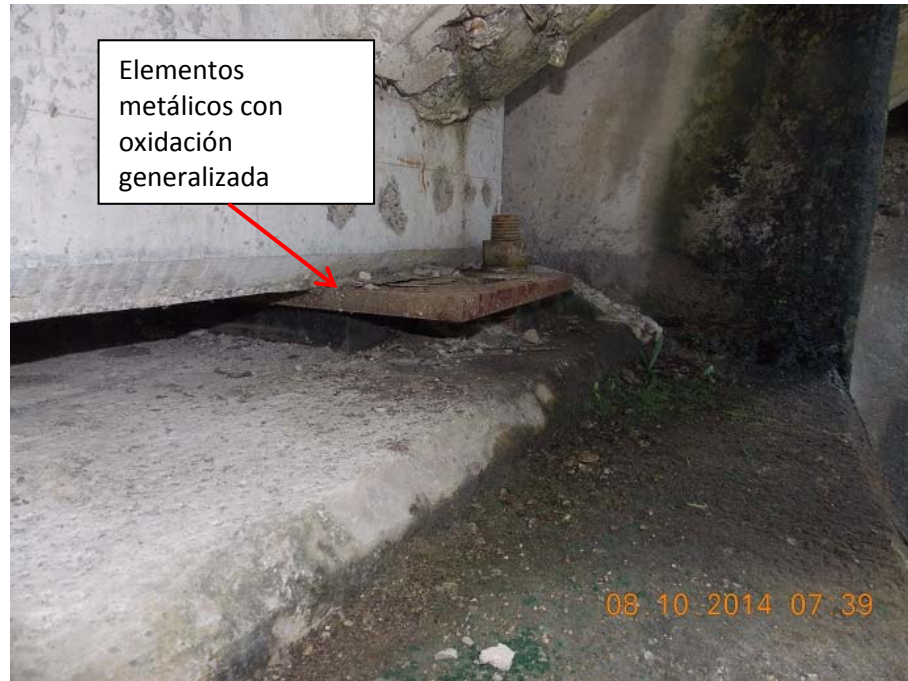
Figura 13: Apoyo en contacto con sedimentos y humedad.
