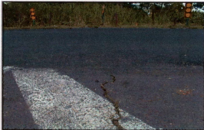
Fotografía 2: Detalle de agrietamiento en carpeta existente, en el proceso de recarpeteo se procura sanear estas condiciones severas de deterioro.
