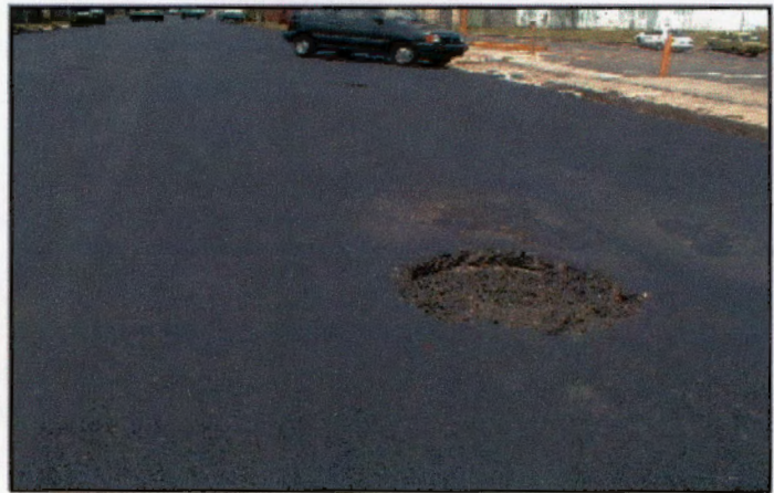
Fotografía 5: Deterioro de trabajos de recarpeteo por problemas de capacidad de alcantarillado.
