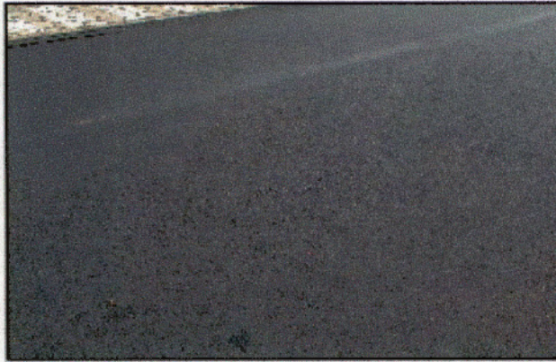
Fotografía 4: Problemas localizados de segregación a lo largo del tramo.
