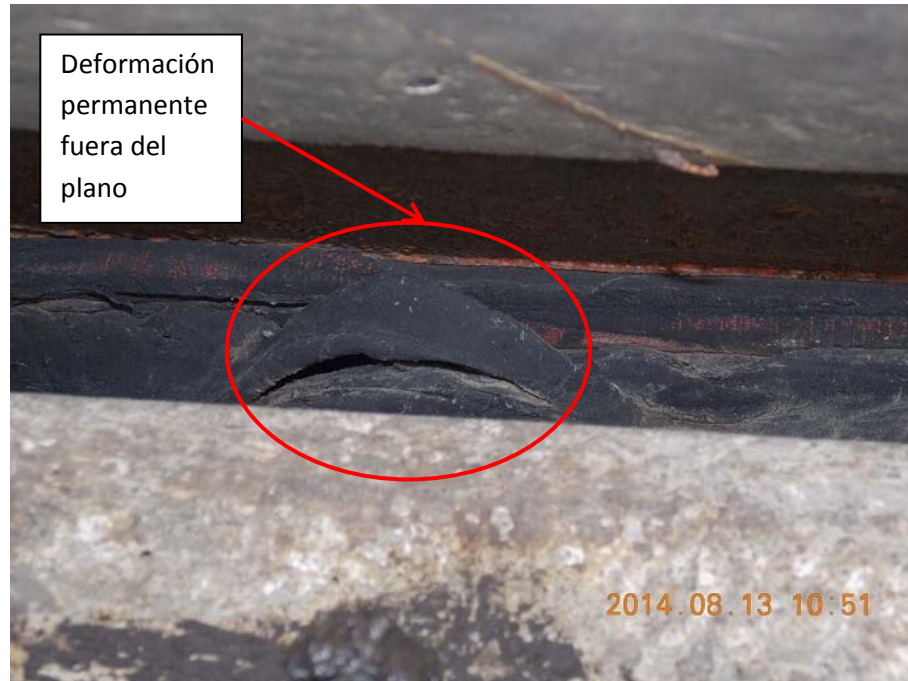
Figura 14: Detalle de daño en almohadilla de neopreno.
