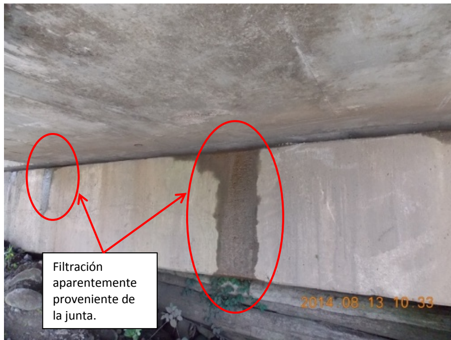
Figura 9: Filtraciones sobre el bastión del acceso oeste.
