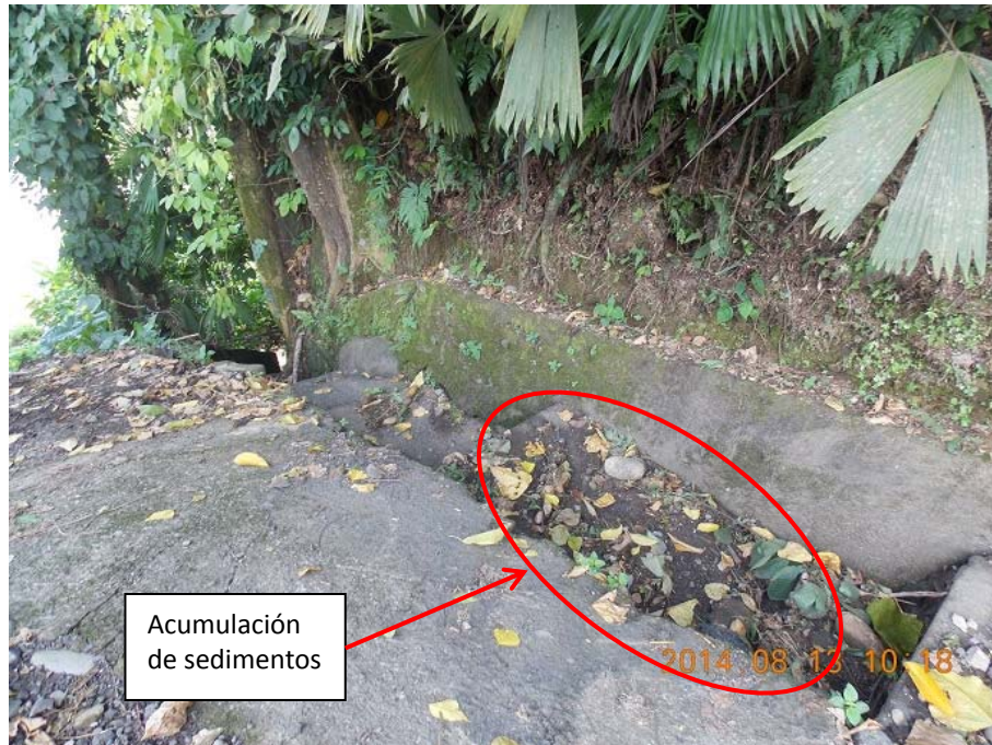
Figura 10: Cuneta del costado norte del acceso este.
