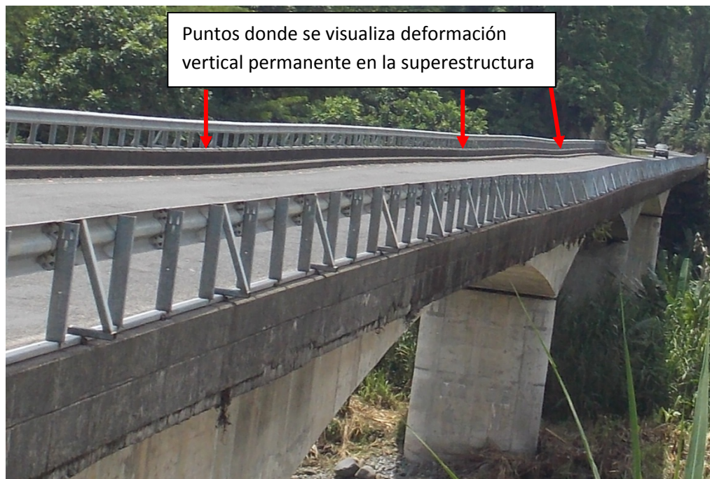
Figura 13: Deformación permanente visible en la superestructura del puente.
