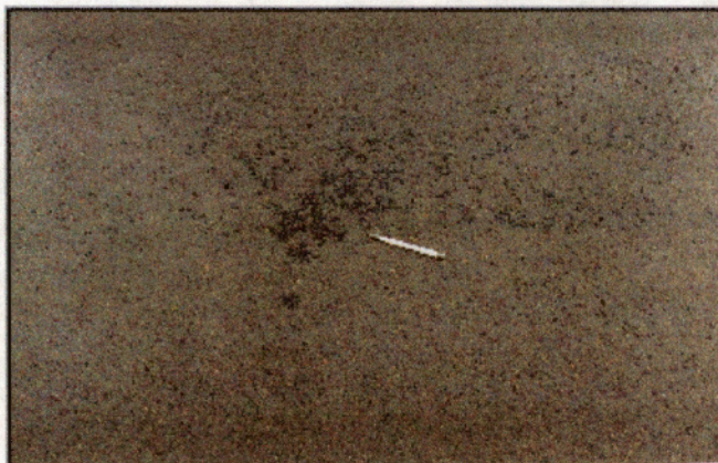
Fotografía 3: Humedad presente en sobrecapa por mezcla abierta.
