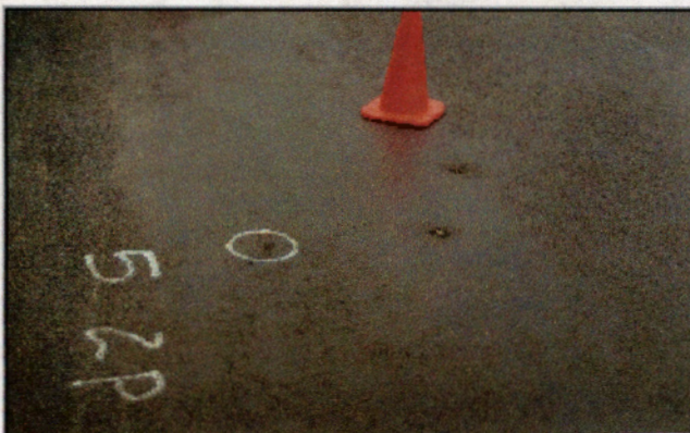
Fotografía 3: Exudación severa presente en la sobre-capa
