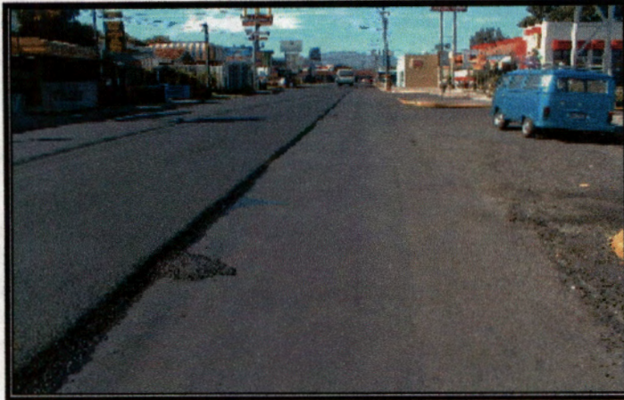
Fotografía 1: Trabajos inconclusos en las cercanías de Novacentro
