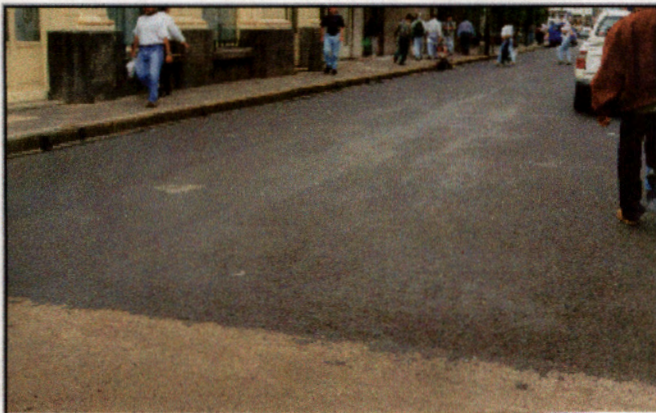
Fotografía 1: Exudación de moderada a severa, con problemas de acabado superficial.
