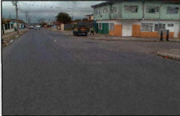
Fotografía 1: Trabajos inconclusos de sobrecapa.
