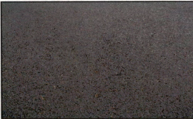
Fotografía 1: Detalle de acabado superficial de sobre-capa.
