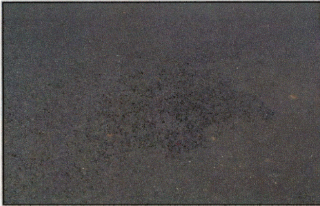
Fotografía 10: Presencia de afloramiento de humedad en varios puntos de la sobre capa.
