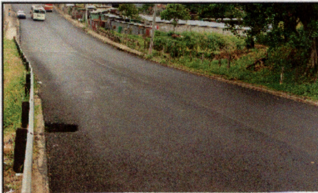
Fotografía 5: Vista general de exudación en ambos carriles.
