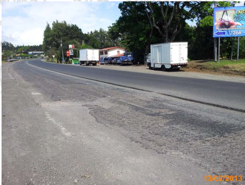
Fotografía 2. Deterioros en perfilado expuesto por más de 24 horas. Fecha: 13 de febrero del 2013. Fuente: Unidad de Auditoría Técnica, LanammeUCR.
