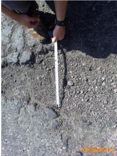
Fotografía 3. Anchos variables de deterioros. Fecha: 13 de febrero del 2013.
