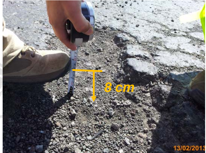
Fotografía 4. Profundidad promedio de deterioros. Fecha: 13 de febrero del 2013.
