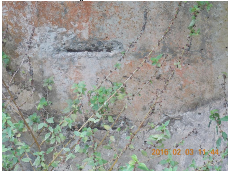
Figura 11. Detalle de desprendimientos y acero de refuerzo expuesto y corroído en viga principal externa del costado aguas arriba, cerca del bastión 2.
