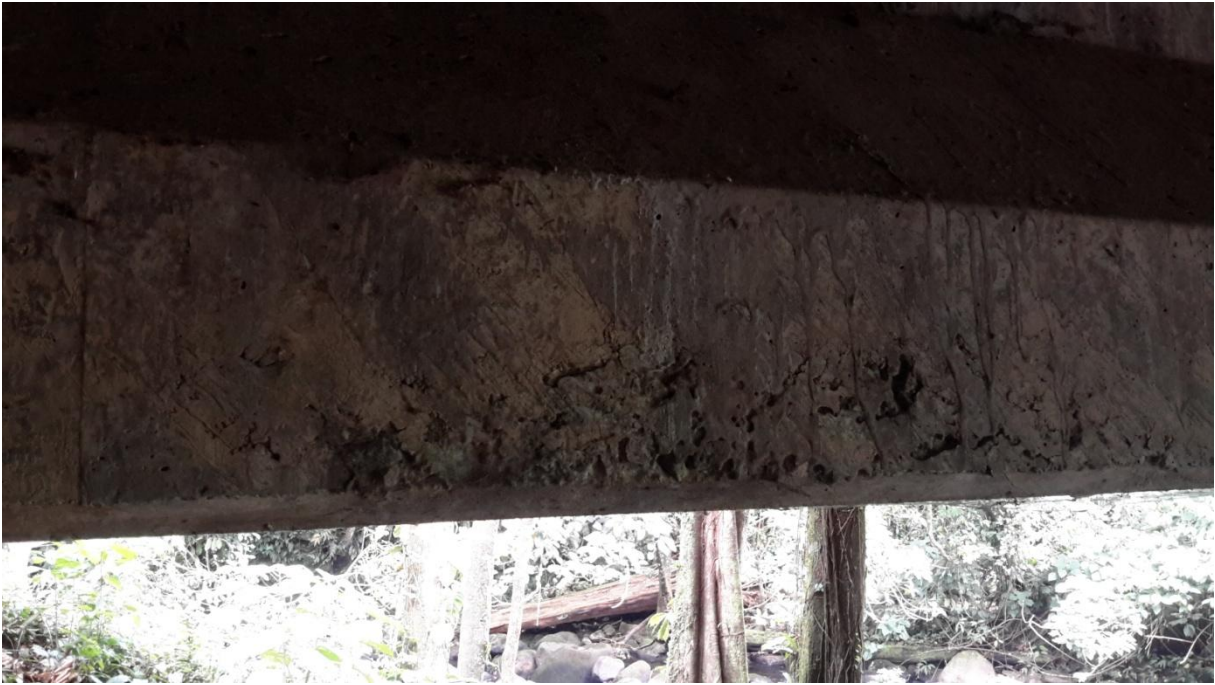
Figura 12. .Nidos de piedra en la cara inferior de las vigas principales de concreto.
