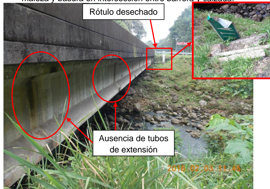
Figura 6. Ausencia de tubos de extensión en sistema de drenaje del puente y rótulo de identificación desechado en talud de relleno de aproximación. Nótese la evidencia de manchas de humedad sobre las vigas.
