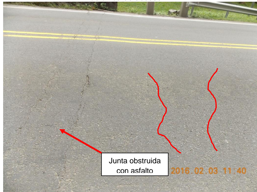
Figura 8. Junta de expansión sobre bastión 2 cubierta por asfalto y agrietamiento de la carpeta asfáltica del acceso 2.
