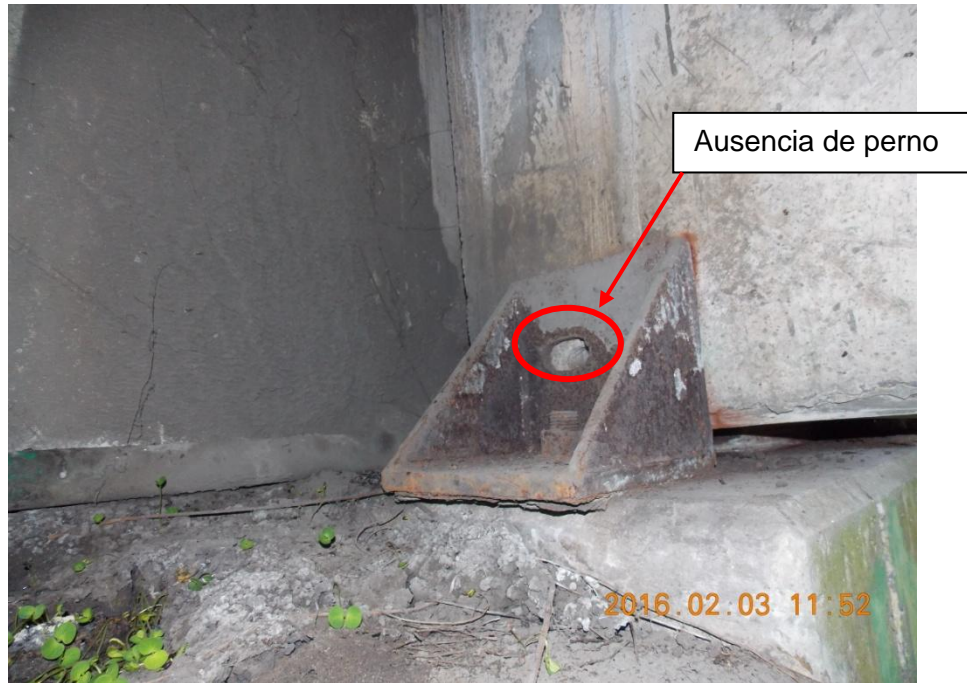
Figura 14. . Elemento de acero del sistema de apoyo con corrosión y pérdida de pernos.
