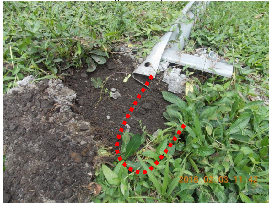
Figura 2. Ausencia de anclaje de guardavía al terreno
