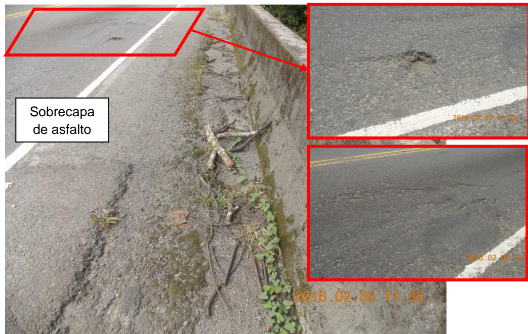
Figura 5. Sobrecapa de asfalto sobre el puente con ondulaciones y baches, sedimentos, maleza y basura en intersección entre barrera y calzada.
