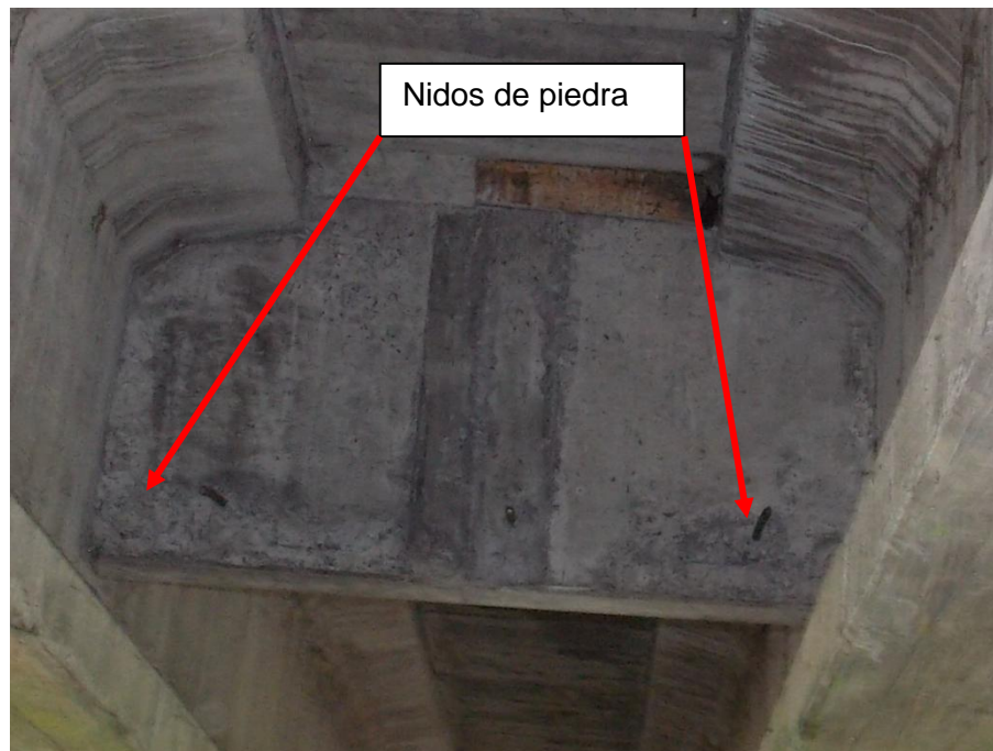
Figura 13. .Nidos de piedra en vigas diafragma.
