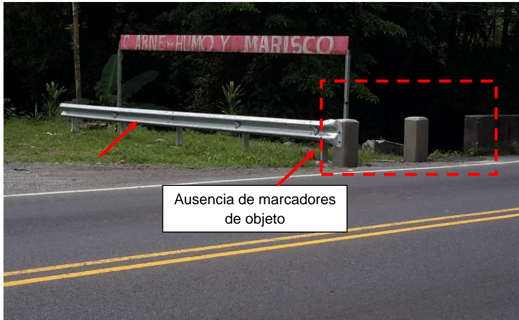
Figura 3. Guardavías colocado de forma perpendicular a la dirección del tránsito y ausencia de marcadores de objeto.
