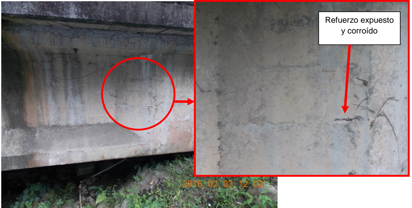
Figura 10. Grietas y acero de refuerzo expuesto y corroído en viga principal externa del costado aguas arriba, cerca del bastión 1.
