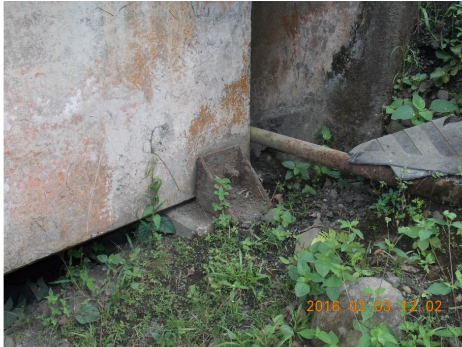
Figura 16. Apoyo en contacto con maleza y suelo del relleno de aproximación.
