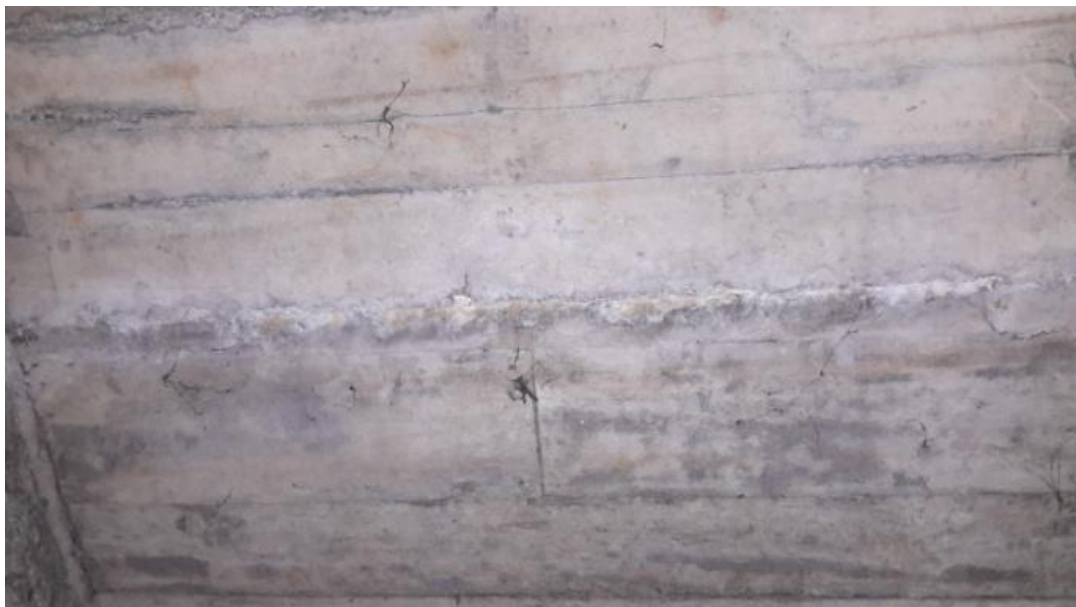
Figura 9. Eflorescencias en la cara inferior del tablero a lo largo de las grietas observadas y en la intersección de superficies de concreto entre las vigas y la losa.
