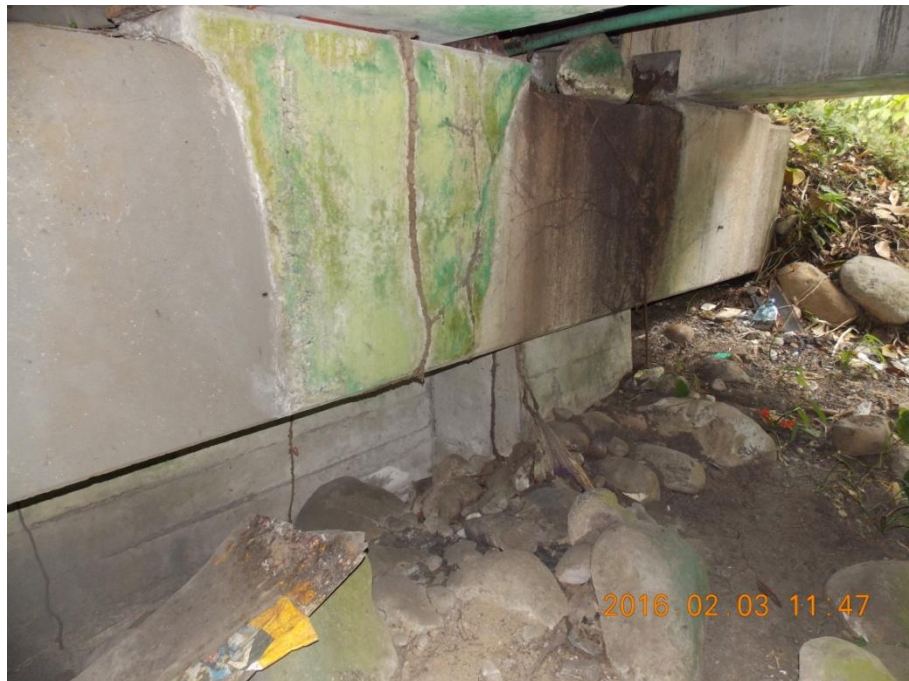
Figura 17. Manchas de humedad producto del ingreso de agua a través de las juntas.
