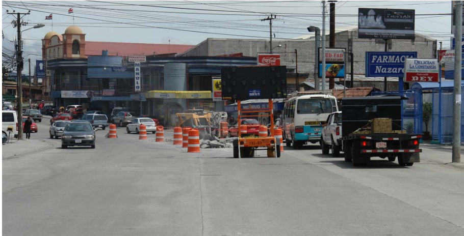
Fotografía 4. Señalización al inicio de la zona de trabajo. No se observa área de transición y amortiguamiento. Proyecto Zapote – San Francisco. Fecha de visita 30/09/09
