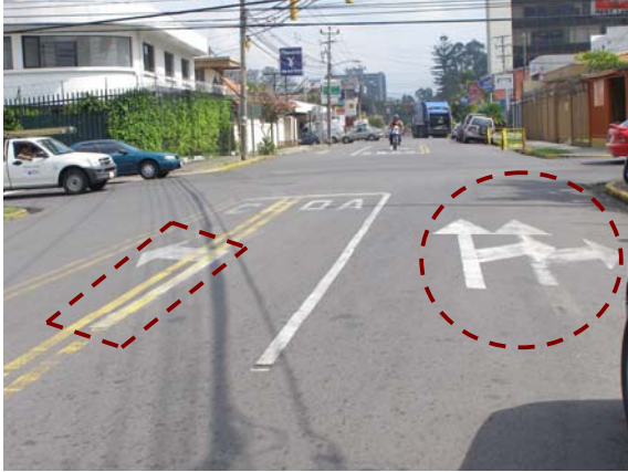
Fotografía 5. Demarcación horizontal. Proyecto Universal – La Salle, Calle Morenos acceso sur. Fecha de visita 16/10/09
