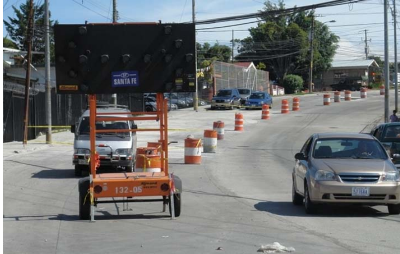
Fotografía 2. Zona de Control Temporal de Tránsito, no se observa área de finalización ni canalización. Estaciones de señalización con separación variable. Proyecto Zapote – San Francisco. Fecha de visita 16/10/09
