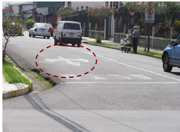
Fotografía 8. Señalamiento vial confuso. Proyecto Universal – La Salle. Calle Morenos acceso este. Fecha de visita 16/10/09
