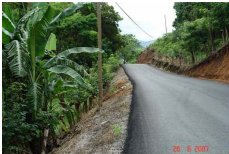
Fotografía N° 12: Taludes de más de 4m de altura, que no cuentan con protección lateral en caso de accidentes.
