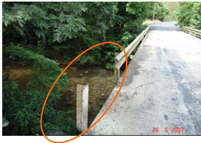
Fotografía N° 11: Puente angosto con baranda deteriorada sin advertencia de reducción en la cantidad de carriles
