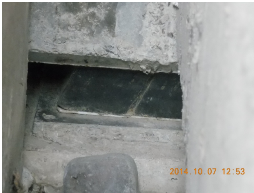
Figura 15: Almohadilla de neopreno deformada en asiento de viga en pila.
