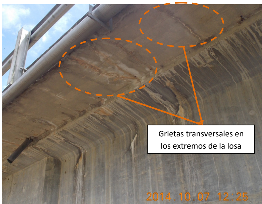
Figura 10: Eflorescencia y agrietamiento transversal en extremo de losas.
