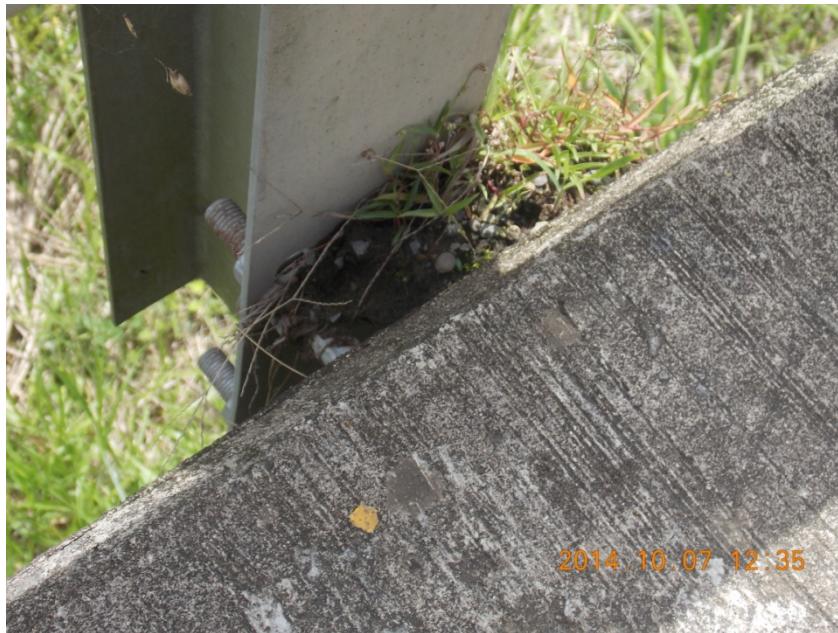
Figura 1: Detalle de conexión en barrera vehicular, falta de mantenimiento evidente.
