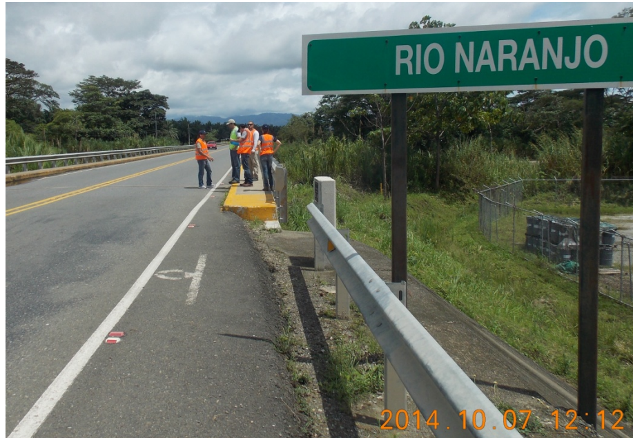
Figura 3: Rotulación del puente y ausencia de delineadores verticales.
