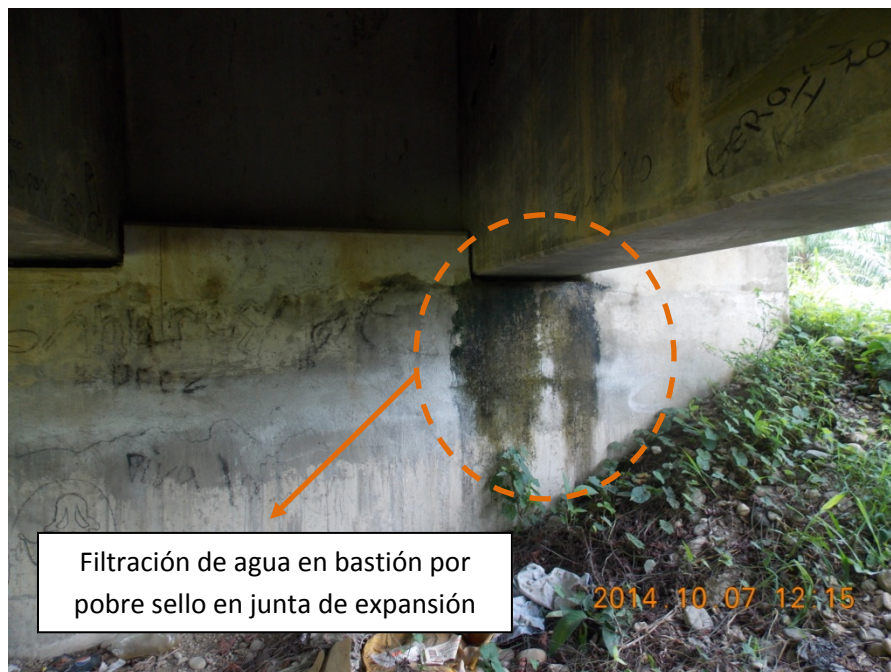
Figura 13: Filtraciones de agua en bastión.
