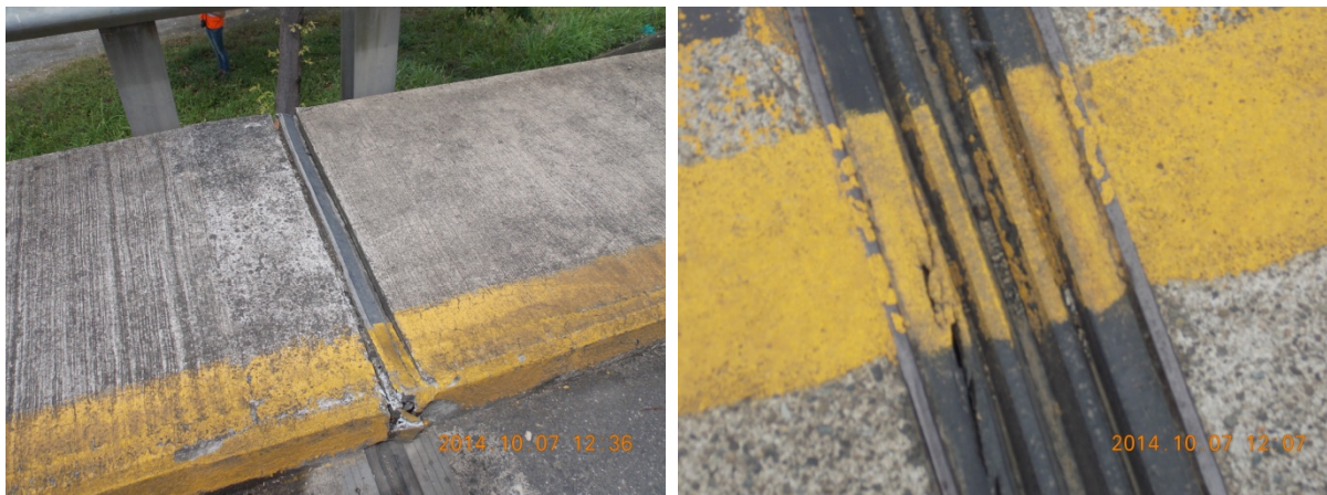
Figura 7: Detalle de junta de expansión agrietada y daños en junta de la acera.
