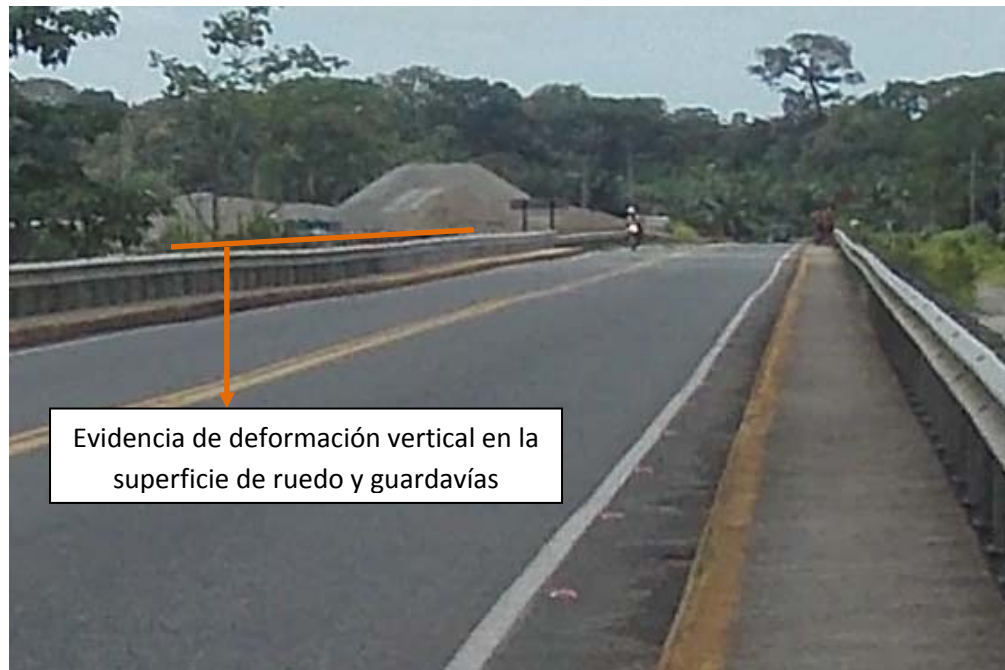
Figura 11: Evidencia de deformación vertical.
