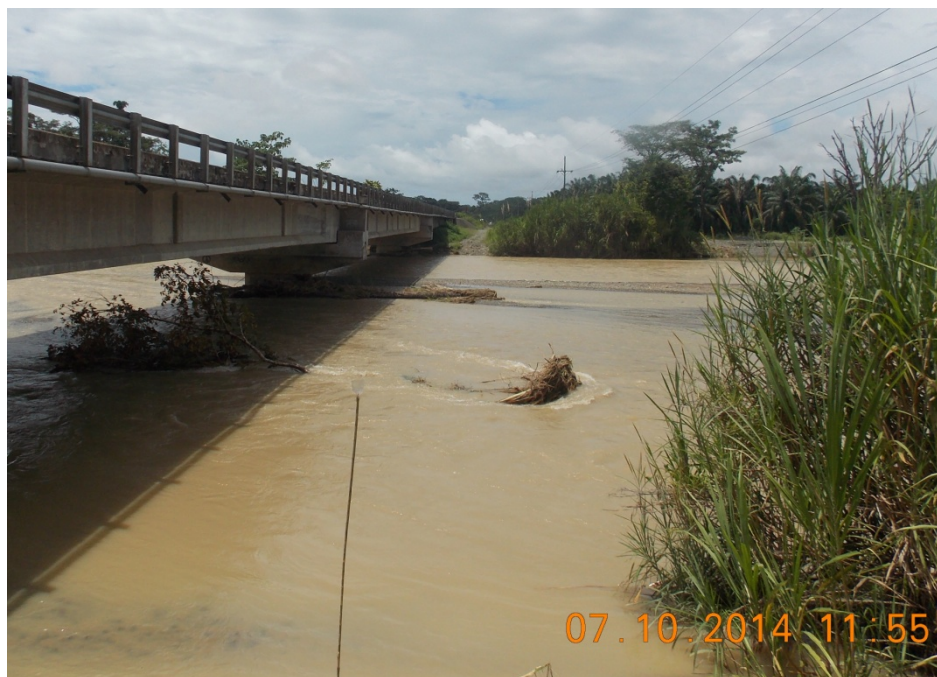
Figura 8: Presencia de escombros y acumulación de sedimentos en sectores del cauce.
