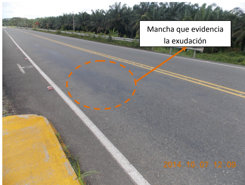
Figura 5: Exudación leve en la capa asfáltica.
